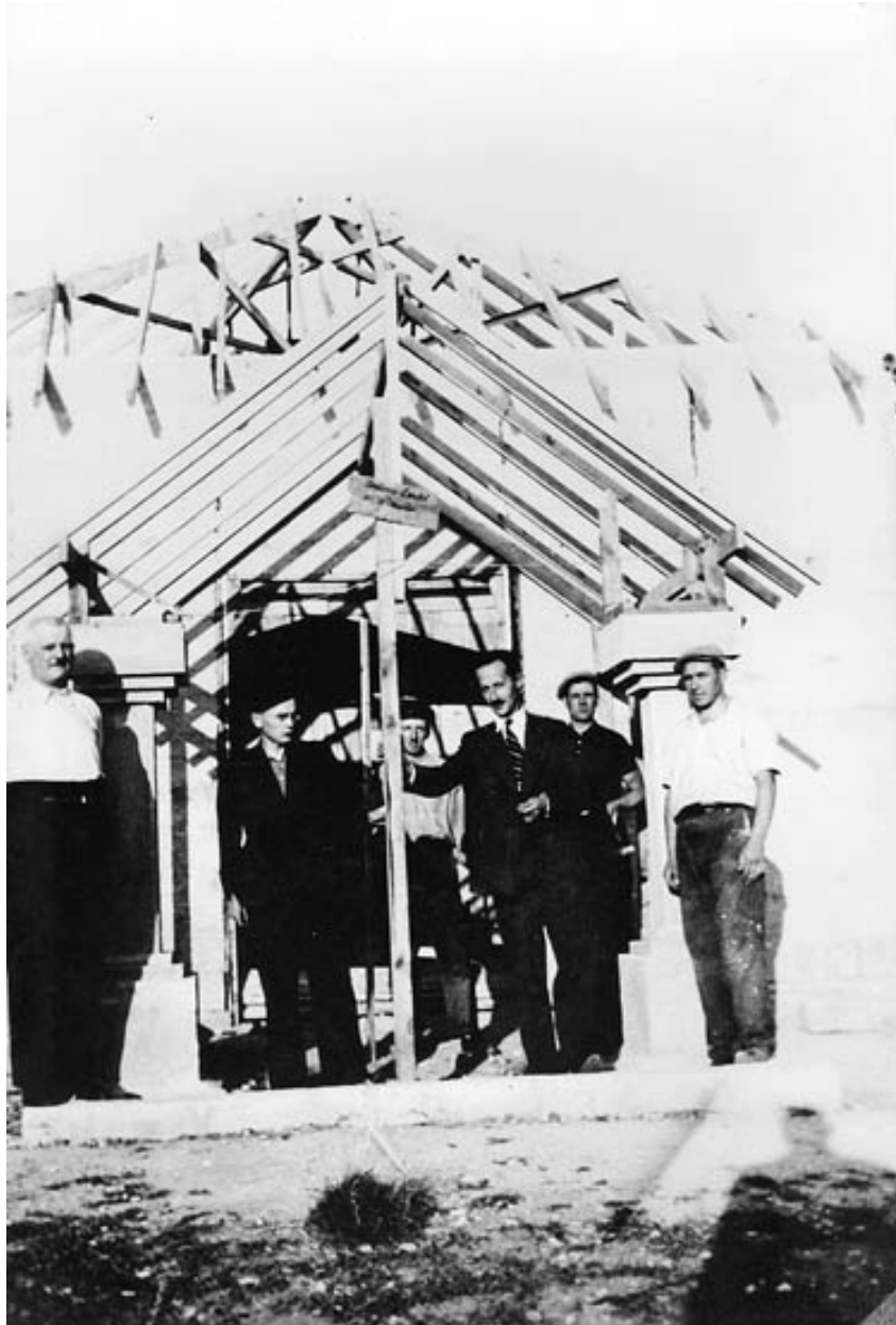
Photo ancienne. Construction de l'église orthodoxe en 1937-1938 sur les plans de J.Papandopoulos, ingénieur de la société PIC de Fontainebleau.
