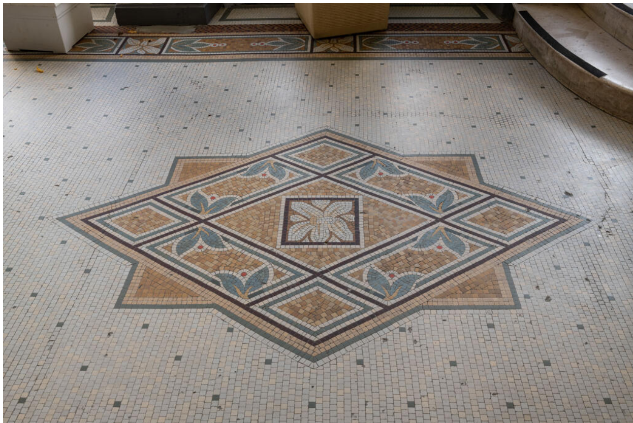
Palier du premier étage, détail du décor central du sol en mosaïque.
