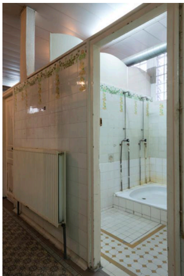
Une cabine pour femmes. Elle accueillait autrefois l'une des quatre baignoires de l'établissement, qui a été transformée en douche double.
