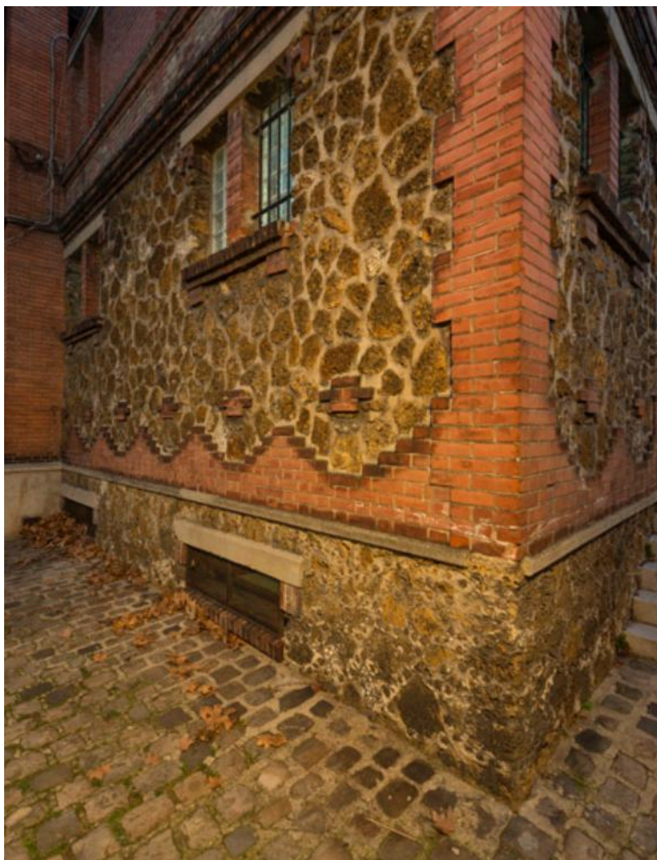
Détail du soubassement en pierre meulière et des chaînages d'angle en brique rouge.
