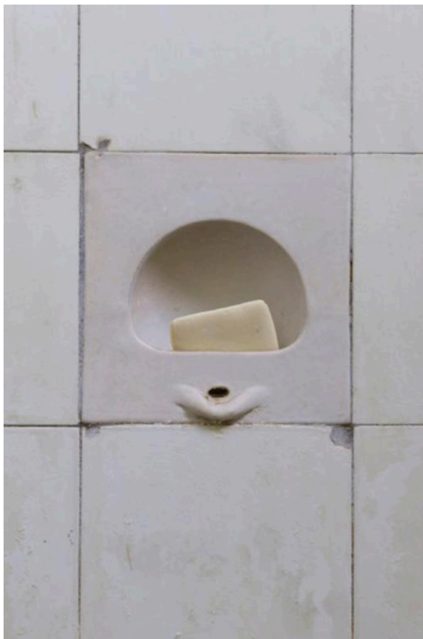
Niche porte-savon, dans l'une des cabines de bain-douche.
