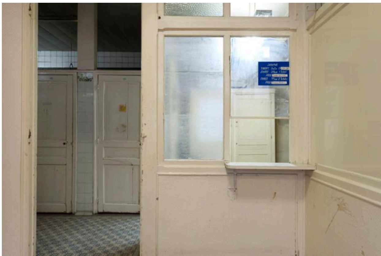
Détail du guichet de la caisse. Au gauche, l'entrée dans l'aile de cabines des hommes.
