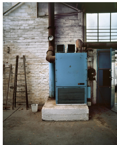
Chaudière installée après la fermeture de la fonderie et sa reconversion temporaire en imprimerie. Sur le socle reposait la petite étuve pour la préparation des noyaux des moules. A gauche était installée l'établi de préparation des noyaux. IVR11_20059300166XA
