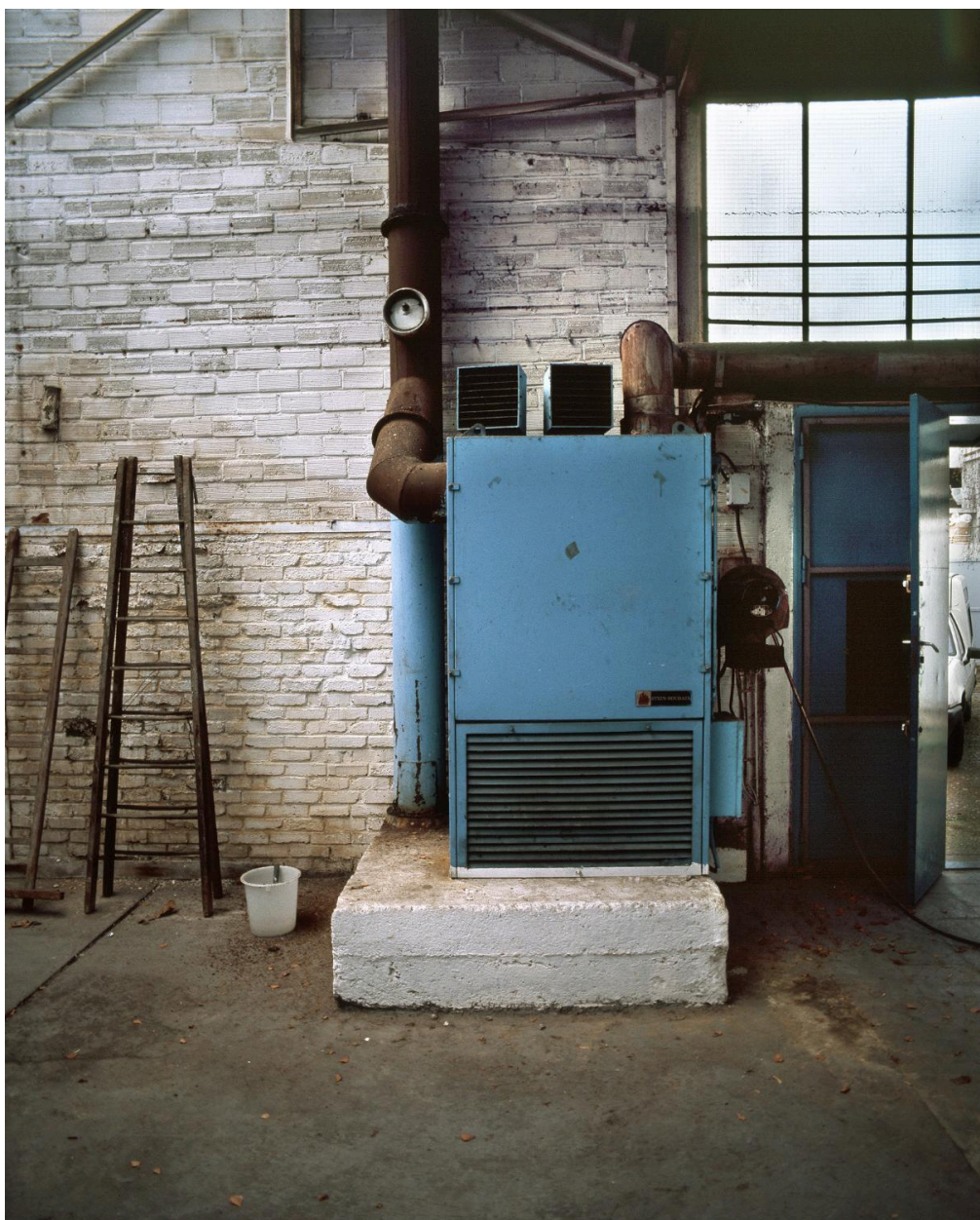
Chaudière installée après la fermeture de la fonderie et sa reconversion temporaire en imprimerie. Sur le socle reposait la petite étuve pour la préparation des noyaux des moules. A gauche était installée l'établi de préparation des noyaux.
