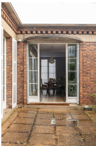
L'entrée. Au premier plan un vestibule nommé "salle de jeux" sur les plans. Au fond, le séjour. IVR11_20249200009NUC4A
