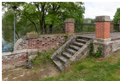
Détail de l'escalier d'accès à la terrasse et de son garde-corps en fer forgé. Phot. Kruszyk Laurent IVR11_20247800235NUC4A
