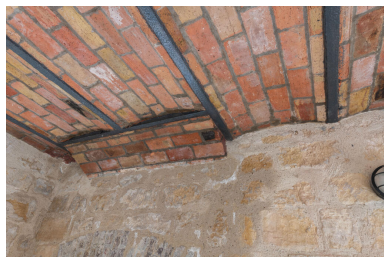
Voûtains de couverture dans la remise aux bateaux. Phot. Kruszyk Laurent IVR11_20247800264NUC4A
