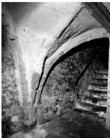
La cave médiévale : vue de l'escalier d'accès et de la retombée des ogives dans le mur ouest. Phot. Stéphane Asseline IVR11_20047700027X
