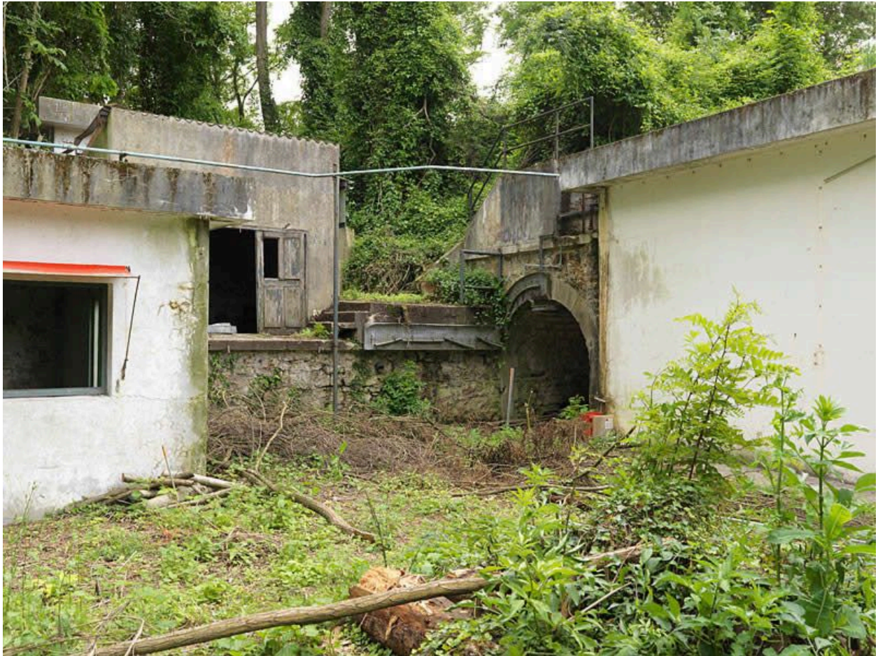
Vue des locaux techniques du CEA adossés à la partie extérieure de la batterie sud du fort.
