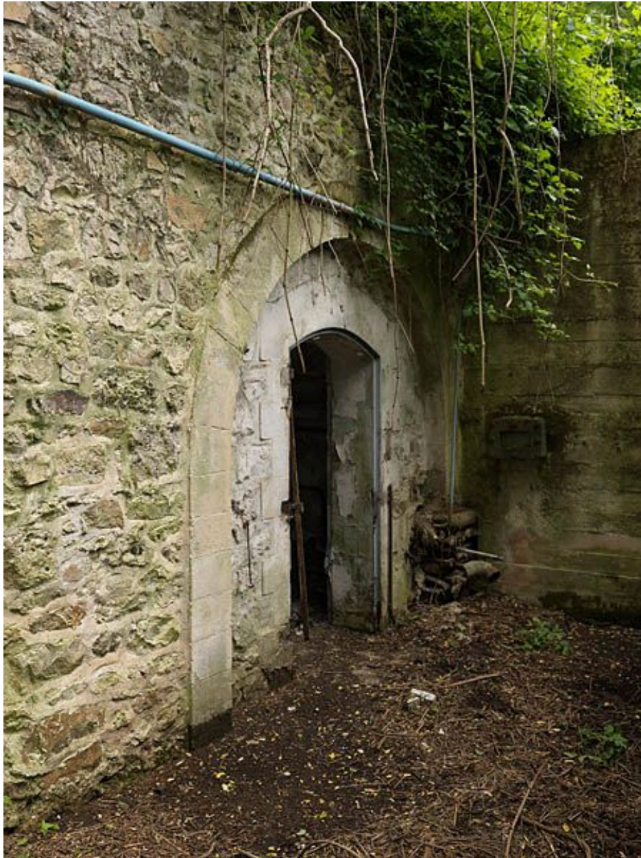
Vue de détail de la batterie sud (partie extérieure modifiée par le CEA pour ses essais).
