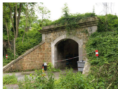
Vue du passage sous voûte de la batterie sud, de l'extérieur vers l'intérieur, cette fois en direction du fort (du nord vers le sud). Phot. Stéphane Asseline IVR11_20129300024NUC4A
