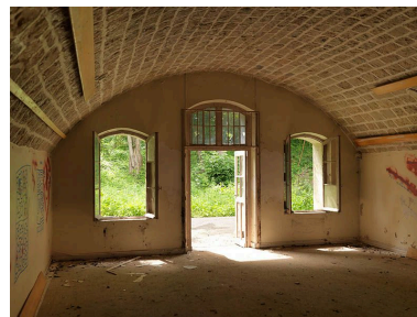
Vue intérieure d'une casemate de la batterie sud. Phot. Stéphane Asseline IVR11_20129300018NUC4A
