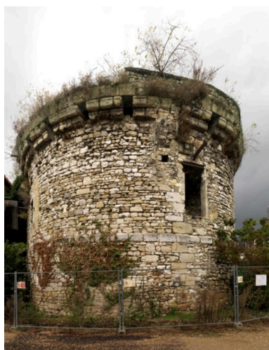
Vue de la tour Saint-Martin depuis la rue des Martraits. Phot. Laurent Kruszyk IVR11_20167800683NUC4A
