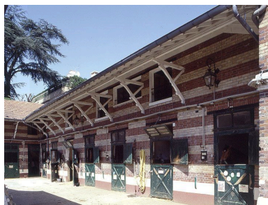
Cercle hippique du bois de Vincennes, , 8 rue de Fontenay. Vue des écuries. Phot. Stéphane Asseline IVR11_20049400122XA
