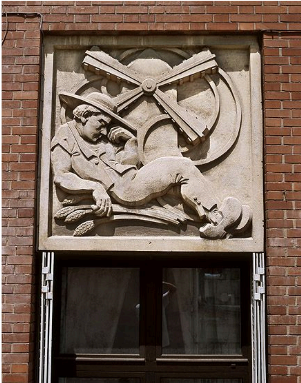
Ecole primaire, puis collège Edouard-Branly, 5 rue de la Muette. Détail du bas-relief de Maurice Saulo illustrant la comptine ""Meunier tu dors"".
