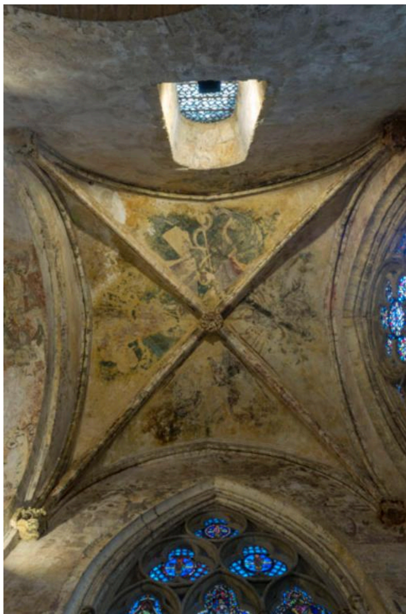
Vue d'ensemble de la voûte du bras sud du transept et de ses peintures.
