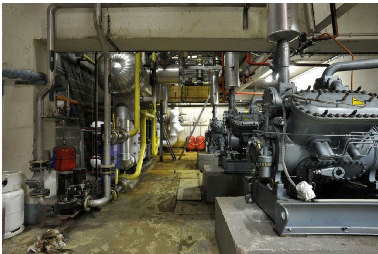
Vue des locaux techniques pour la fabrication de la glace : détail des machines
