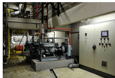
Vue des locaux techniques pour la fabrication de la glace Phot. Laurent Kruszyk IVR11_20129500265NUC4A
