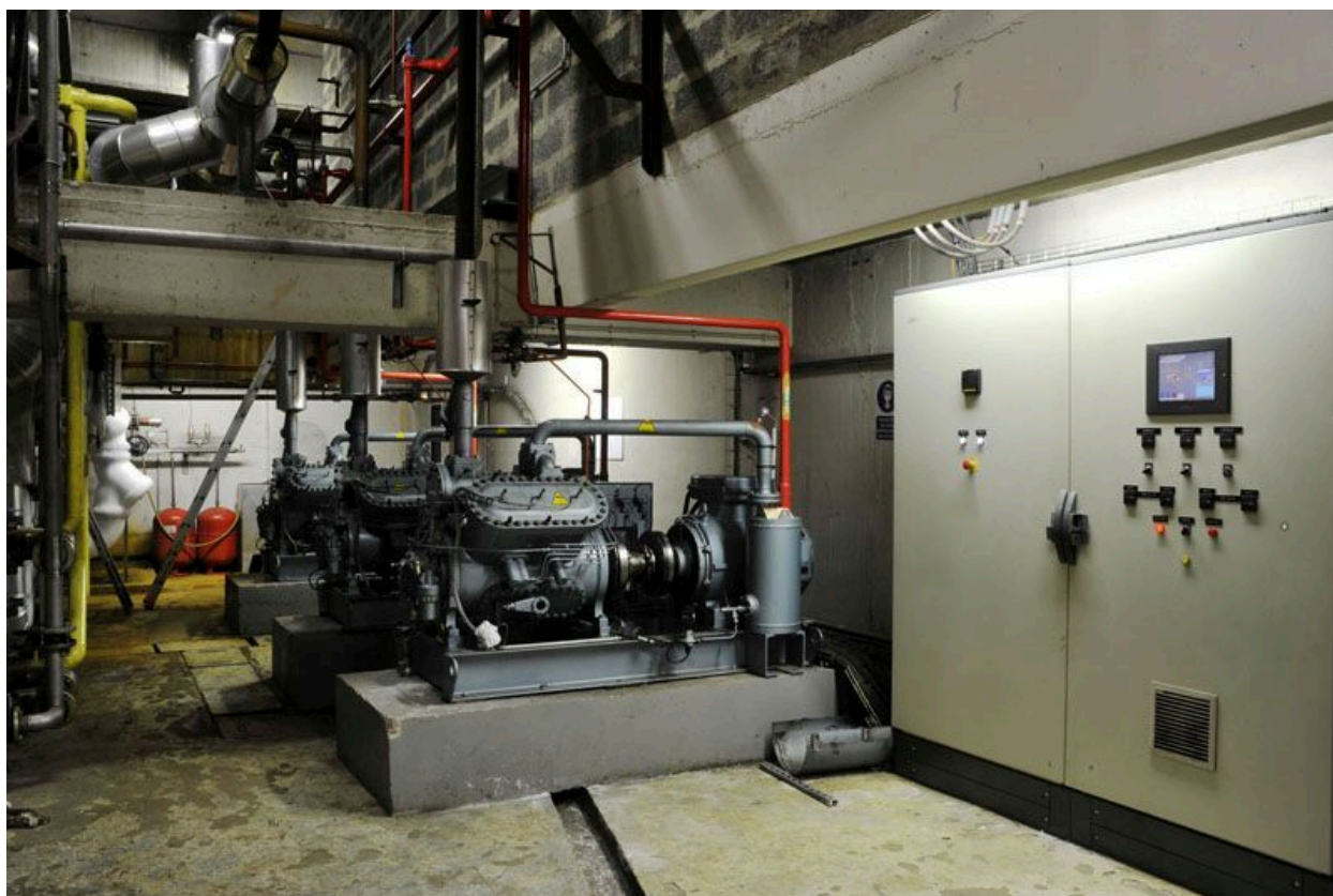
Vue des locaux techniques pour la fabrication de la glace
