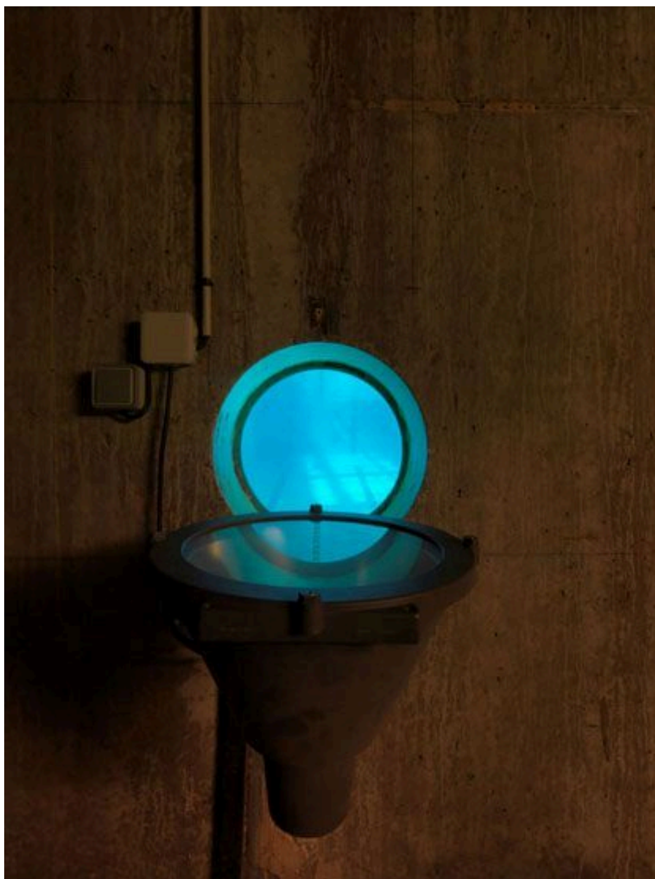
Piscine : détail d'un espace technique en sous-sol, couloir de circulation autour du bassin avec l'un des oculi donnant vers l'eau.
