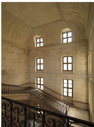
Le pavillon abritant l'escalier J est largement éclairé. Phot. Laurent Kruszyk IVR11_20107500201NUC4A
