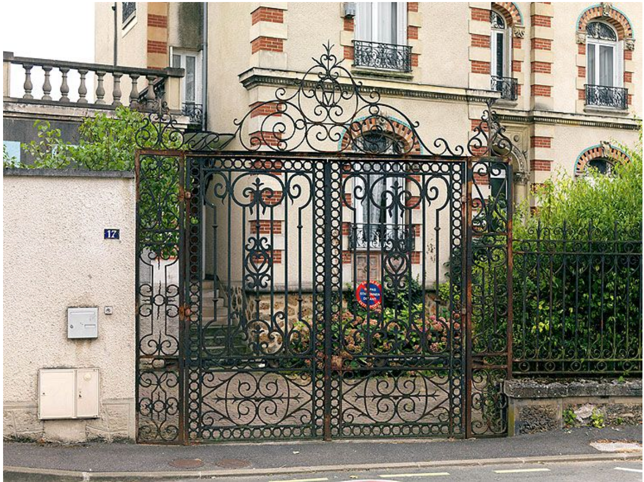
La grille d'entrée.
