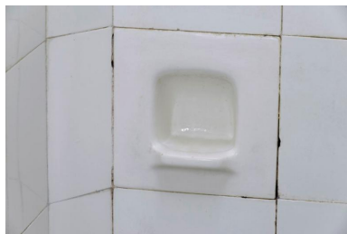
Porte-savon et revêtement en carreaux de faïence blanche, dans une douche.
