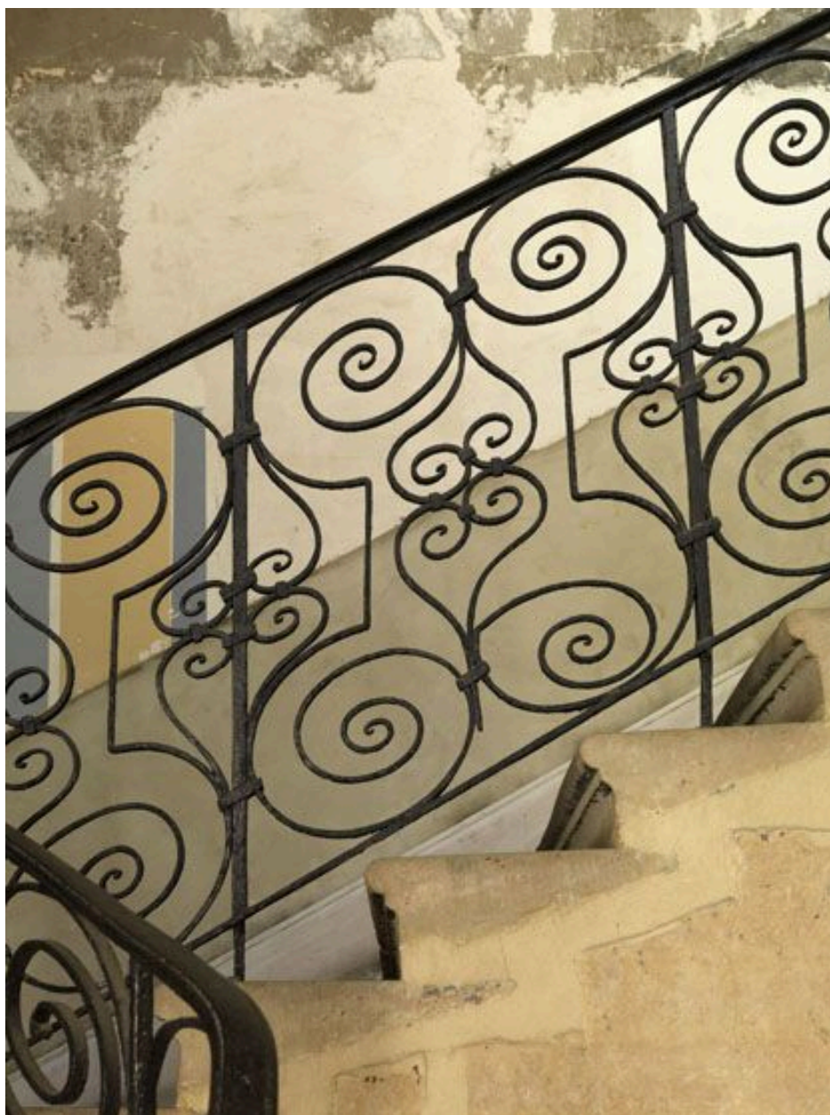
Détail des barreaux montants s'enfonçant dans les girons des marches.
