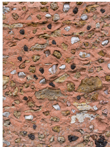
Maison d'Octave Allaire, rocaillage d'un mur. Le mortier coloré est incrusté de fragments de silex, de meulière et de mâchefer. Phot. Asseline Stéphane IVR11_20257800206NUC4A
