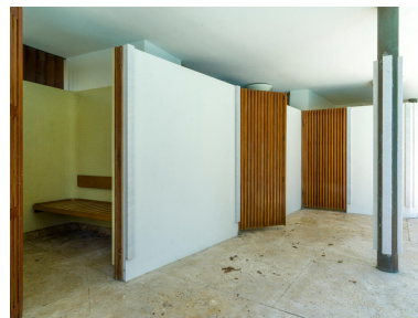
Vestiaires et sanitaires sont fermés par des clairevoies. Phot. Asseline Stéphane IVR11_20247800344NUC4A
