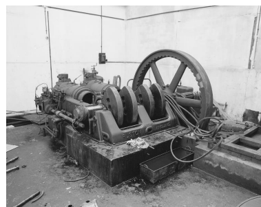
moteur Ruston des générateurs de la centrale électrique, vers 1988. Photographie. (AD Seine-Saint-Denis. A NB 118) IVR11_20029300119NUC
