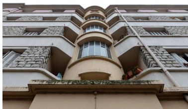
Vue en contre-plongée d'une cage d'escalier depuis la cour. Phot. Laurent Kruszyk IVR11_20177800118NUC4A
