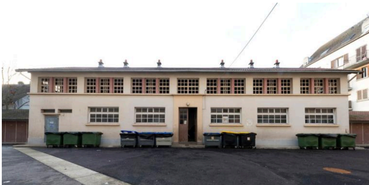
Vue d'ensemble de l'annexe au fond de la cour. Elle abrite encore buanderie et séchoirs collectifs.
