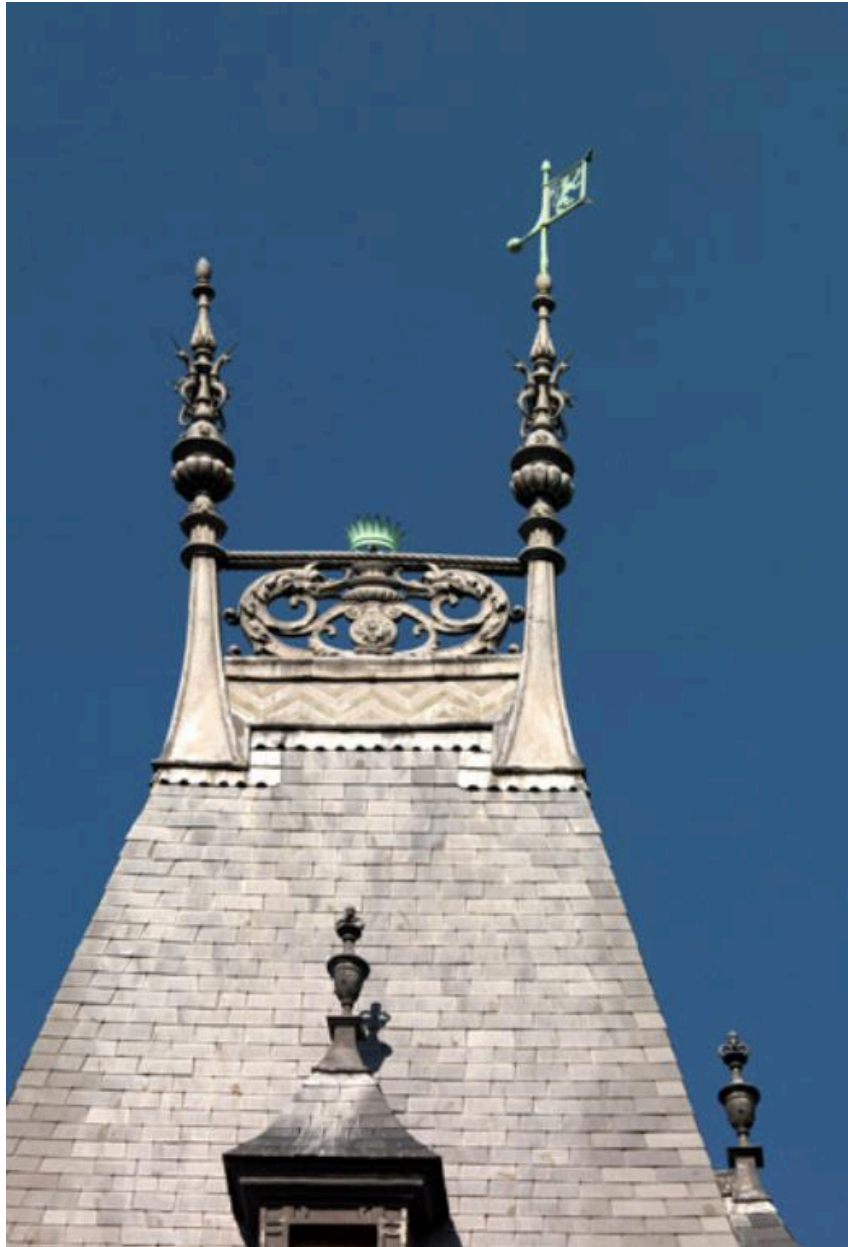
La crête du toit en pavillon de la partie reconstruite pour Sée.
