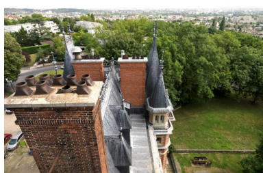
Vue depuis le belvédère au dessus des toits de la partie reconstruite par les Dino. Phot. Laurent Kruszyk IVR11_20179500392NUC4A
