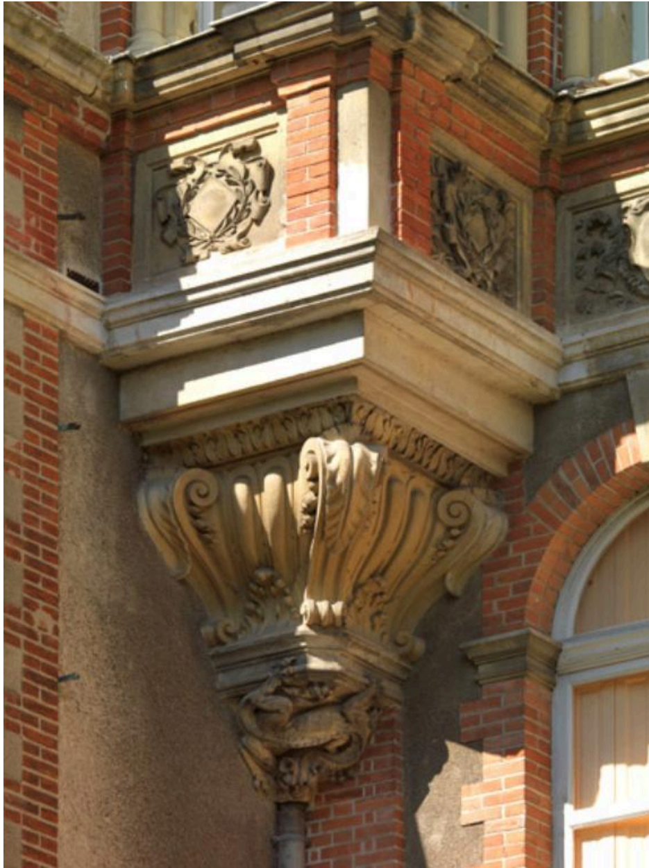
Console soutenant le cabinet en saillie. Elle est ornée de la salamandre de François 1er.
