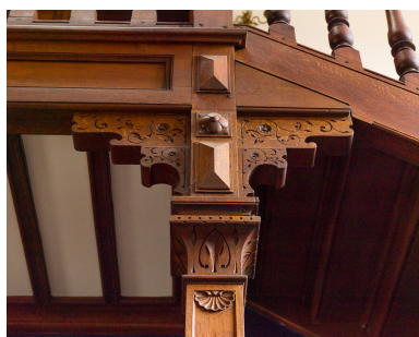
Assemblage de colonne de la coursive, au rez-de-chaussée. Phot. Asseline Stéphane IVR11_20249500032NUC4A
