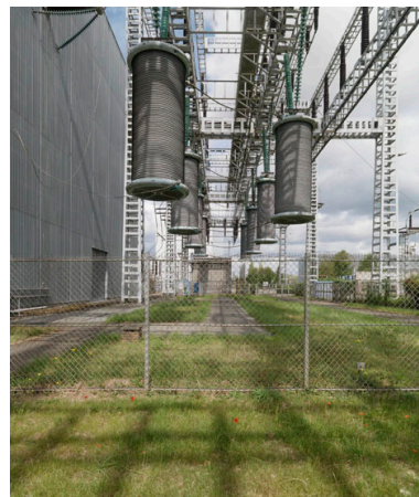
Charpente électrique extérieure. Détail. A gauche le Hall d'essais synthétiques. Phot. Philippe Ayrault IVR11_20117700871NUC4A
