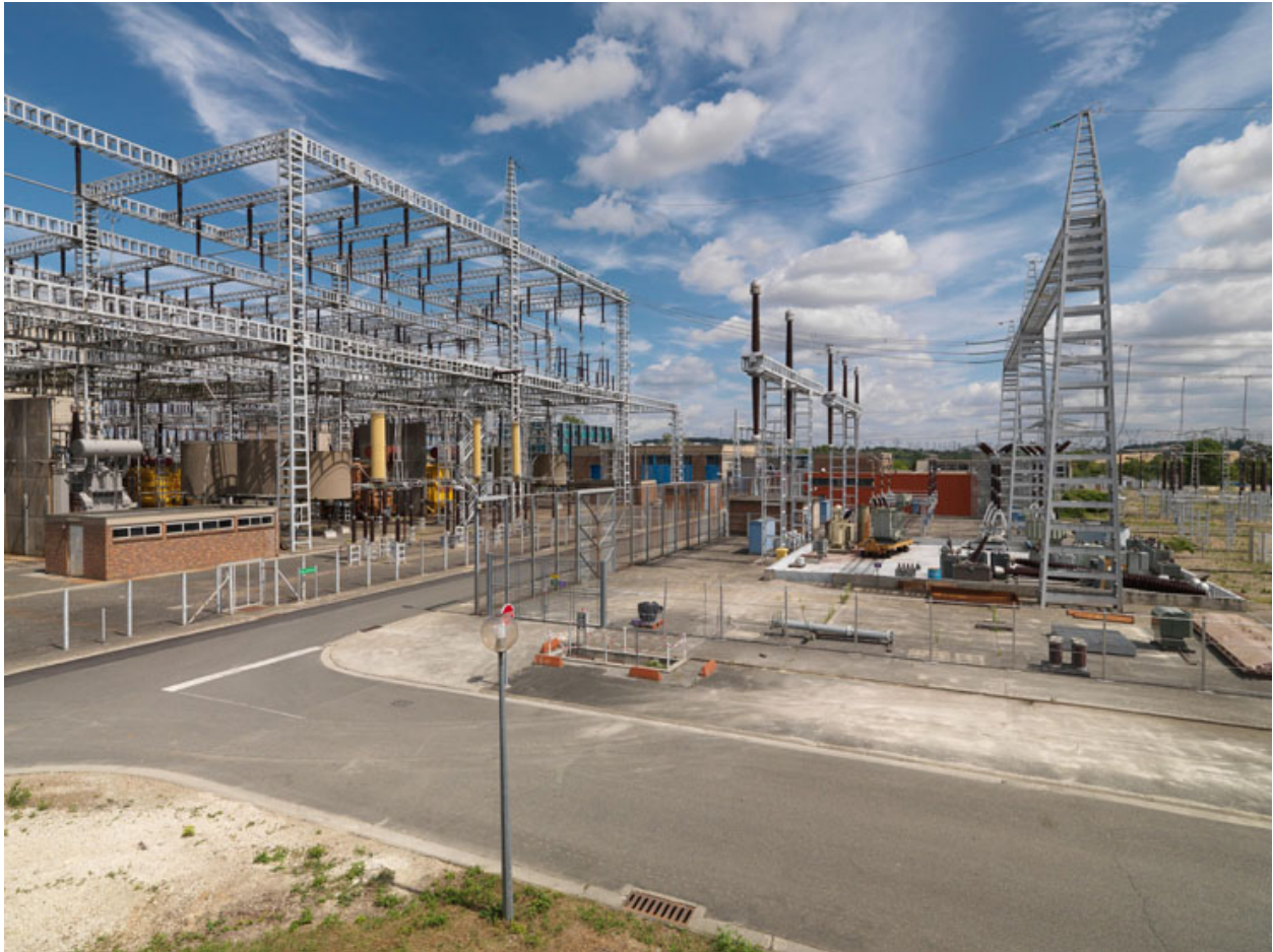
Charpente électrique extérieure.
