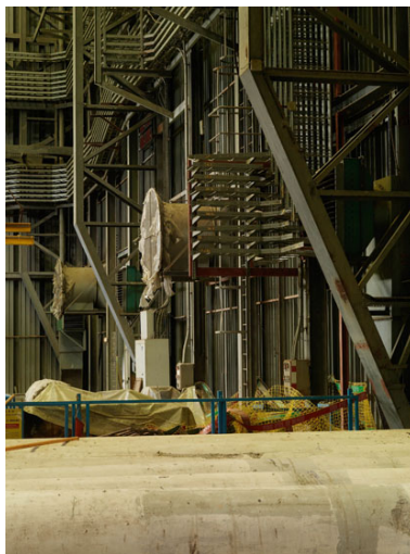
Intérieur du Hall CGVS (Circuit d'essais de Générateurs de Vapeur chauffés au Sodium). Phot. Philippe Ayrault IVR11_20117700822NUC4A
