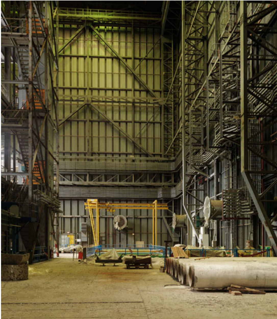
Intérieur du Hall CGVS (Circuit d'essais de Générateurs de Vapeur chauffés au Sodium).
