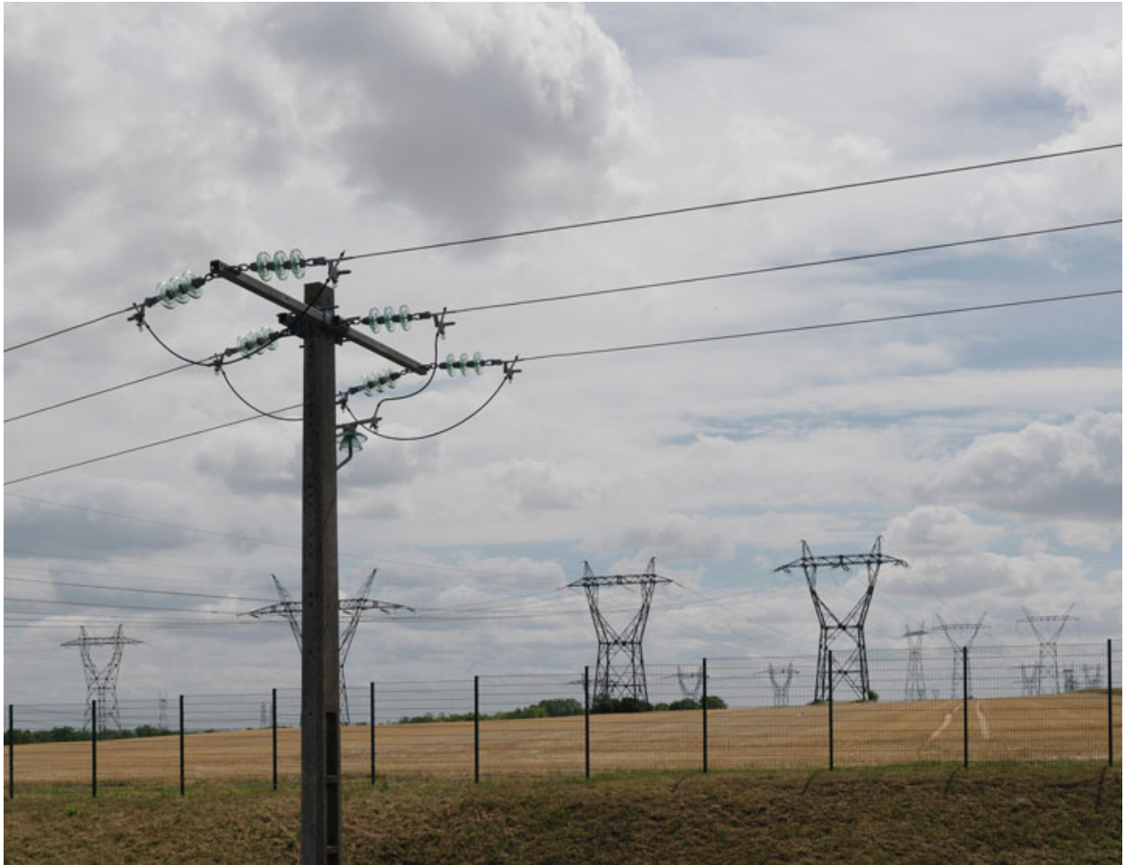
Arrivée de la Très haute tension sur le site des Renardières. Vue des abords.
