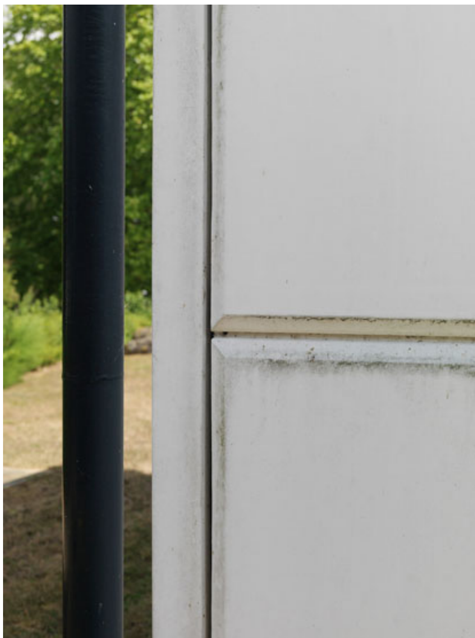
Laboratoire d'essais classique blanc de type Prouvé. Détail d'un angle. Assemblage de deux panneaux et sur la structure. Gouttière noire.
