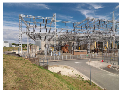
Charpente électrique extérieure. En arrière-plan a gauche, le département CIMA (Câbles, condensateurs, Isolants, Matériels d'Automatisme). Phot. Philippe Ayrault IVR11_20117700877NUC4A
