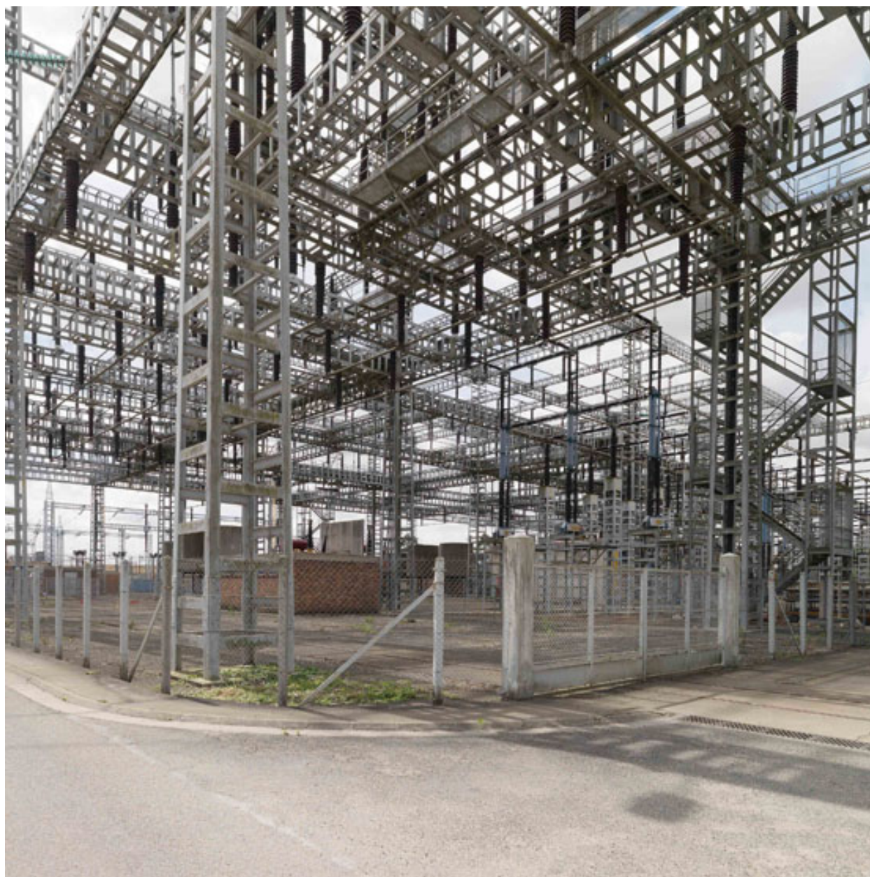
Charpente électrique extérieure.
