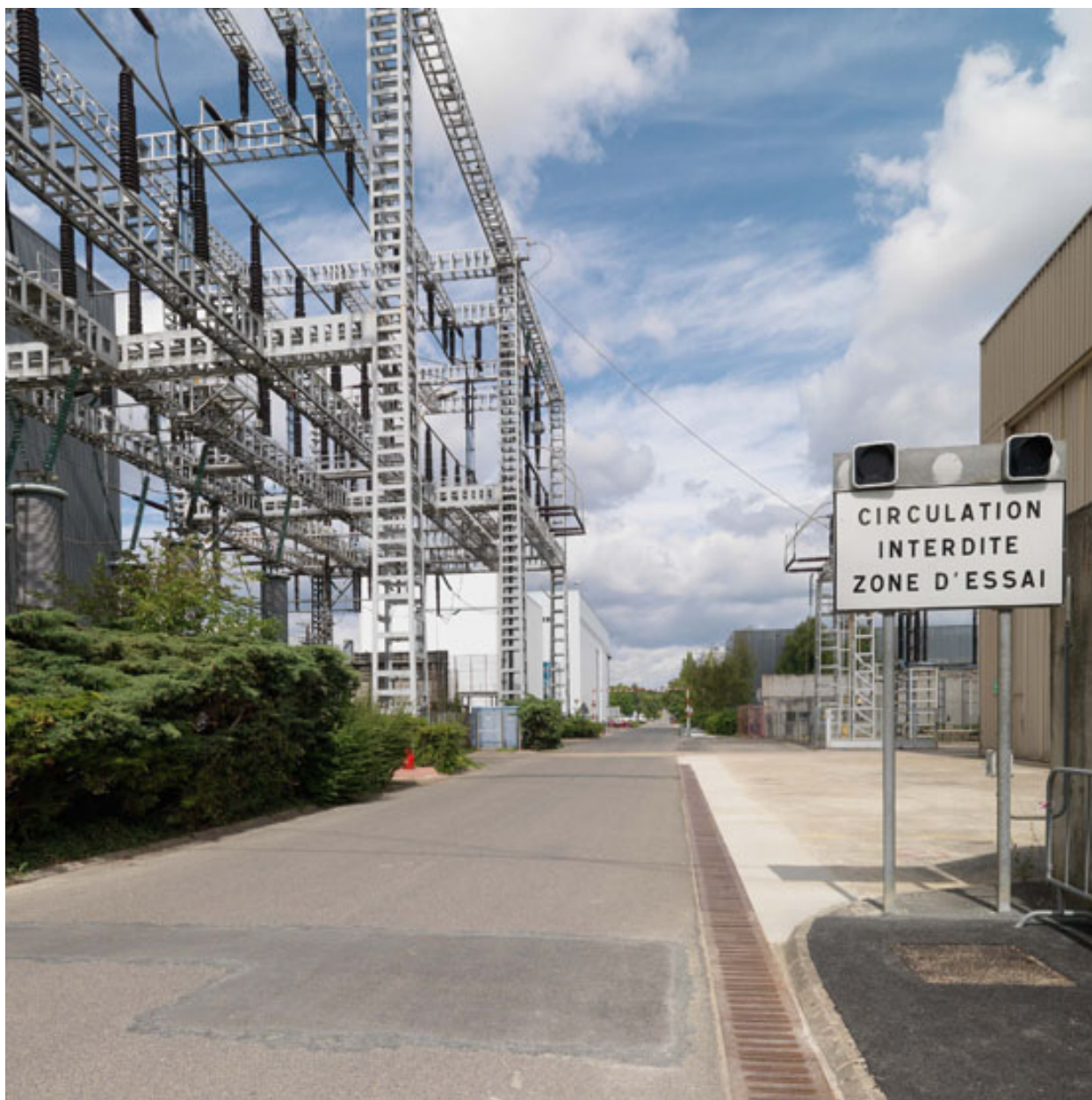
Charpente électrique extérieure. En arrière-plan le LEHT (Laboratoire d'essais haute tension). A droite le laboratoire LGEP (Laboratoire d'essais grande puissance).
