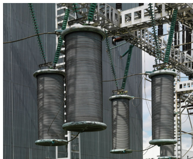
Charpente électrique extérieure. Détail. En arrière-plan, le Hall d'essais synthétiques. Phot. Philippe Ayrault IVR11_20117700872NUC4A
