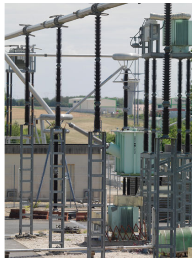
Installations électriques expérimentales. Phot. Philippe Ayrault IVR11_20117700802NUC4A
