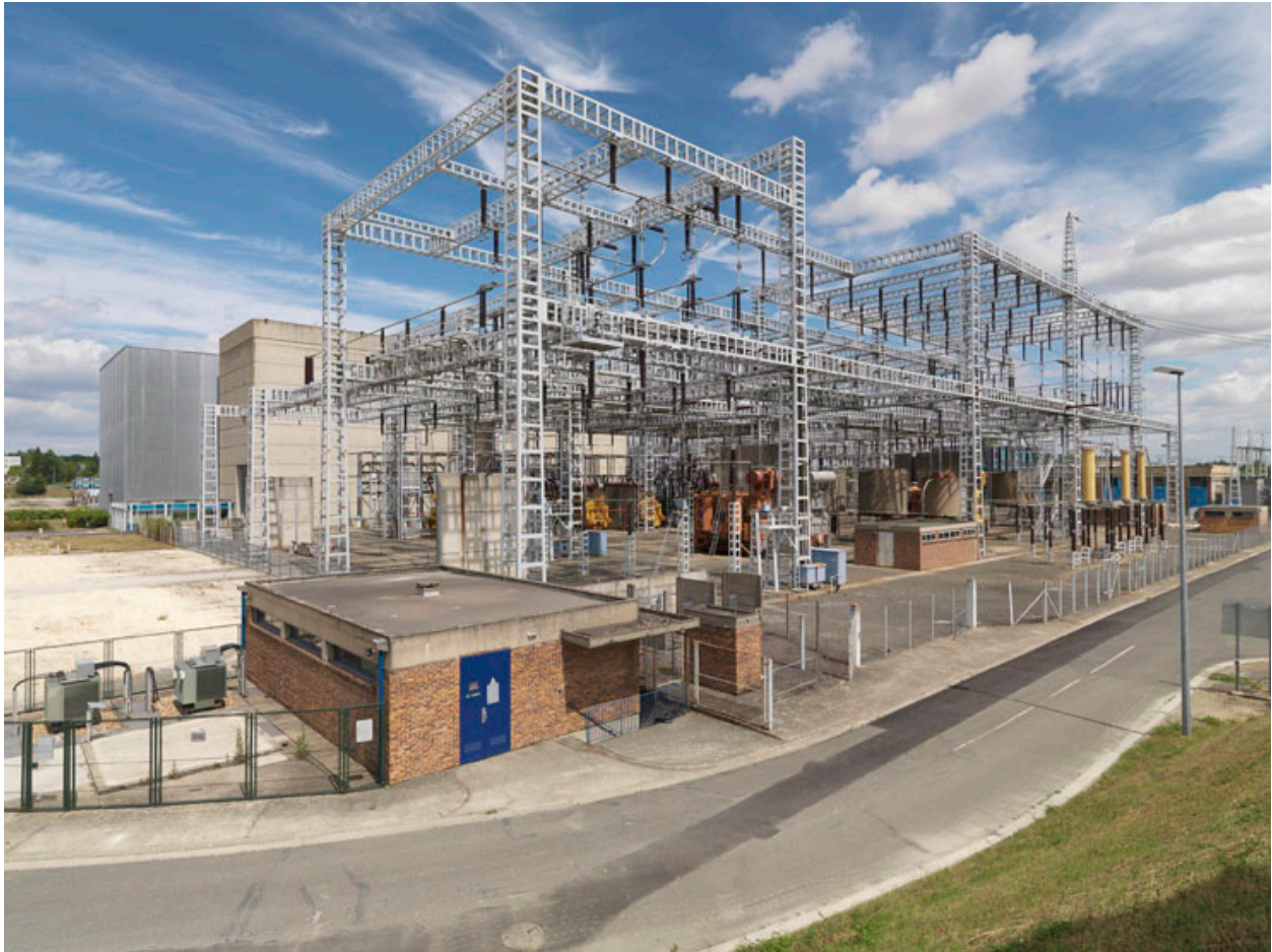
Charpente électrique extérieure. En arrière-plan à gauche le Hall STGP (Station d'essais grande puissance), le Hall d'essais synthétiques et un module de bureaux bleu.
