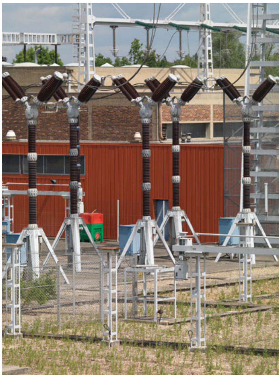
Poste de transformation. Détail.
