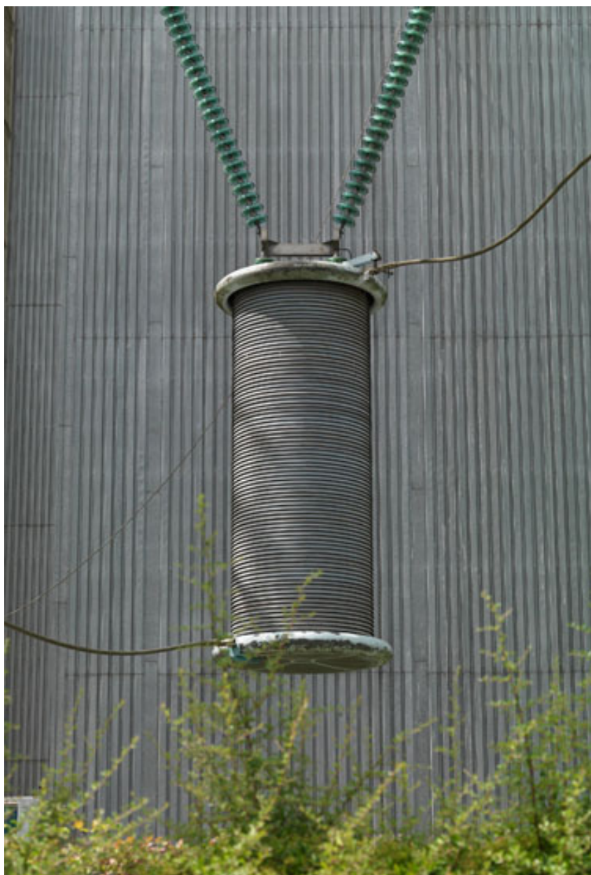
Charpente électrique extérieure. Détail. En arrière-plan, le Hall d'essais synthétiques.
