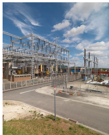
Charpente électrique extérieure. Phot. Philippe Ayrault IVR11_20117700876NUC4A
