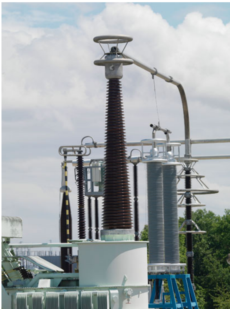
Installations électriques expérimentales.
