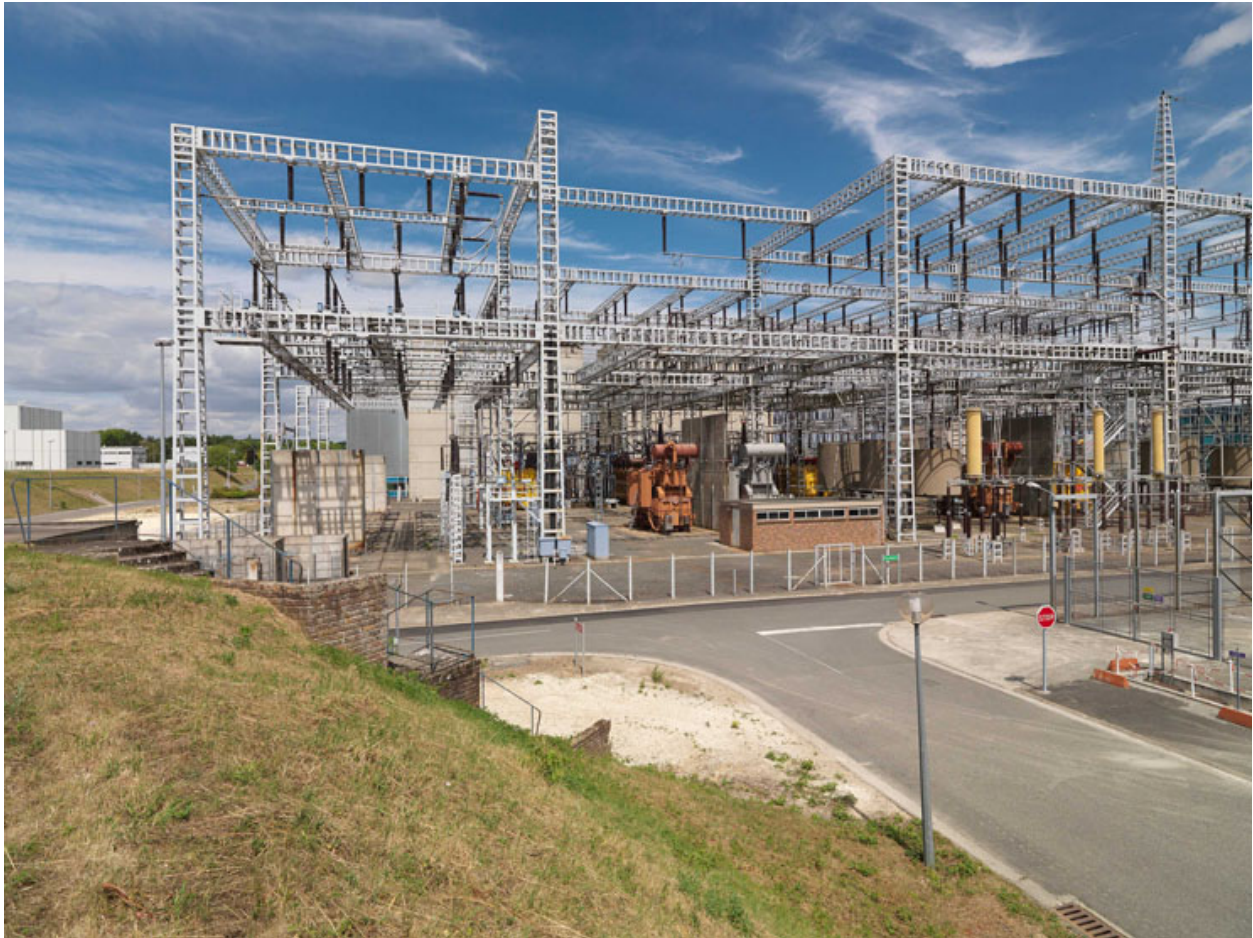
Charpente électrique extérieure. En arrière-plan a gauche, le département CIMA (Câbles, condensateurs, Isolants, Matériels d'Automatisme).
