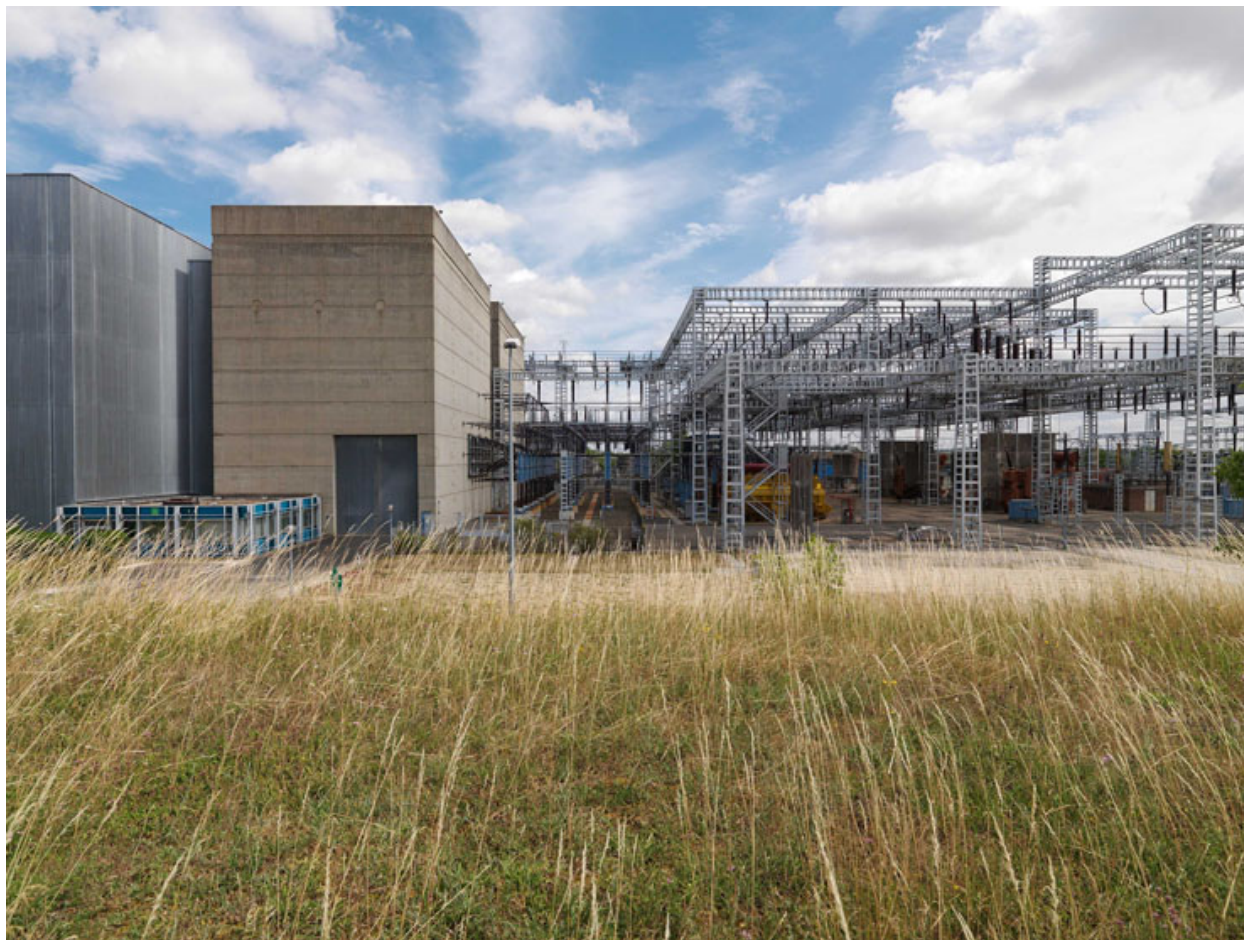
Charpente électrique extérieure et Hall STGP (Station d'essais grande puissance) avec module de bureaux bleu et à droite le Hall d'essais synthétiques.
