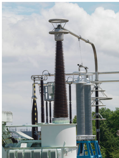
Installations électriques expérimentales. Phot. Philippe Ayrault IVR11_20117700803NUC4A
