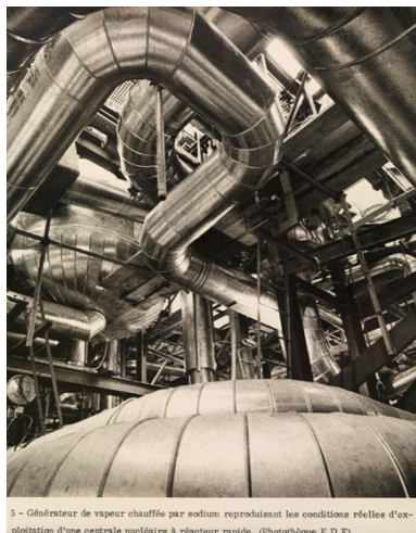
5 - Générateur de vapeur chauffée par sodium reproduisant les conditions réelles d'exploitation d'une centrale nucléaire à réacteur rapide. (Photothèque E D F).
