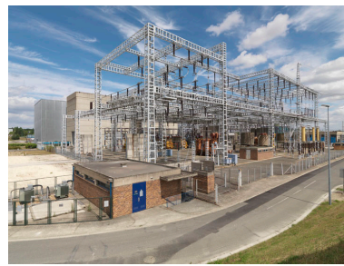
Charpente électrique extérieure. En arriere-plan à gauche le Hall STGP (Station d'essais grande puissance), le Hall d'essais synthétiques et un module de bureaux bleu.
