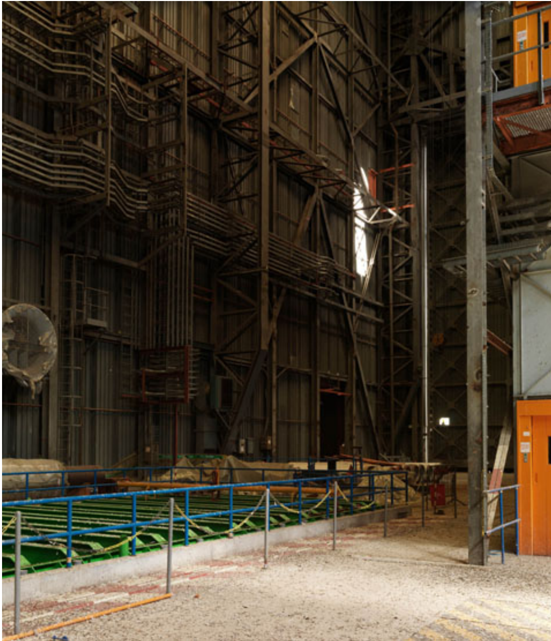
Intérieur du Hall CGVS (Circuit d'essais de Générateurs de Vapeur chauffés au Sodium).
