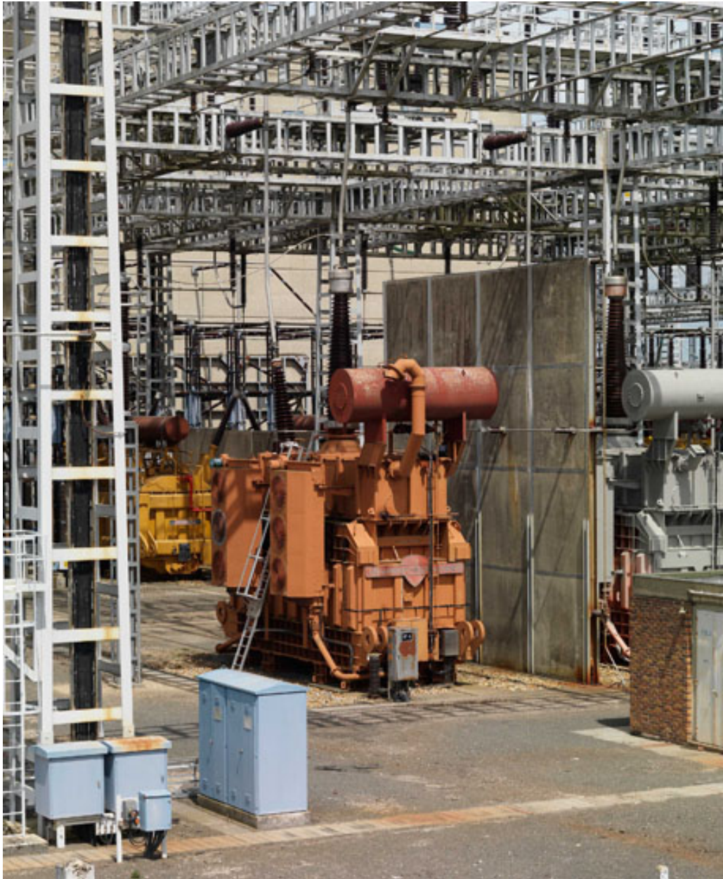
Charpente électrique extérieure.
