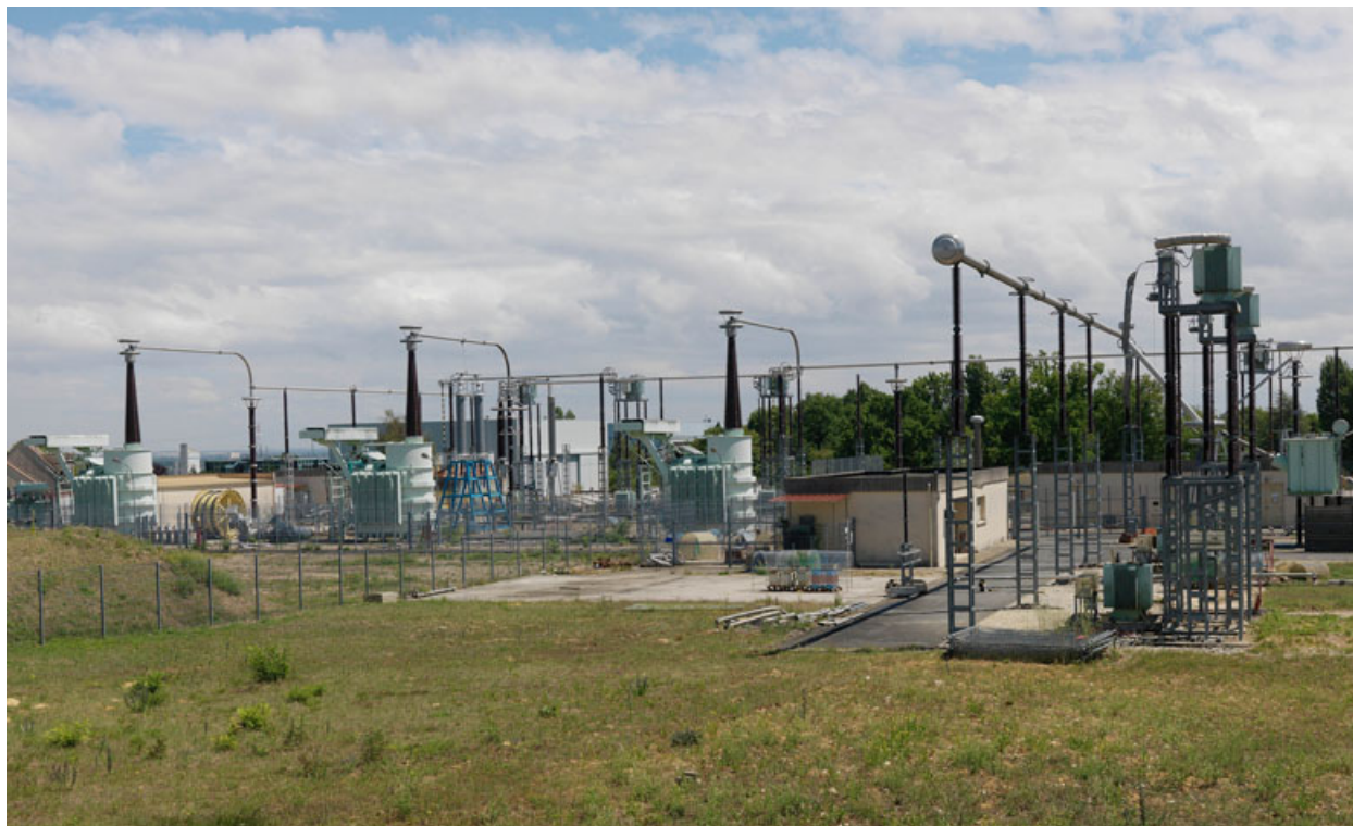
Installations électriques expérimentales.
