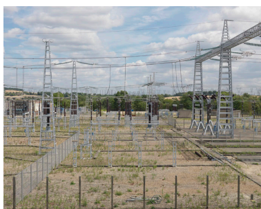
Arrivée de la Très haute tension sur le site des Renardières. Poste de transformation. En arrière-plan le paysage de pylônes aux abords du Poste du Chesnoy et de la Centrale de Montereau. Phot. Philippe Ayrault IVR11_20117700885NUC4A
