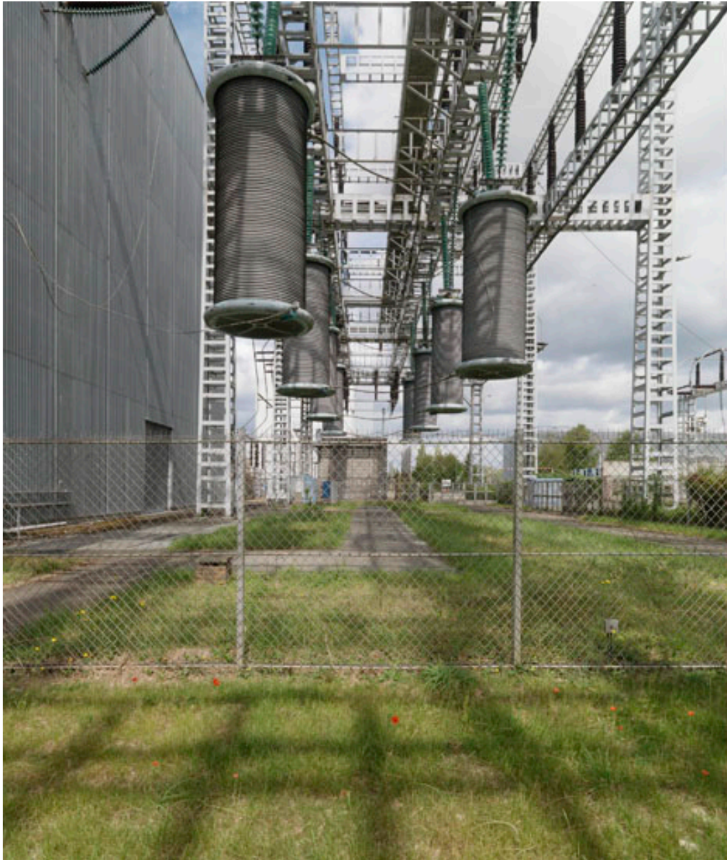
Charpente électrique extérieure. Détail. A gauche le Hall d#essais synthétiques.
