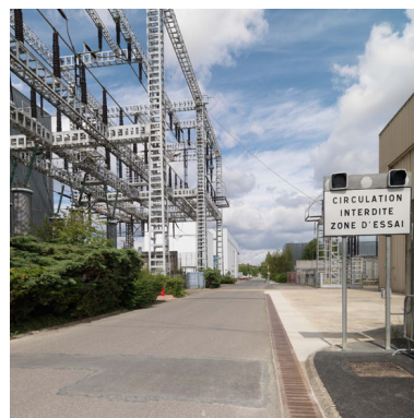
Charpente électrique extérieure. En arrière-plan le LEHT (Laboratoire d'essais haute tension). A droite le laboratoire LGEP (Laboratoire d'essais grande puissance). Phot. Philippe Ayrault IVR11_20117700870NUC4A
