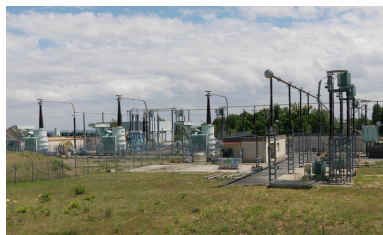
Installations électriques expérimentales. Phot. Philippe Ayrault IVR11_20117700800NUC4A
