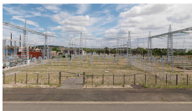
Poste de transformation. Arrivée de la Très haute tension. Phot. Philippe Ayrault IVR11_20117700882NUC4A
