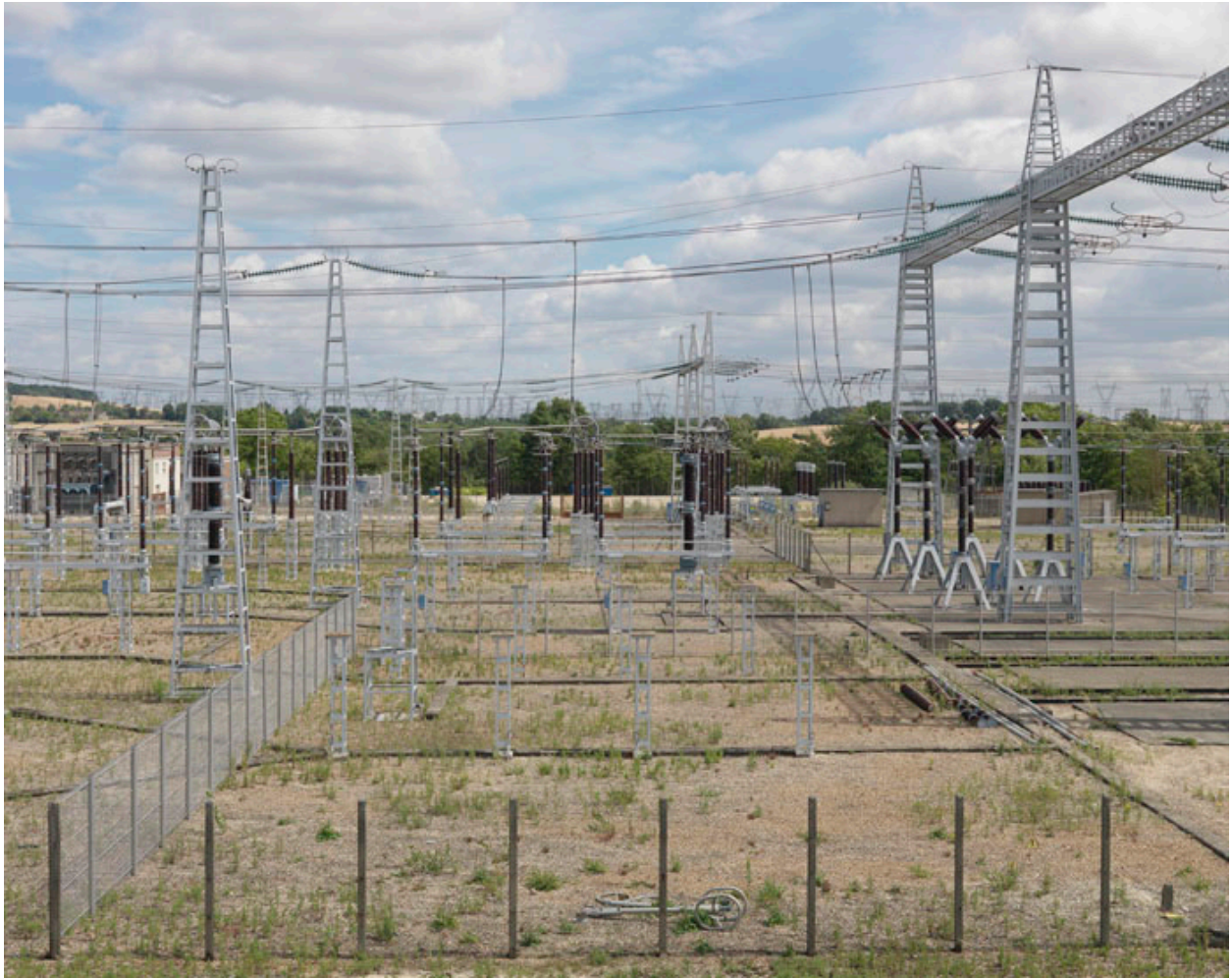
Arrivée de la Très haute tension sur le site des Renardières. Poste de transformation. En arrière-plan le paysage de pylônes aux abords du Poste du Chesnoy et de la Centrale de Montereau.
