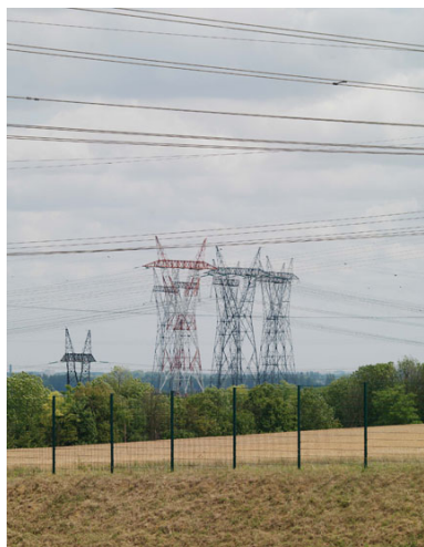
Paysage aux abords du site des Renardières. Pylônes et lignes d'alimentation. Phot. Philippe Ayrault IVR11_20117700887NUC4A
