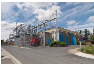
Charpente électrique extérieure. En arrière-plan à droite un bâtiment de bureaux bleu de trois étages rénové. Phot. Philippe Ayrault IVR11_20117700891NUC4A
