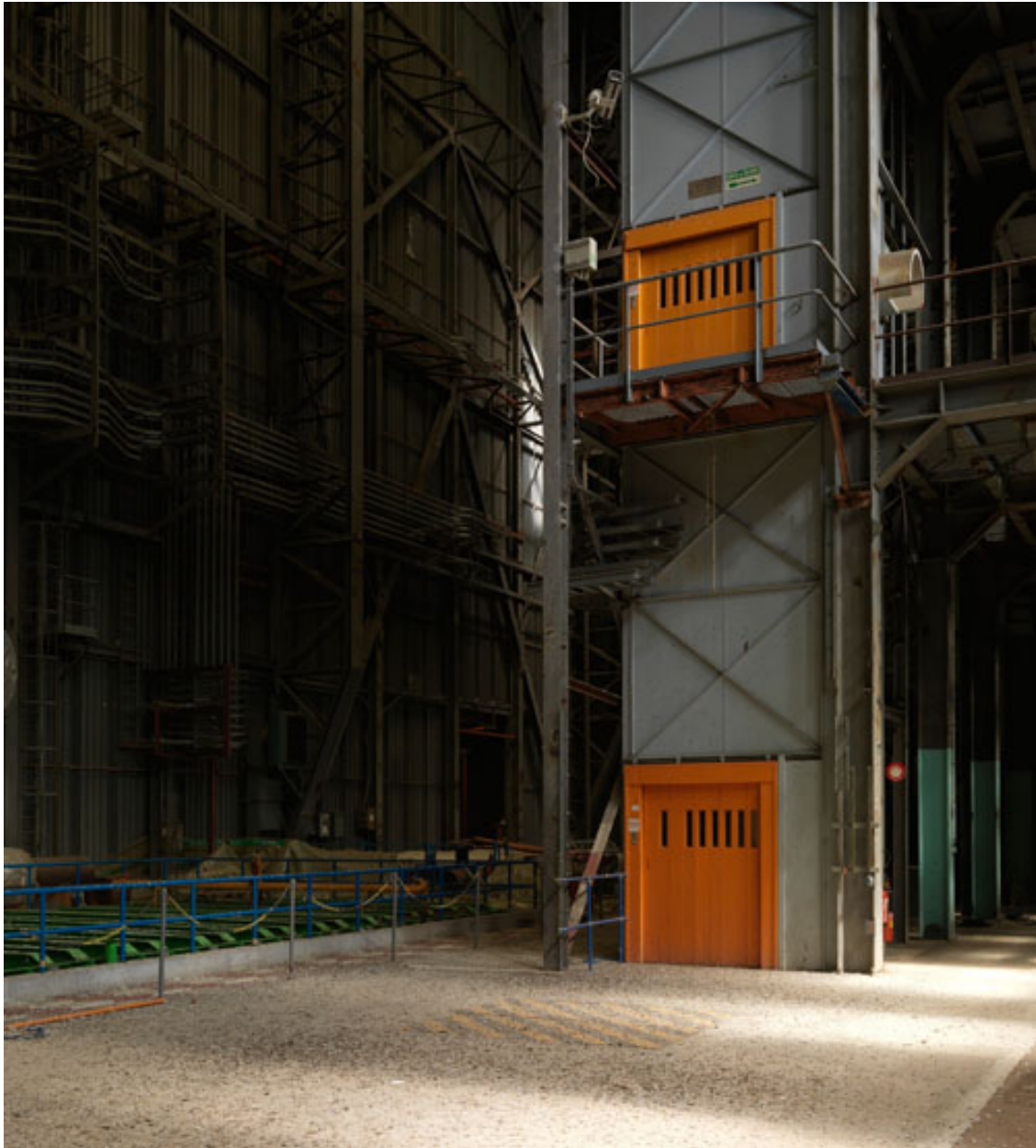
Intérieur du Hall CGVS (Circuit d'essais de Générateurs de Vapeur chauffés au Sodium). Monte-charges.
