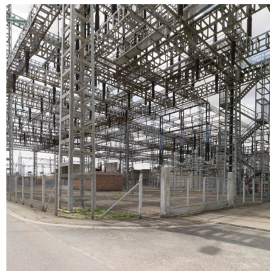
Charpente électrique extérieure. Phot. Philippe Ayrault IVR11_20117700874NUC4A
