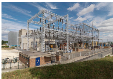
Charpente électrique extérieure. En arrière-plan à gauche le Hall STGP (Station d'essais grande puissance), le Hall d'essais synthétiques et un module de bureaux bleu.
