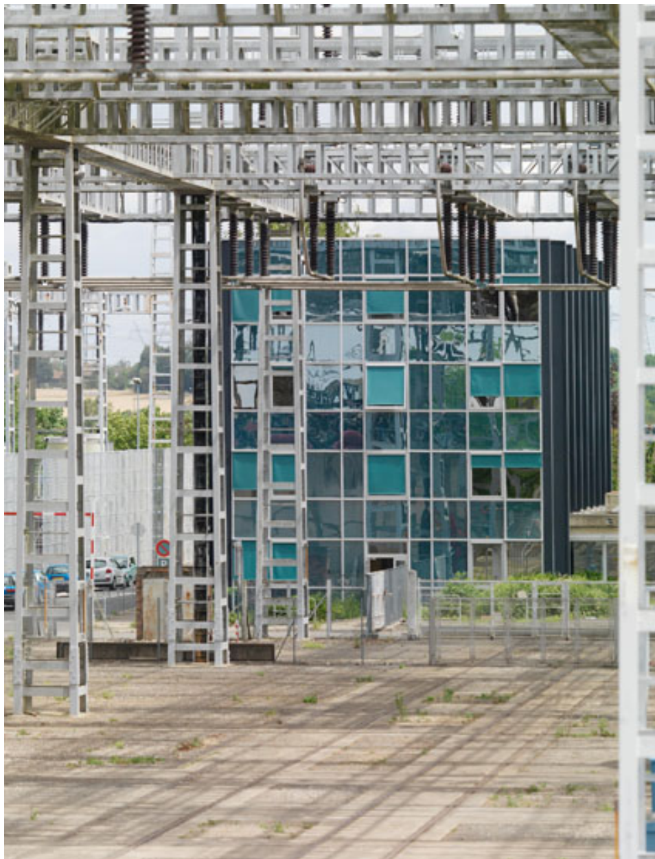
Charpente électrique extérieure. En arrière-plan un bâtiment de bureaux bleu de trois étages rénové. Département LEP (Laboratoire d'essais de puissance).
