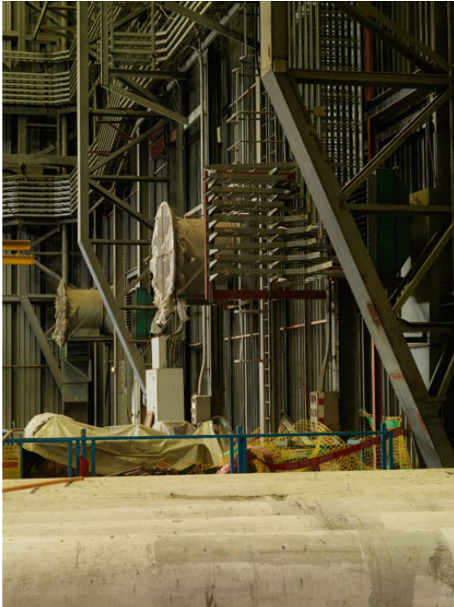
Intérieur du Hall CGVS (Circuit d'essais de Générateurs de Vapeur chauffés au Sodium).
