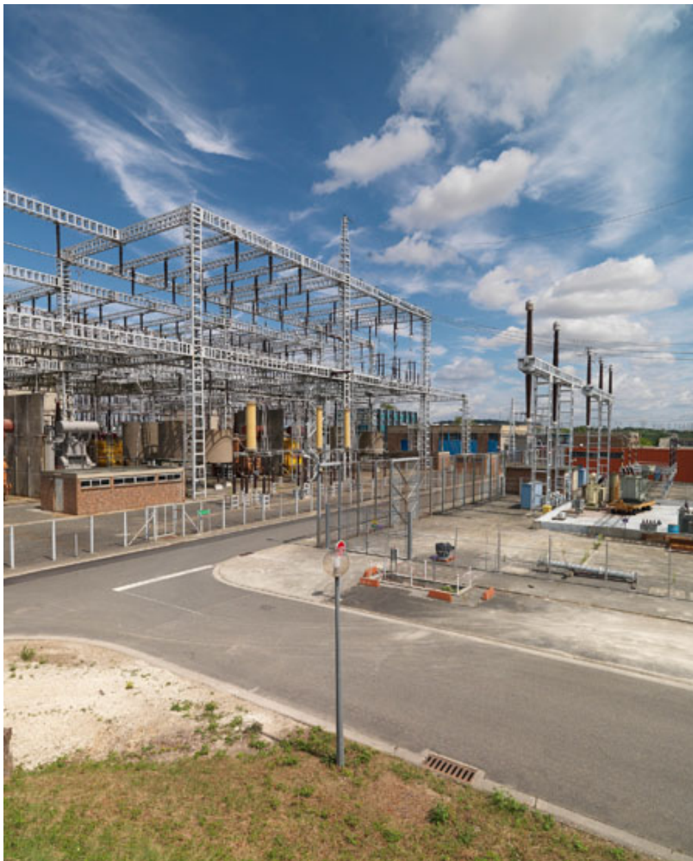
Charpente électrique extérieure.
