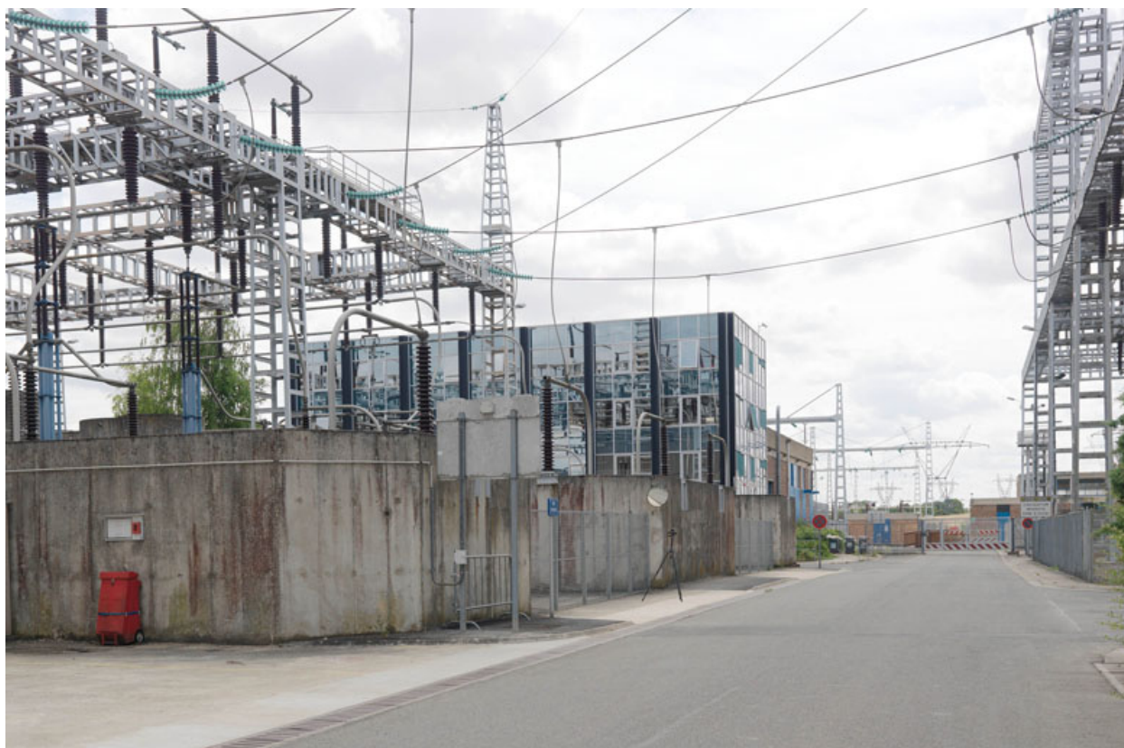
Charpente électrique extérieure. En arrière-plan un bâtiment de bureaux bleu de trois étages rénové et des petites constructions en briques pour la logistique. Département LEP (Laboratoire d'essais de puissance).
