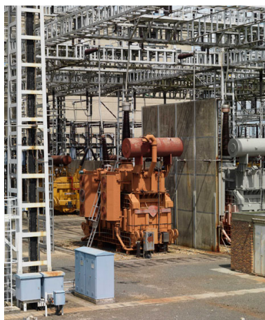
Charpente électrique extérieure. Phot. Philippe Ayrault
