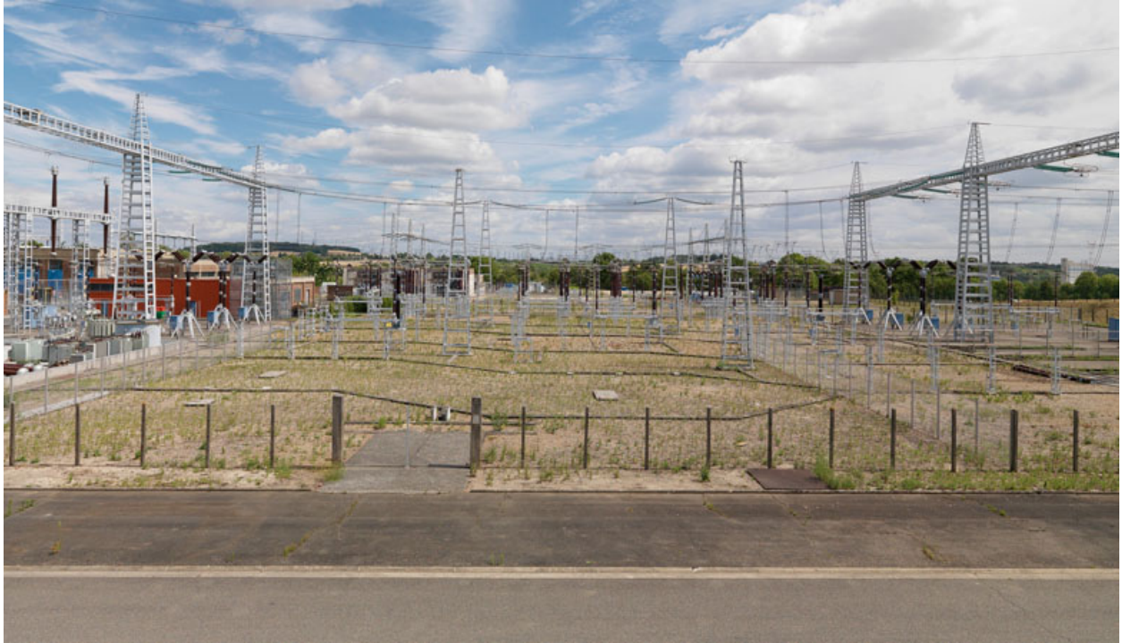
Poste de transformation. Arrivée de la Très haute tension.
