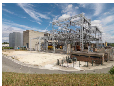
Charpente électrique extérieure. En arrière-plan à gauche le Hall STGP (Station d'essais grande puissance), le Hall d'essais synthétiques et un module de bureaux bleu. Phot. Philippe Ayrault IVR11_20117700866NUC4A
