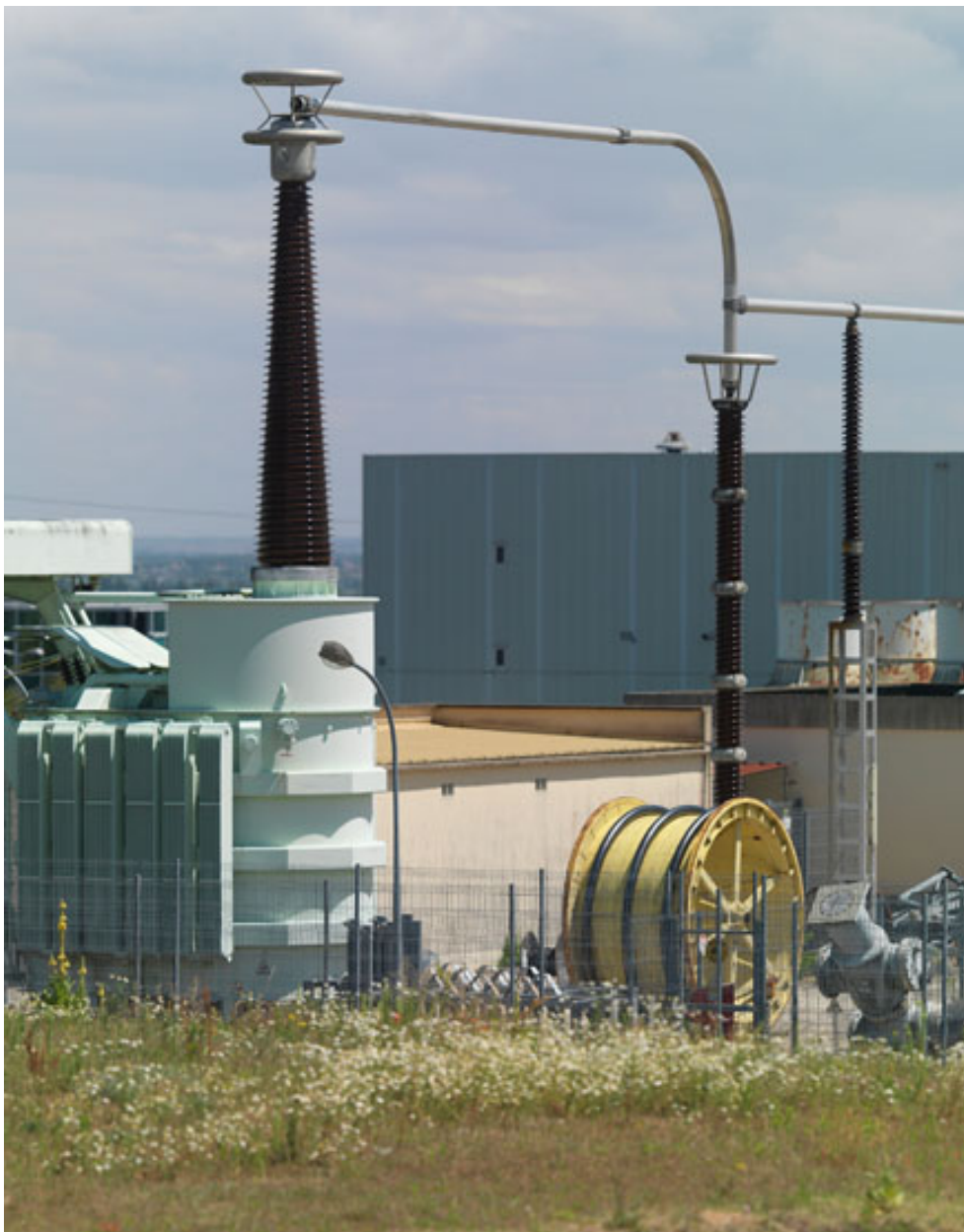
Installations électriques expérimentales. En arriere-plan le Hall C27 construit en 1981 pour abriter les boucles d#essais de centrales REP (Réacteur eau pressurisée).
