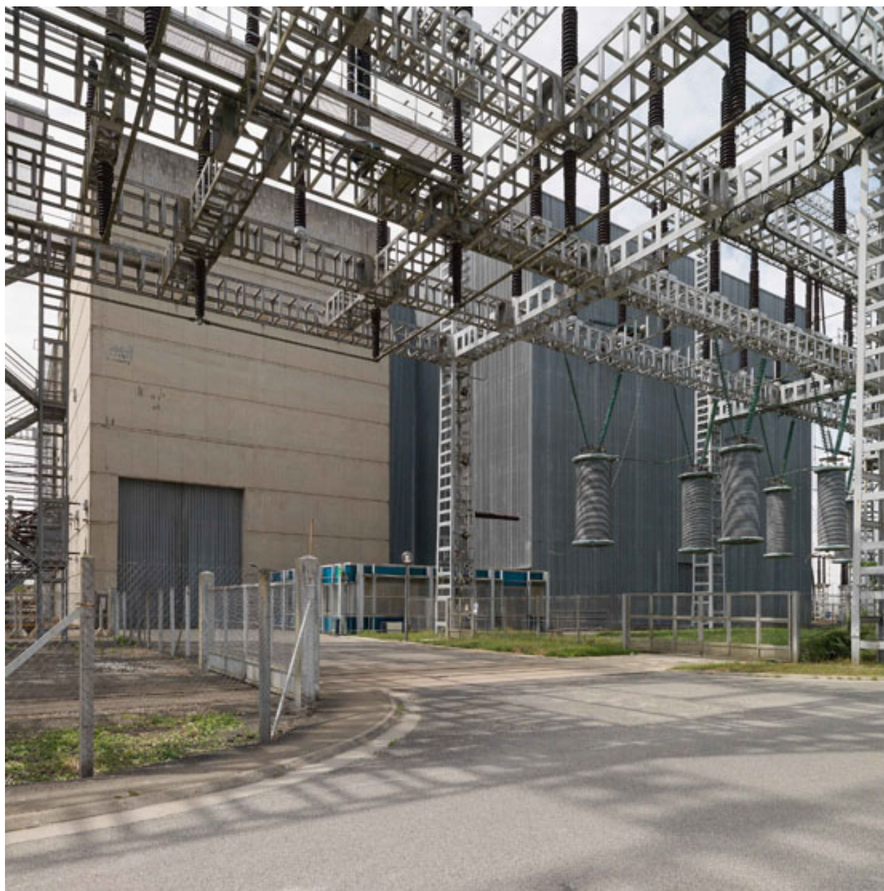
Charpente électrique extérieure devant le Hall STGP (Station d'essais grande puissance), à gauche, et le Hall d'essais synthétiques, à droite, ainsi qu'un module de bureaux bleu.
