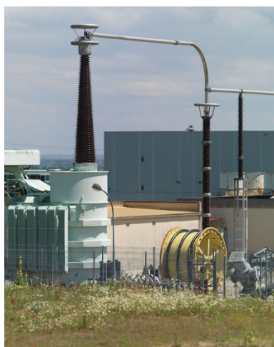
Installations électriques expérimentales. En arrière- plan le Hall C27 construit en 1981 pour abriter les boucles d'essais de centrales REP (Réacteur eau pressurisée). Phot. Philippe Ayrault IVR11_20117700801NUC4A
