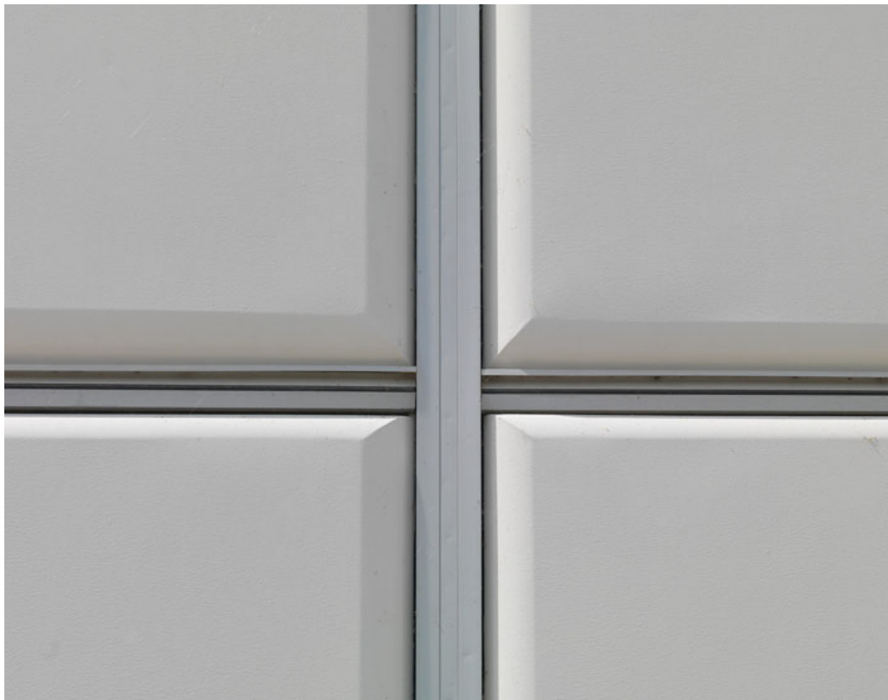
Laboratoire d'essais classique blanc de type Prouvé. Détail. Assemblage des panneaux. Traitement du joint.
