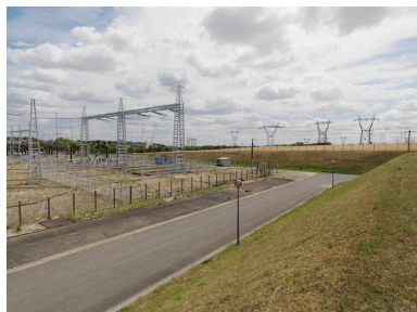
Arrivée de la Très haute tension sur le site des Renardières. Vue des abords. Phot. Philippe Ayrault IVR11_20117700883NUC4A
