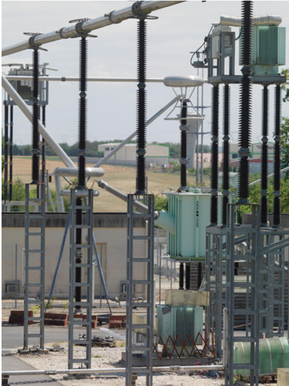
Installations électriques expérimentales.
