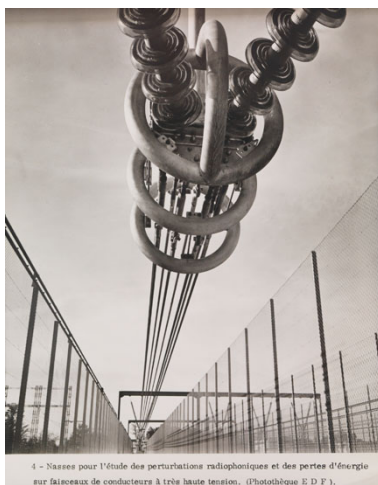
4 - Nasses pour l'étude des perturbations radioélectriques et des pertes d'énergie sur faisceaux de conducteurs à très haute tension. (Photothèque E D F). IVR11_20117700908NUC4A
