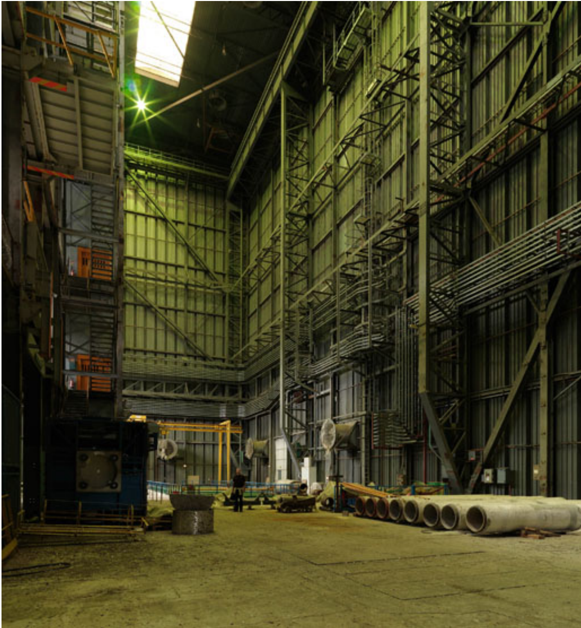
Intérieur du Hall CGVS (Circuit d'essais de Générateurs de Vapeur chauffés au Sodium).
