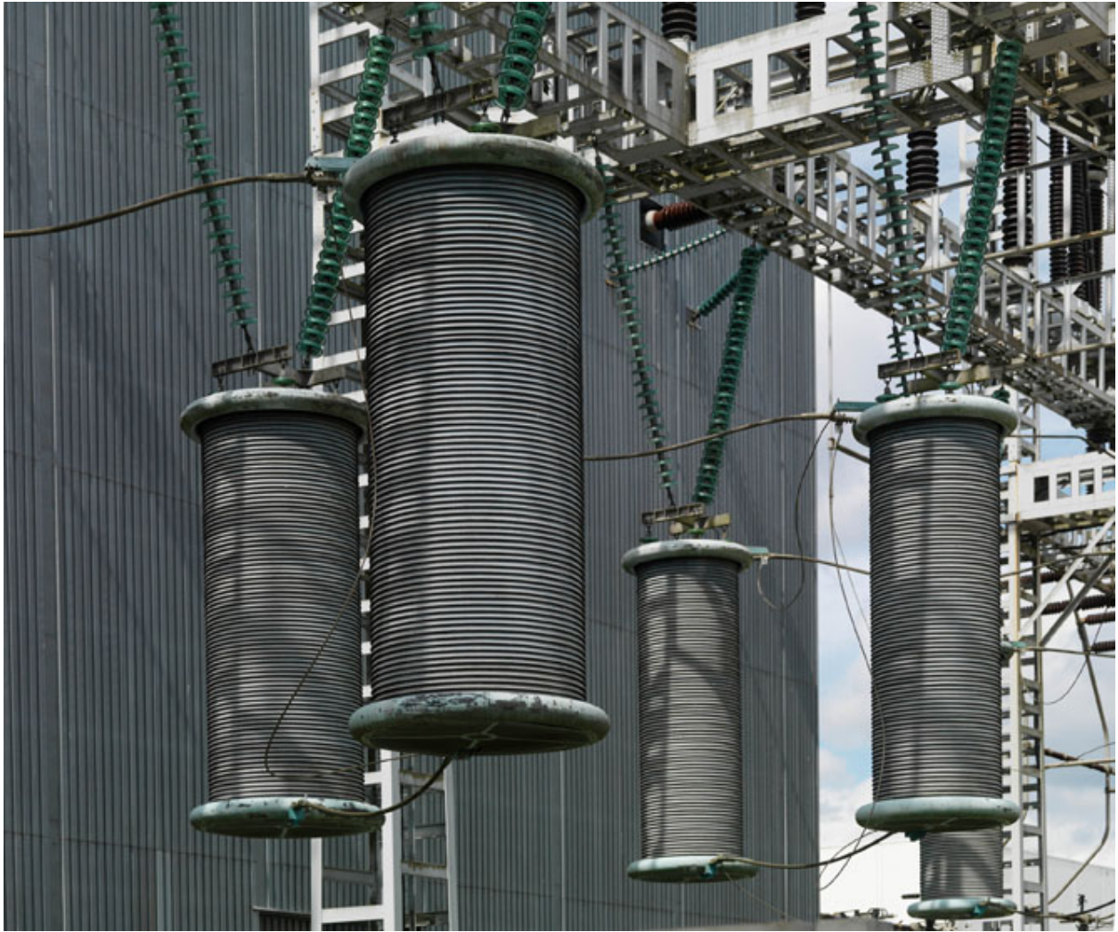
Charpente électrique extérieure. Détail. En arrière-plan, le Hall d'essais synthétiques.
