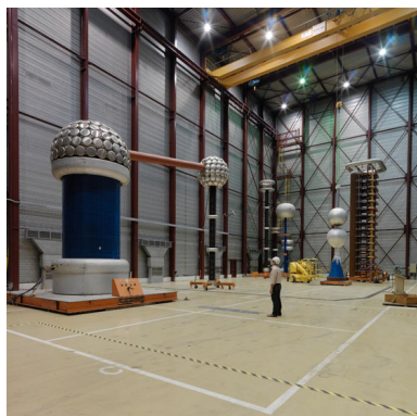
Intérieur du Hall d'essais synthétiques en bardage gris. Matériel d'essais. Phot. Philippe Ayrault IVR11_20117700854NUC4A
