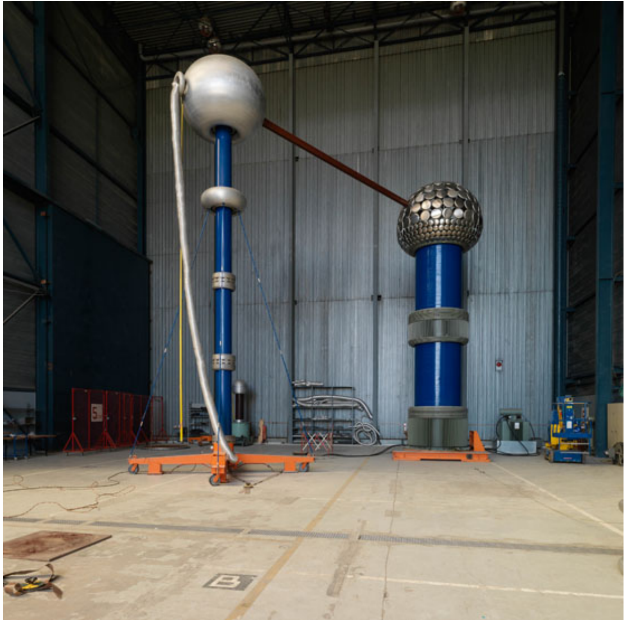
Intérieur du Hall d'essais synthétiques. Matériel d'essais.
