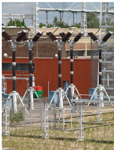
Poste de transformation. Détail. Phot. Philippe Ayrault IVR11_20117700881NUC4A
