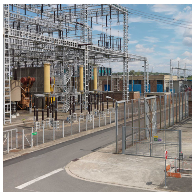
Charpente électrique extérieure. Détail. Phot. Philippe Ayrault IVR11_20117700879NUC4A
