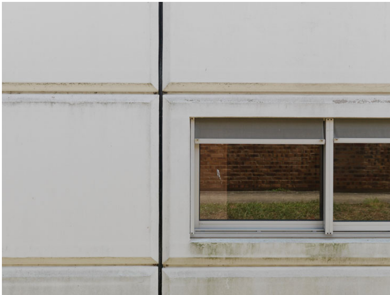
Laboratoire d'essais classique blanc de type Prouvé. Détail. Assemblage des panneaux. Traitement du joint.
