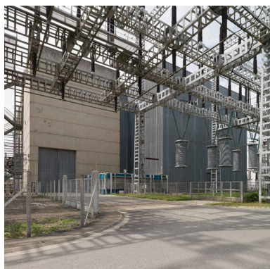
Charpente électrique extérieure devant le Hall STGP (Station d'essais)
