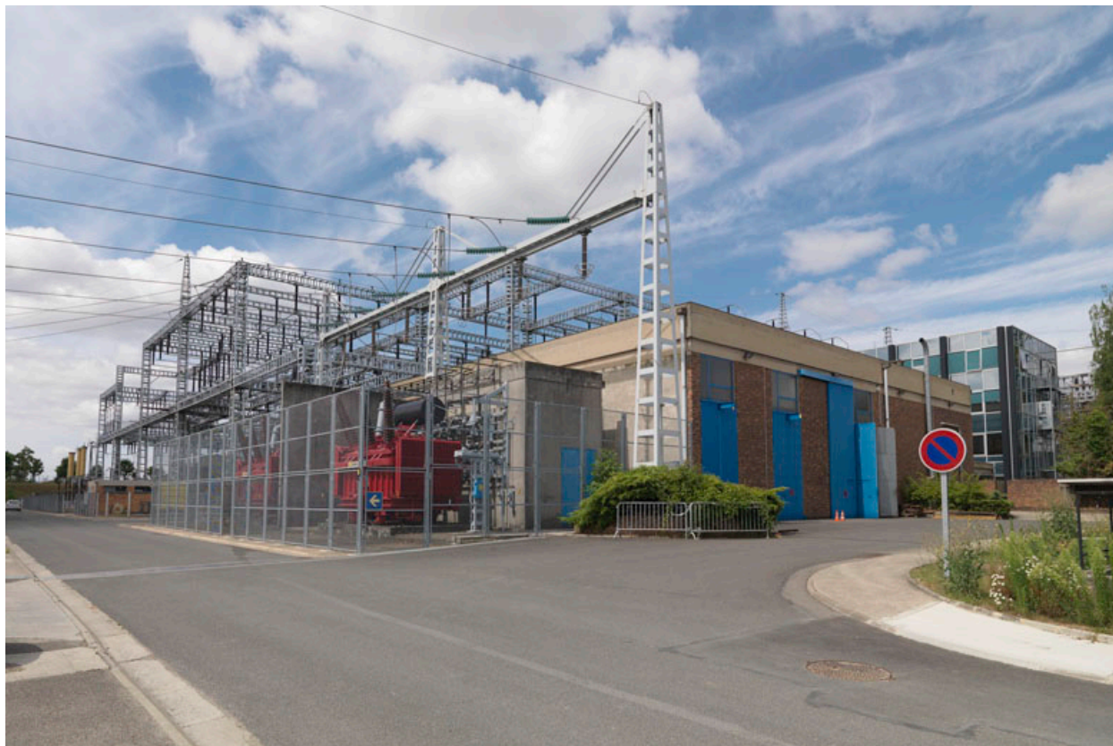
Charpente électrique extérieure. En arrière-plan à droite un bâtiment de bureaux bleu de trois étages rénové.
