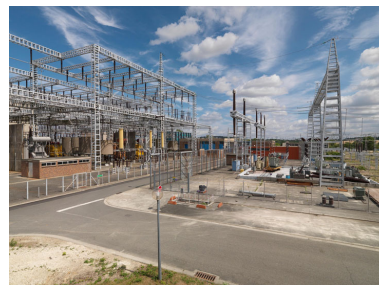
Charpente électrique extérieure. Phot. Philippe Ayrault IVR11_20117700880NUC4A
