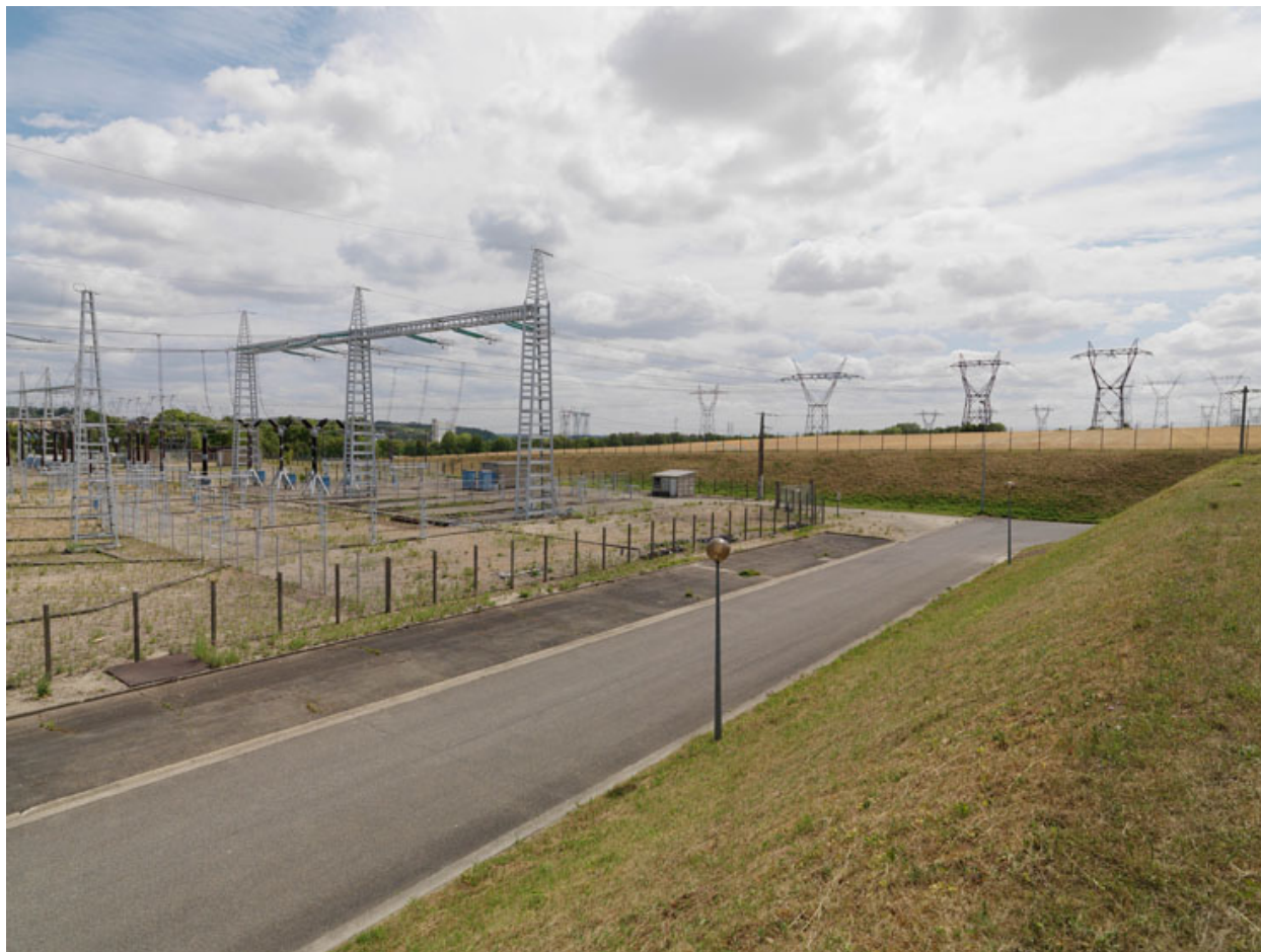
Arrivée de la Très haute tension sur le site des Renardières. Vue des abords.
