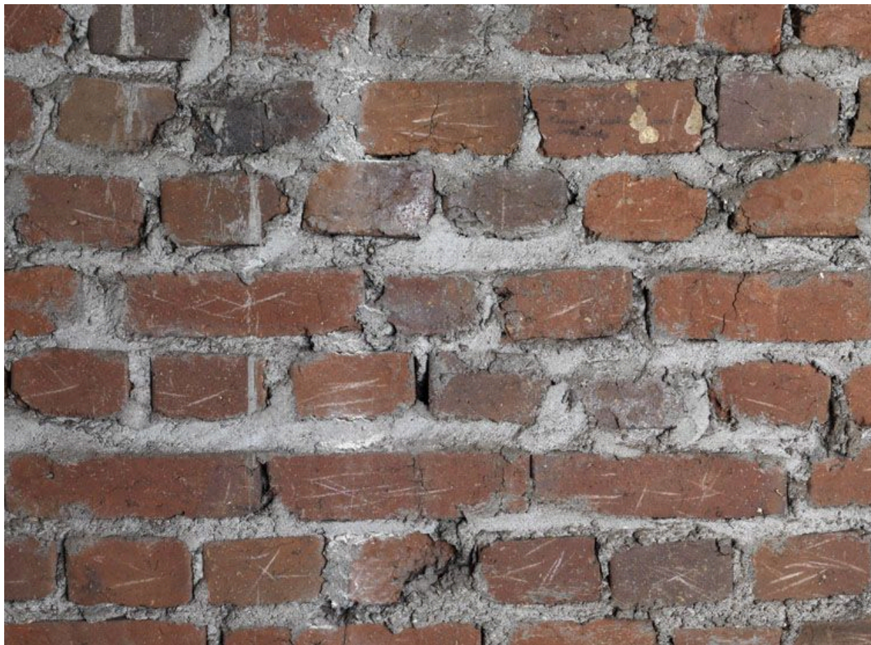
Vue rapprochée d'un mur avec graffiti et griffures sur brique.
