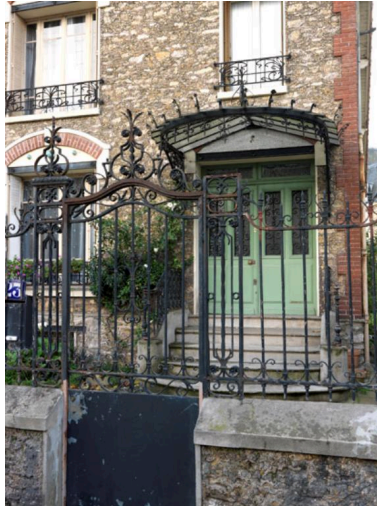
Vue de la marquise d'entrée et de la ferronnerie du portail. Phot. Laurent Kruszyk IVR11_20167800700NUC4A
