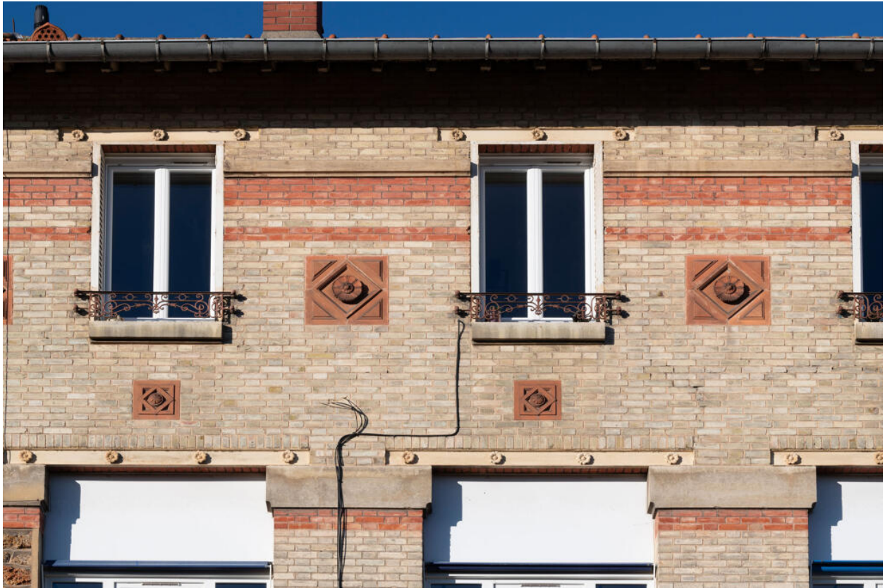
École Élémentaire de Montretout, détail des décors de briques et de céramiques, rosettes et cabochons
