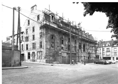
Le mur pignon comportait encore des ouvertures qui ont été murées depuis. (Fonds Bertin).
