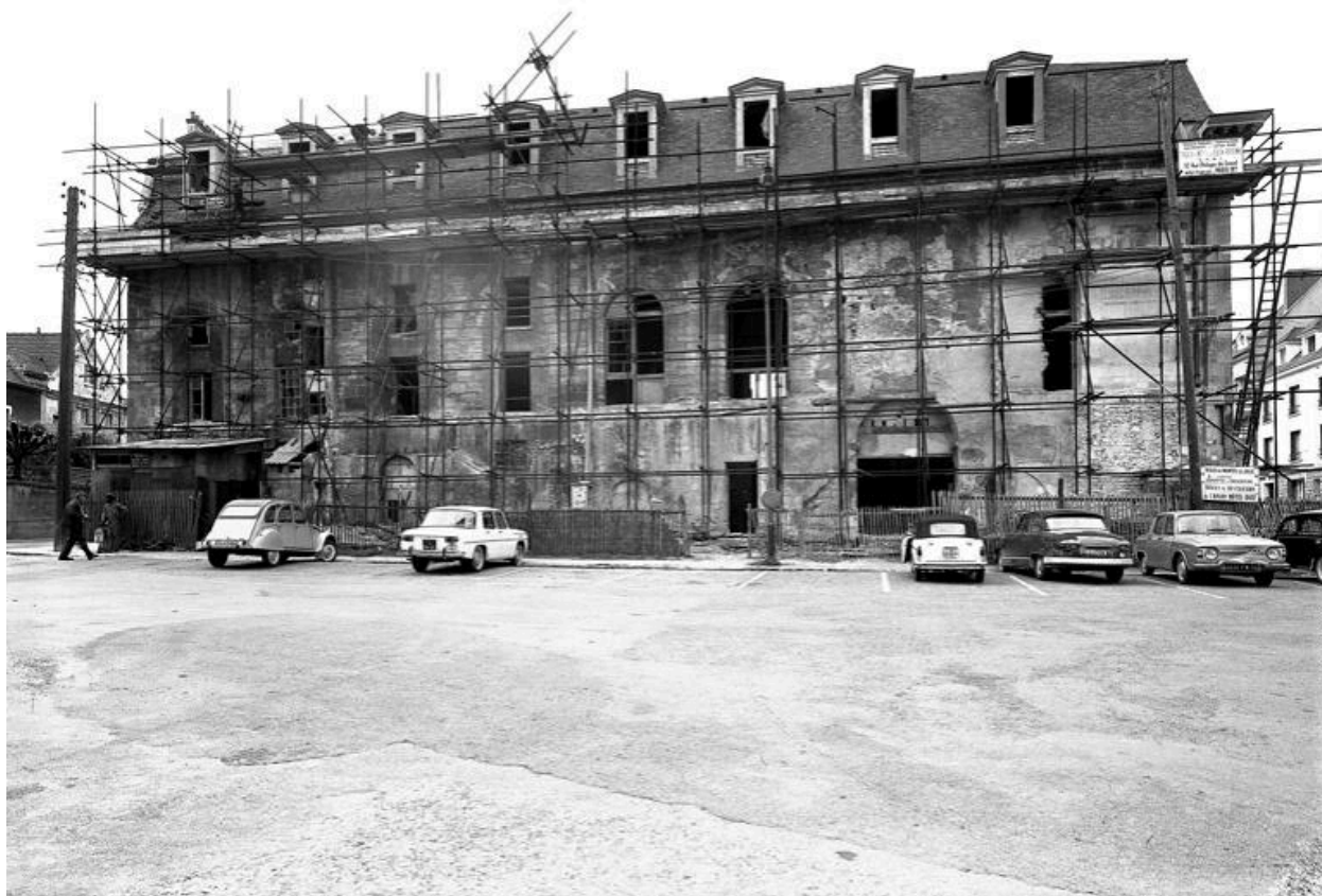
La façade sur la rue du Château en cours de restauration. (Fonds Bertin)
