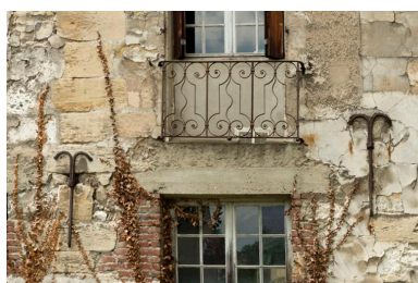
Cette partie du bâtiment en très mauvais état a conservé un garde-corps à balustres droits du XVIIe siècle. Phot. Laurent Kruszyk IVR11_20177800437NUC4A
