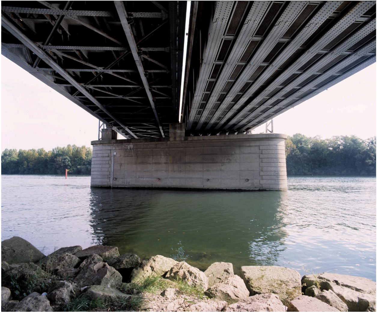
Vue inférieure des tabliers (8 poutres à âme pleine supportant une dalle en béton armé côté amont, tôle rivetée en croix de Saint-André côté aval).
