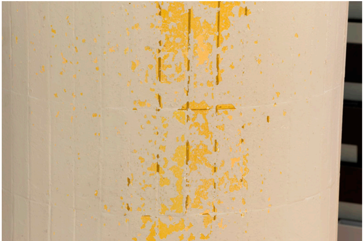
Vestiges de carrelage sur les piliers de l'ancien bassin.
