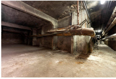
Vue des conduits d'alimentation du bassin en sous-sol.
