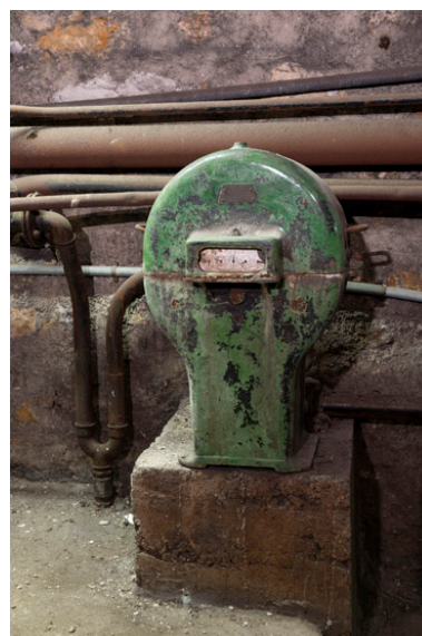
Vue d'un appareil de mesure en sous-sol. Phot. Laurent Kruszyk IVR11_20157500486NUC4A
