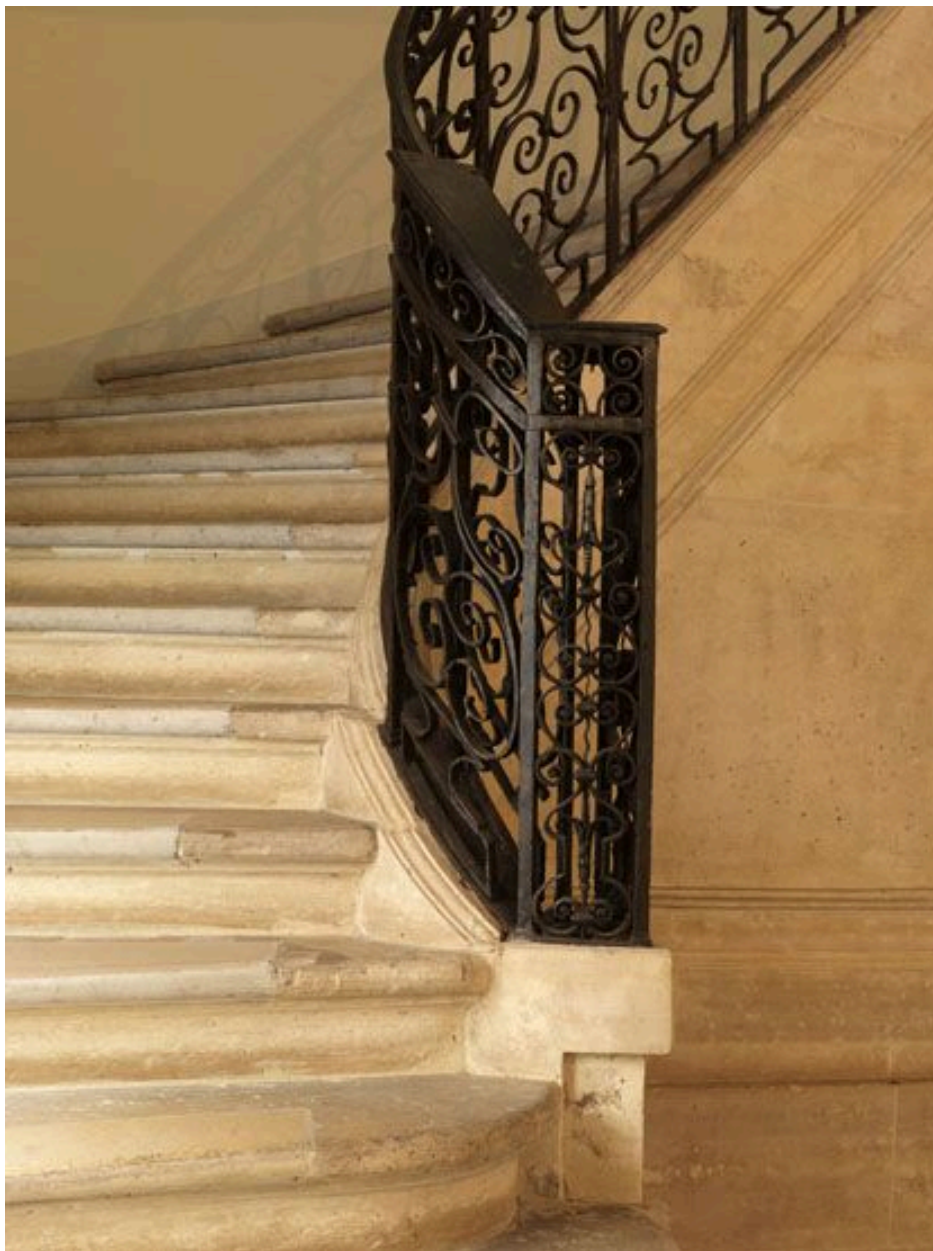
Vue frontale du départ de l'escalier et de la gaine de départ.
