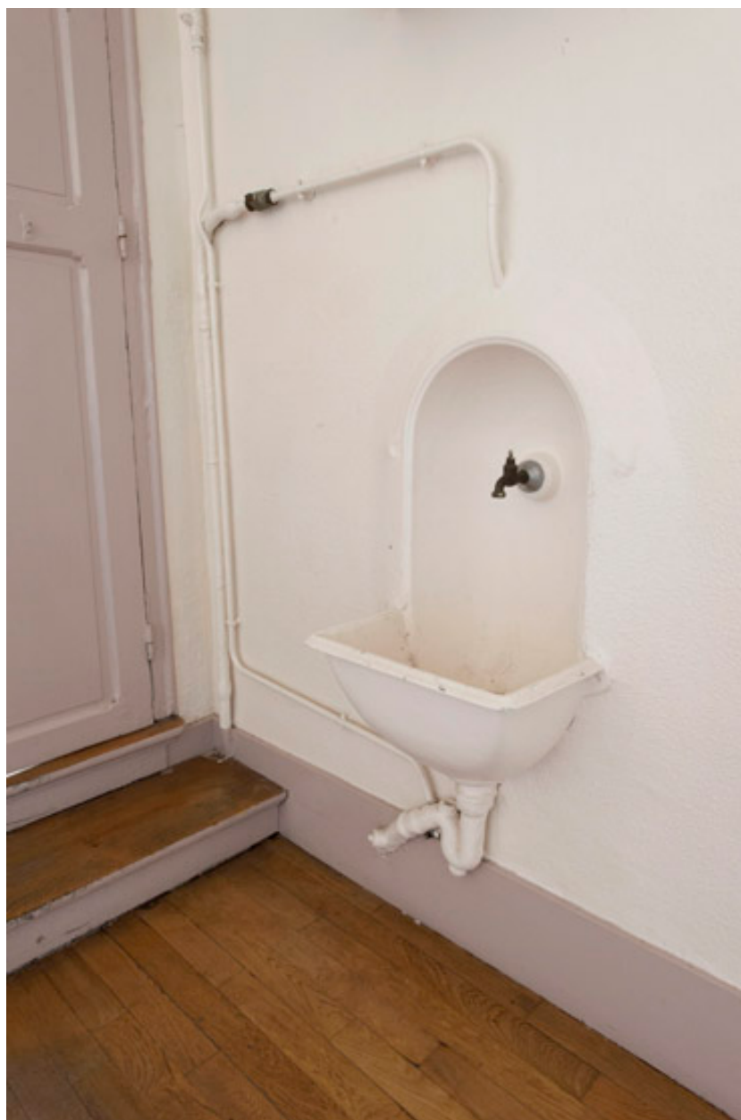
Vue du lavabo situé dans le couloir du premier étage.
