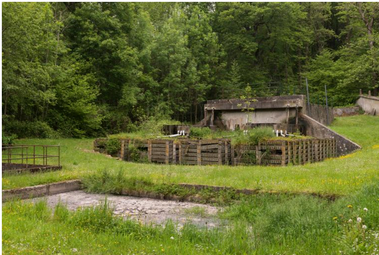
bassin d'épuration. Au 1er plan : bac de séchage des boues, au 2e plan : bac de nitrification et fosse de décantation
