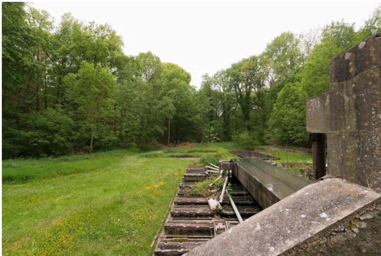
bassin d'épuration : éléments sortant de la fosse de digestion, avant passage en bac de nitrification
