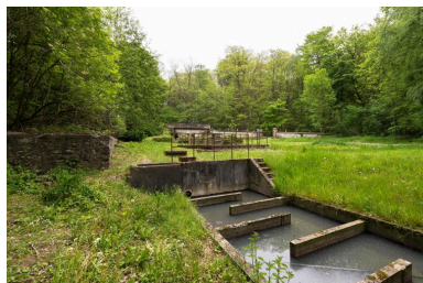
bassin d'épuration: bac de décantation, les murets servent à freiner la vitesse de l'eau Phot. Philippe Ayrault IVR11_20199500020NUC4A
