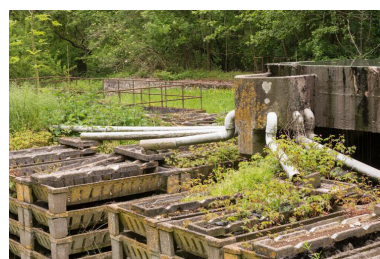
bassin d'épuration : réseau de tuyaux qui répartissent dans les bacs Phot. Philippe Ayrault IVR11_20199500025NUC4A
