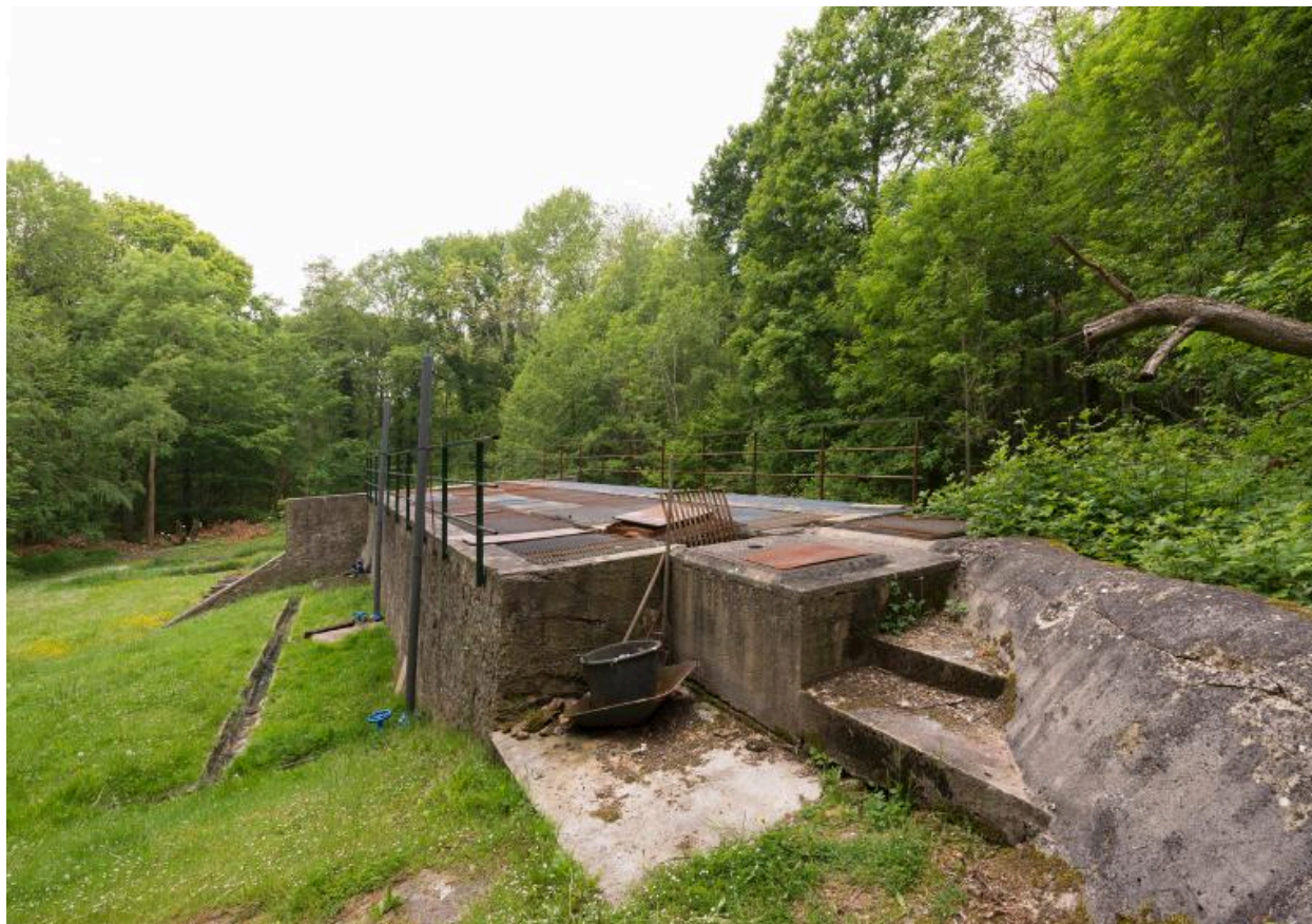
bassin d'épuration : 1er plan : dégrilleur sommaire et poubelle évacuant les déchets retenus par la grille
