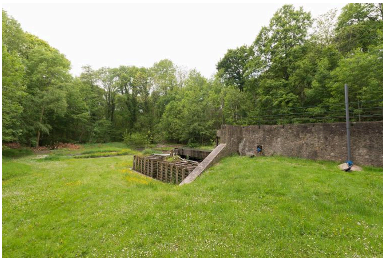
bassin d'épuration : vue de la fosse de digestion et des bacs de nitrification
