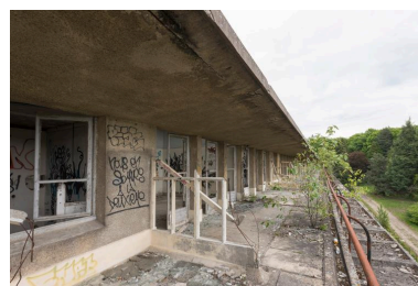
pavillon Bonnefoy-Sibour, vue de la terrasse du dernier étage, côté sud Phot. Philippe Ayrault IVR11_20199500058NUC4A
