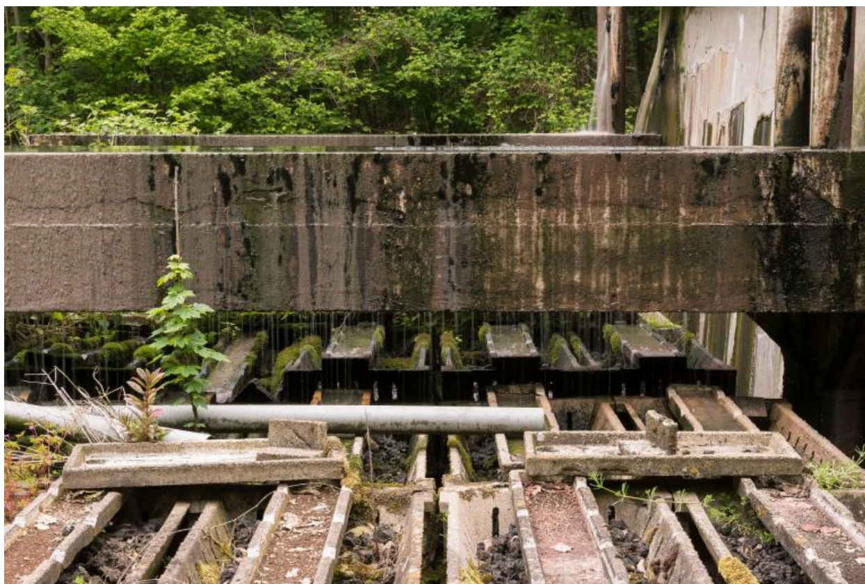
bassin d'épuration : vue de détail du bac de nitrification
