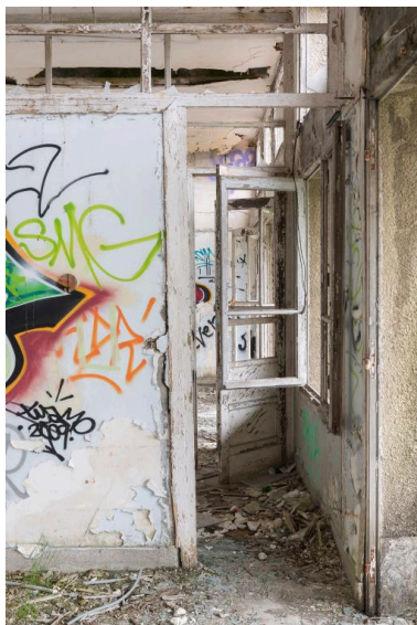
pavillon Bonnefoy-Sibour, enfilade entre plusieurs locaux techniques Phot. Philippe Ayrault IVR11_20199500063NUC4A
