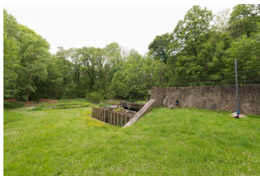
bassin d'épuration : vue de la fosse de digestion et des bacs de nitrification Phot. Philippe Ayrault IVR11_20199500021NUC4A
