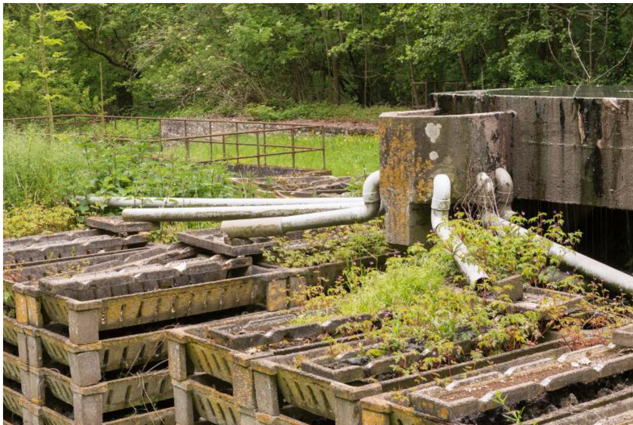
bassin d'épuration : réseau de tuyaux qui répartissent dans les bacs
