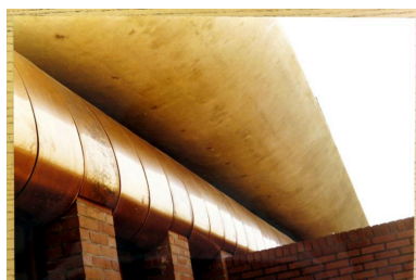
Détail du bardage en cuivre. Circa 1975. SIAF/CAPA. Fonds Robert Auzelle 242 IFA, boîte 53, affaire RA 17. Phot. Isabelle Duhau IVR11_20179300258NUCA
