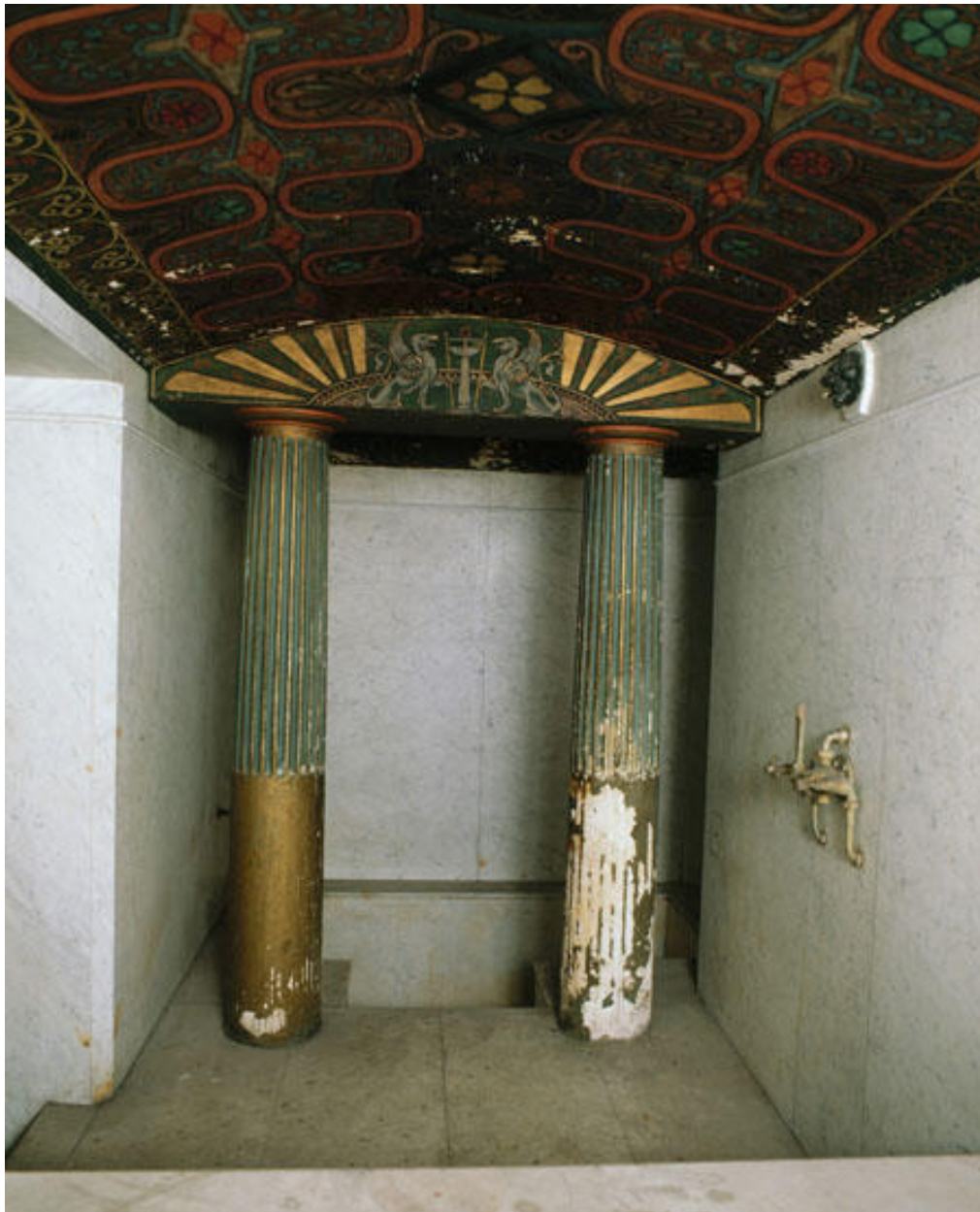
Vue d'ensemble du hammam du sous-sol, salle de la piscine (marbre et plâtre peint), détruit.
