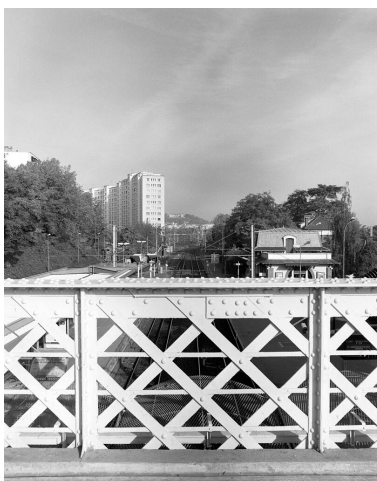
Gare du Val d'Or, passerelle en charpente métallique Phot. Ayrault Philippe IVR11_19969201028X
