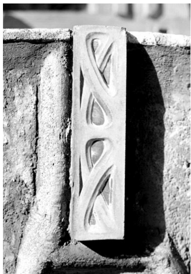
Détail d'une brique moulurée décorant les ouvertures du rez-de-chaussée. Phot. Christian Décamps IVR11_19869400285X
