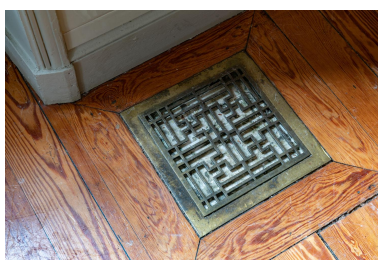
Grille de chauffage dans l'un des salons du rez-de-chaussée. Phot. Laurent Kruszyk IVR11_20227800339NUC4A
