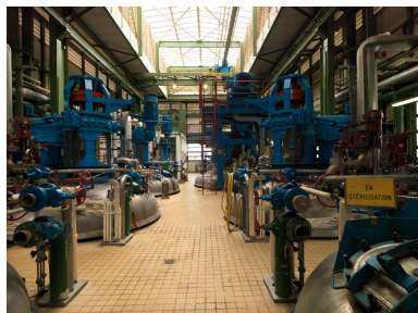
Site Sanofi. Bâtiment de transformation. Cuves. Phot. Laurent Kruszyk IVR11_20099300332NUC4A
