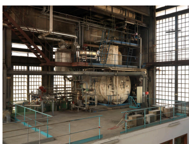
Site Sanofi. Vue intérieure du bâtiment de la chaufferie. Phot. Laurent Kruszyk IVR11_20099300521NUC4A
