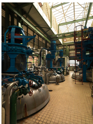
Site Sanofi. Bâtiment de transformation. Cuves. Phot. Laurent Kruszyk IVR11_20099300330NUC4A
