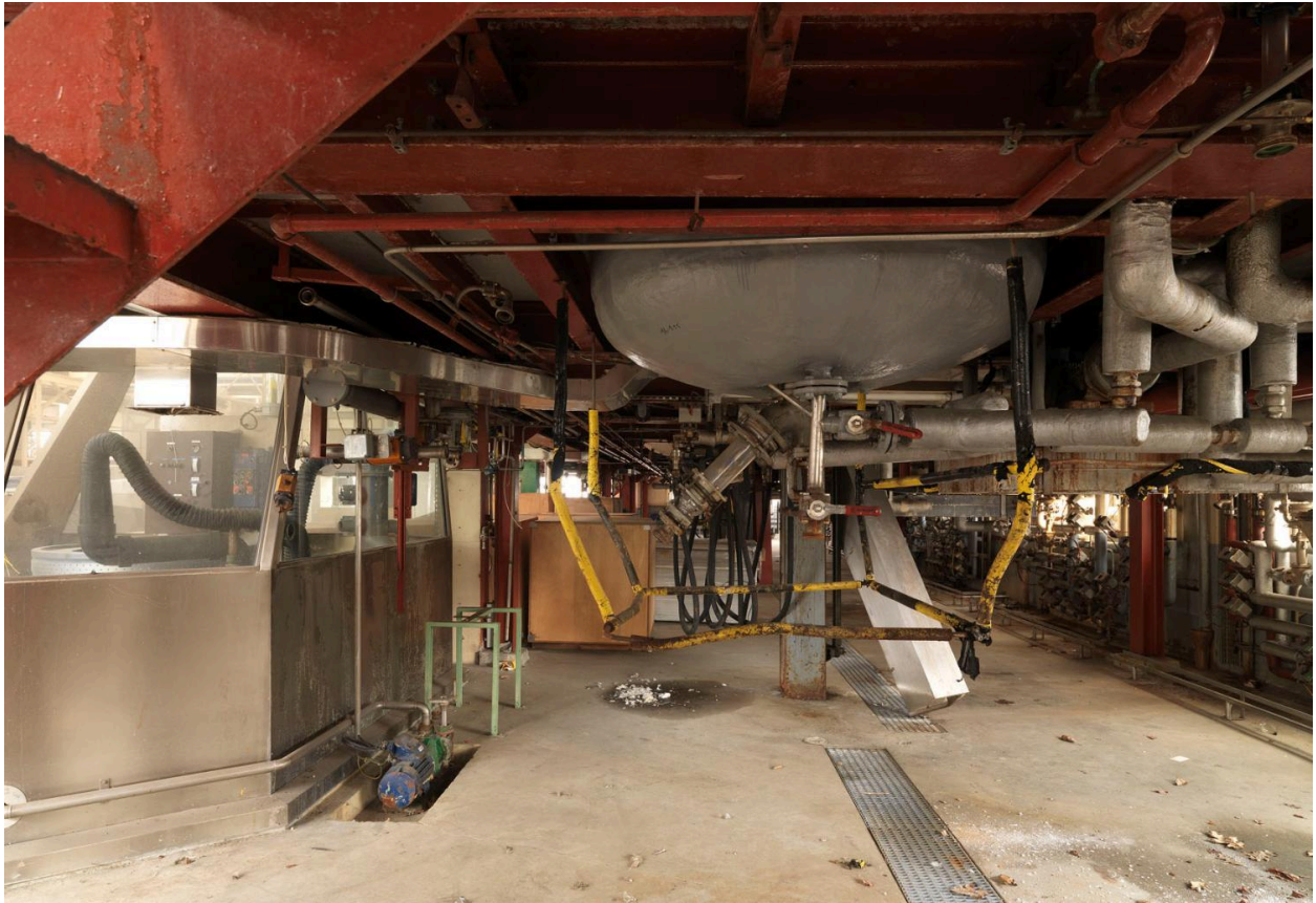
Site Biocitech, vue intérieure des équipements et machines.
