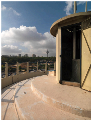
Site Biocitech. Vue du sommets du château d'eau. Phot. Laurent Kruszyk IVR11_20099300499NUC4A
