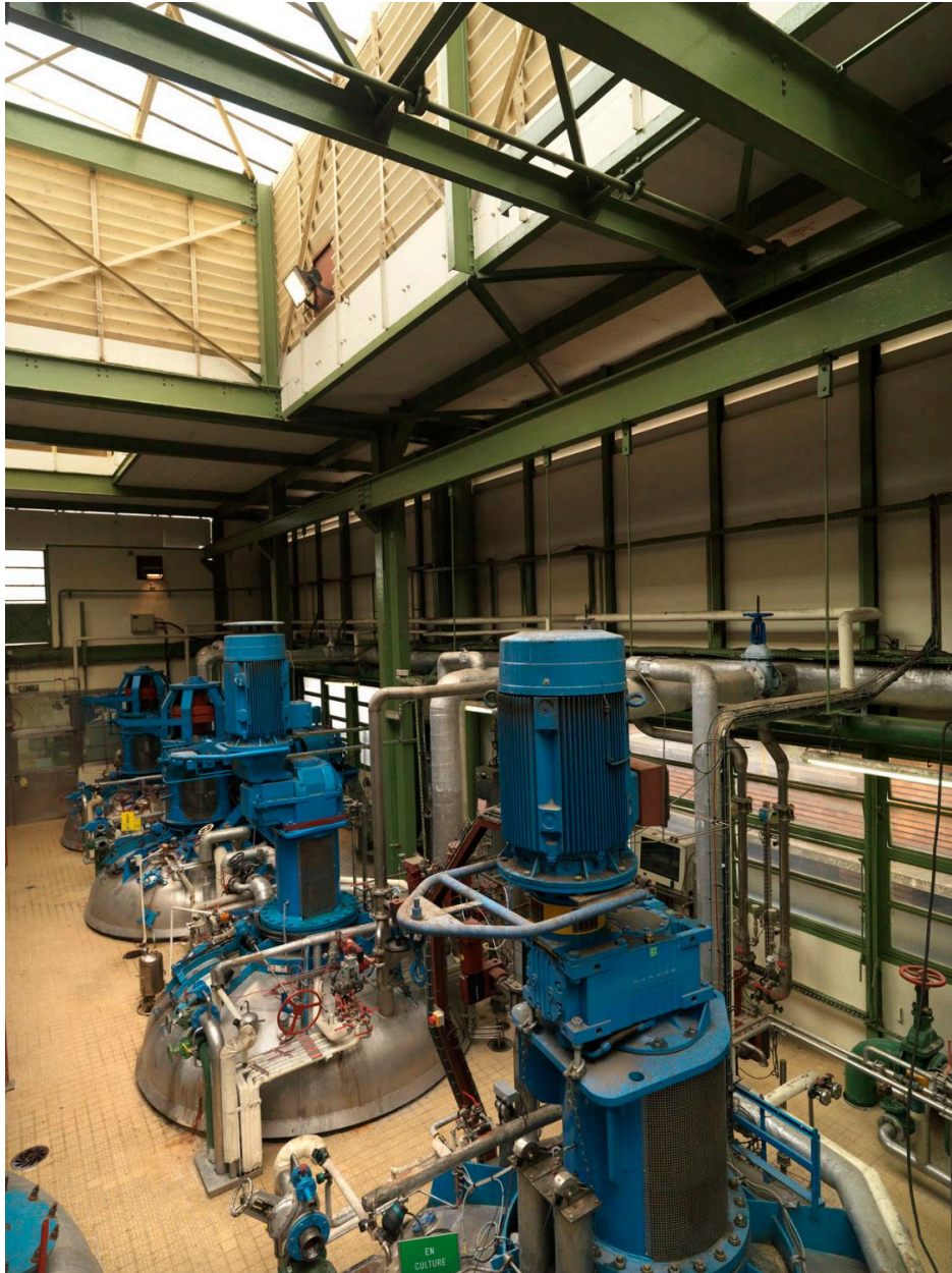
Site Sanofi. Bâtiment de transformation. Cuves.
