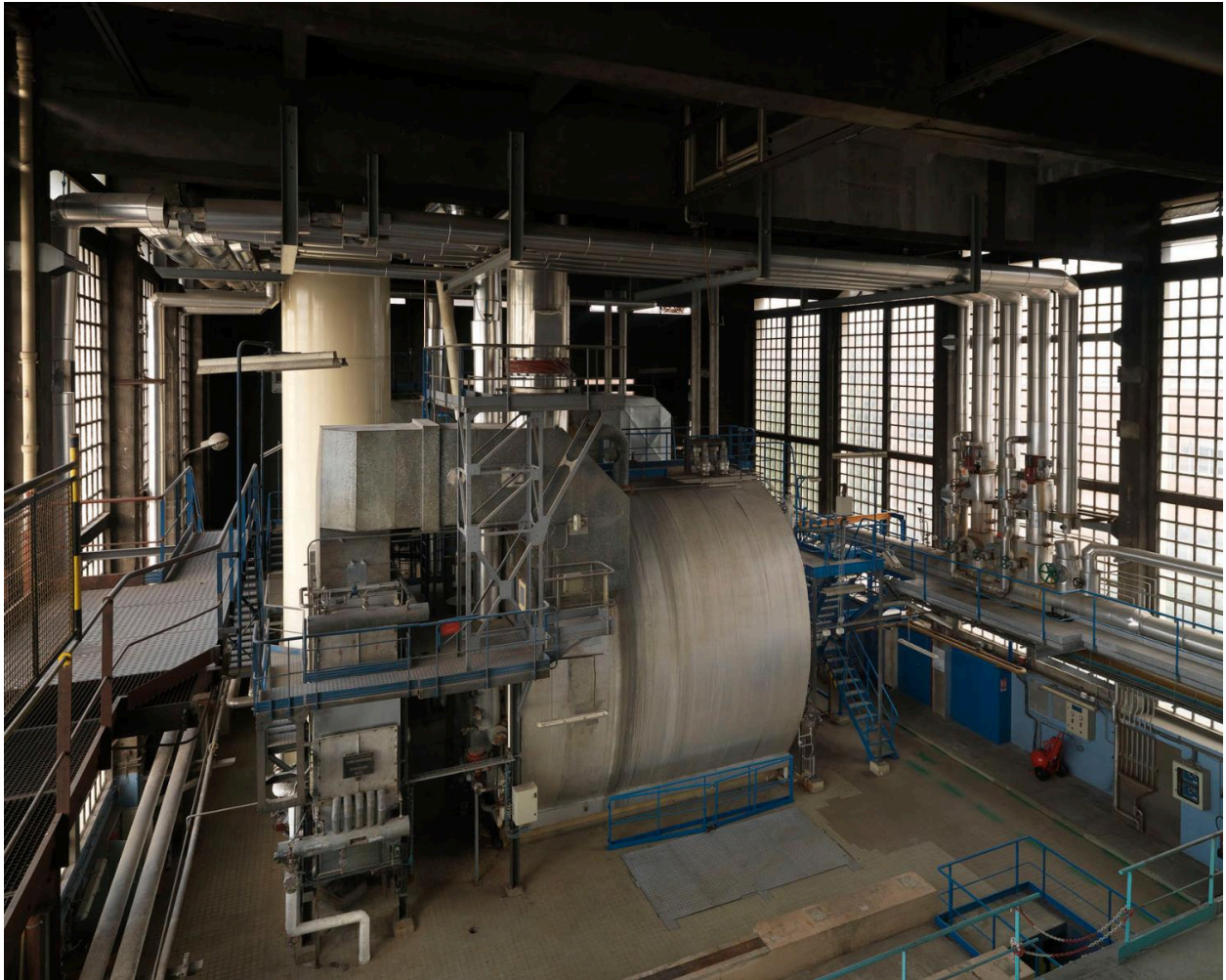
Site Sanofi. Vue intérieure bâtiment de la chaufferie.
