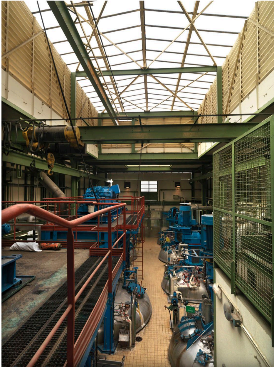
Site Sanofi. Bâtiment de transformation. Cuves.
