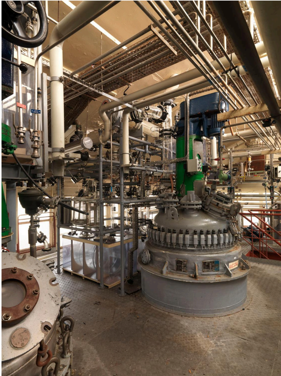
Site Biocitech, vue intérieure des équipements et machines.
