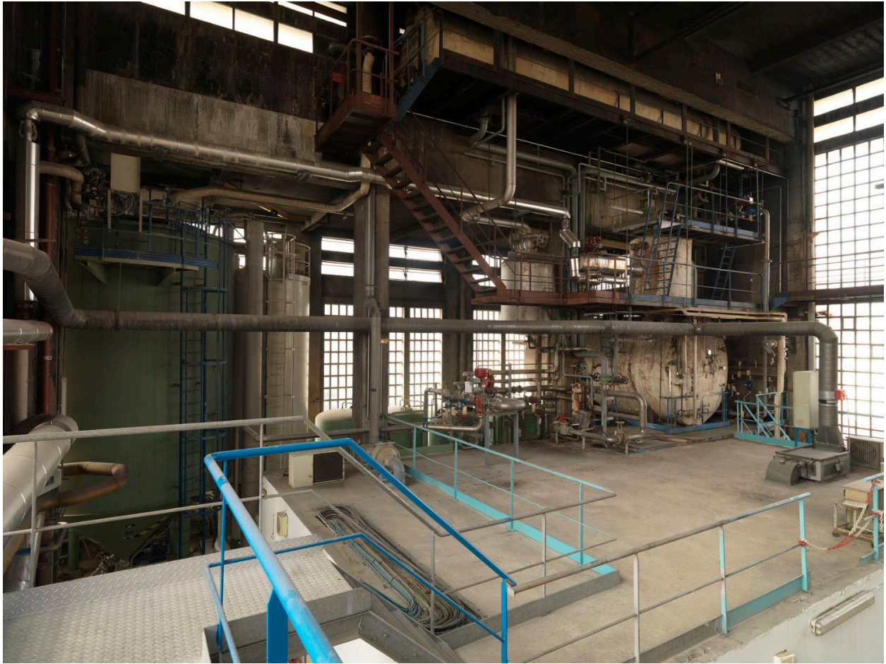
Site Sanofi. Vue intérieure du bâtiment de la chaufferie.
