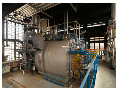
Site Sanofi. Vue intérieure bâtiment de la chaufferie. Phot. Laurent Kruszyk IVR11_20099300512NUC4A
