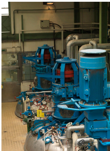
Site Sanofi. Bâtiment de transformation. Cuves. Phot. Laurent Kruszyk IVR11_20099300329NUC4A
