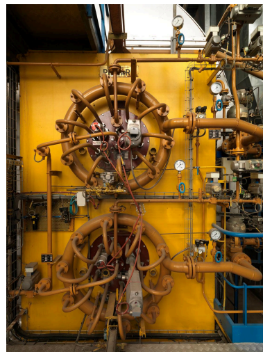
Site Sanofi. Vue intérieure bâtiment de la chaufferie. Détail. Phot. Laurent Kruszyk IVR11_20099300515NUC4A
