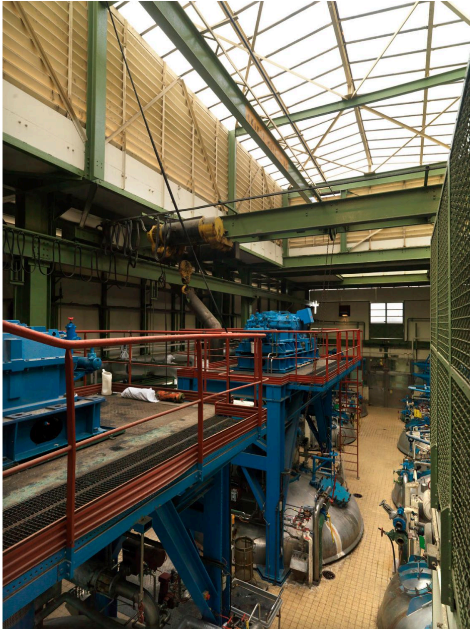
Site Sanofi. Bâtiment de transformation. Cuves.
