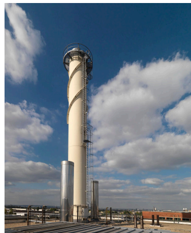
Site Sanofi. Vue de la cheminée, toit du bâtiment de la chaufferie. Phot. Laurent Kruszyk IVR11_20099300519NUC4A
