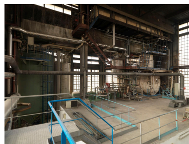
Site Sanofi. Vue intérieure du bâtiment de la chaufferie. Phot. Laurent Kruszyk IVR11_20099300520NUC4A
