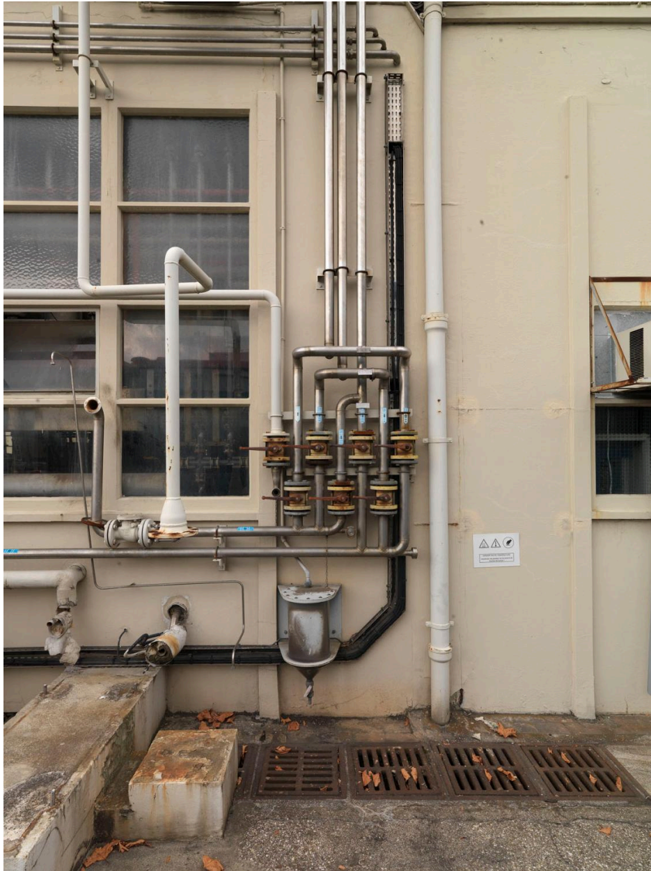
Site Biocitech, détail d'un équipement en façade.
