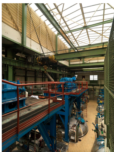
Site Sanofi. Bâtiment de transformation. Cuves.
