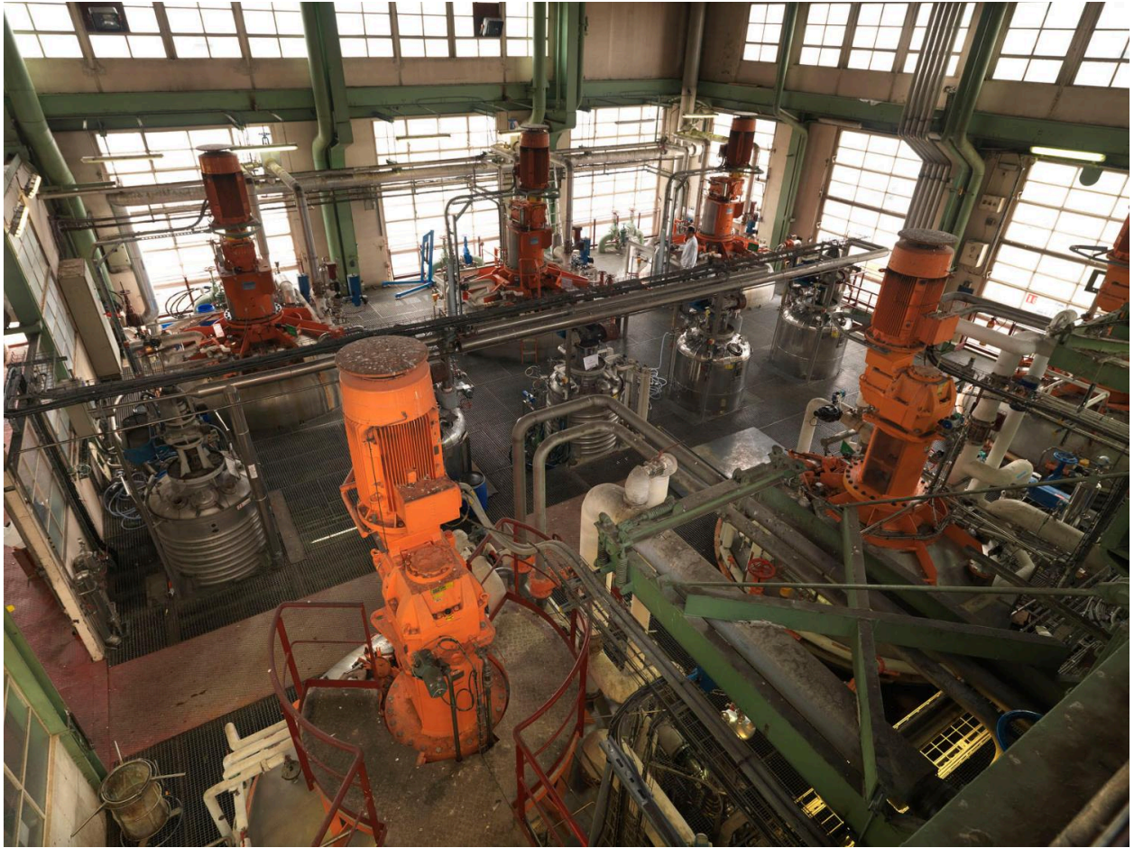
Site Sanofi. Bâtiment de transformation. Cuves.
