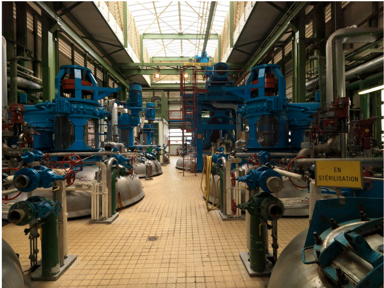
Site Sanofi. Bâtiment de transformation. Cuves.
