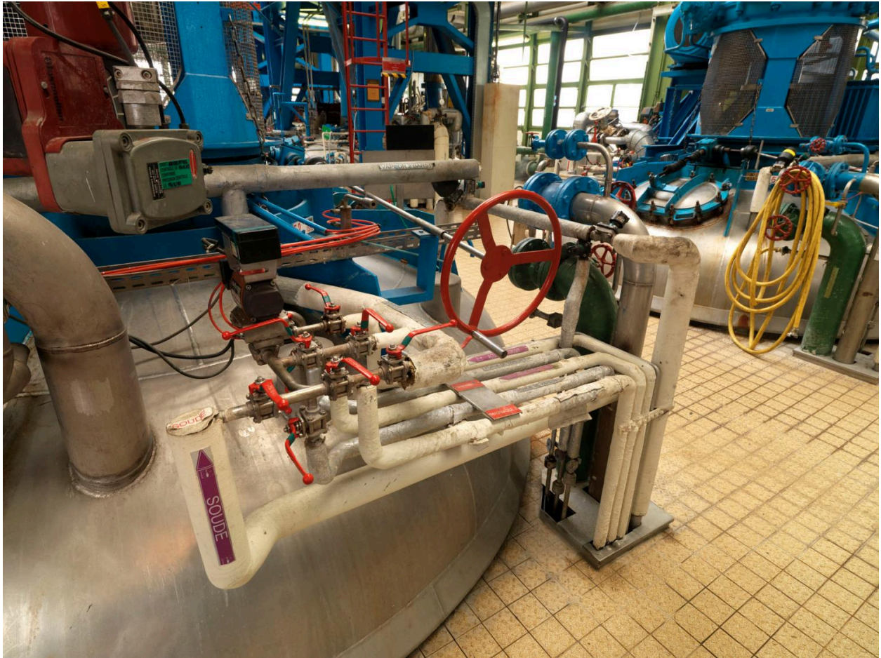
Site Sanofi. Bâtiment de transformation. Cuves.
