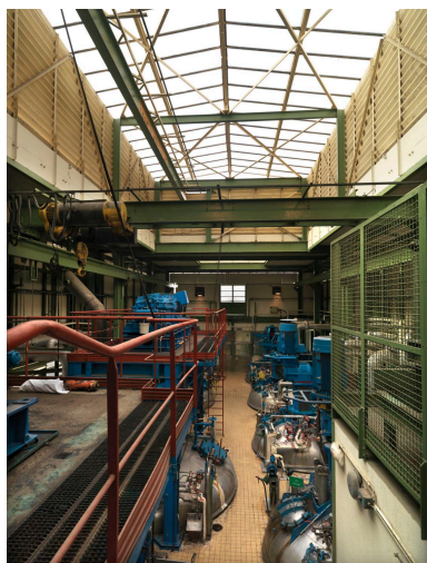
Site Sanofi. Bâtiment de transformation. Cuves. Phot. Laurent Kruszyk IVR11_20099300324NUC4A
