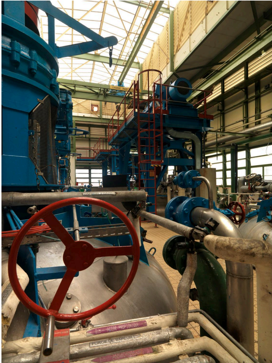
Site Sanofi. Bâtiment de transformation. Cuves.
