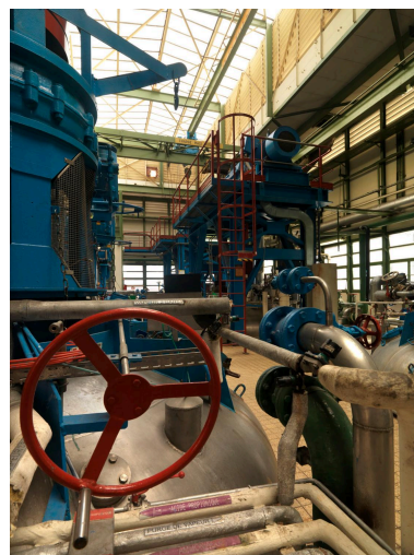
Site Sanofi. Bâtiment de transformation. Cuves. Phot. Laurent Kruszyk IVR11_20099300331NUC4A
