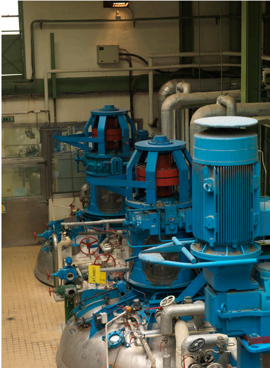
Site Sanofi. Bâtiment de transformation. Cuves.
