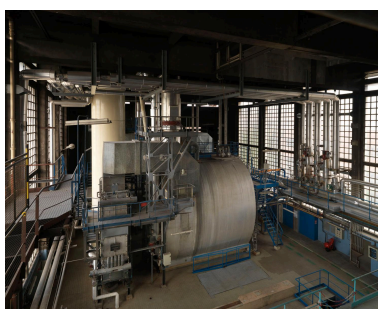
Site Sanofi. Vue intérieure bâtiment de la chaufferie. Phot. Laurent Kruszyk IVR11_20099300513NUC4A
