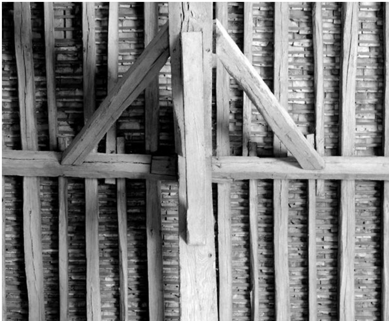
La grange, charpente : détail d'assemblage des pannes intermédiaires et contreventements. Assemblage des pannes en sifflet avec chevilles.
