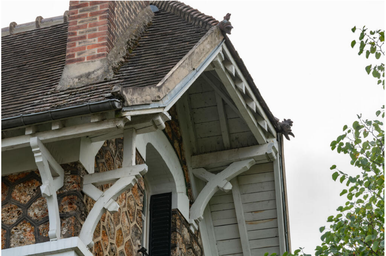
Détail de la demi-croupe de la toiture : aisseliers charpentés et têtes de coqs ornementales
