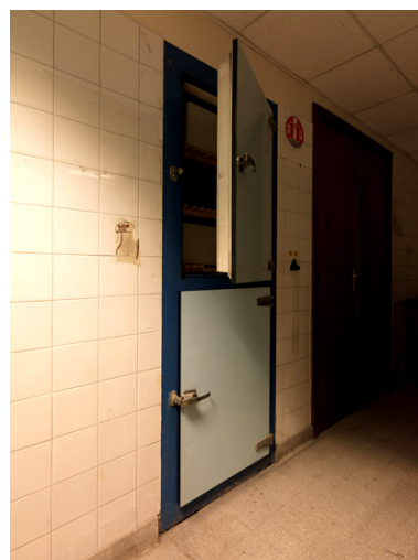
Les placards réfrigérés des cuisines. Phot. Philippe Ayrault IVR11_20159500055NUC4A
