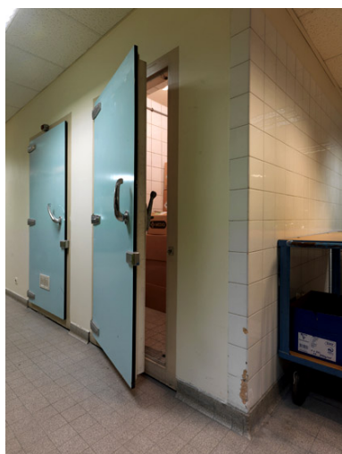
Les chambres froides des cuisines. Phot. Philippe Ayrault IVR11_20159500053NUC4A
