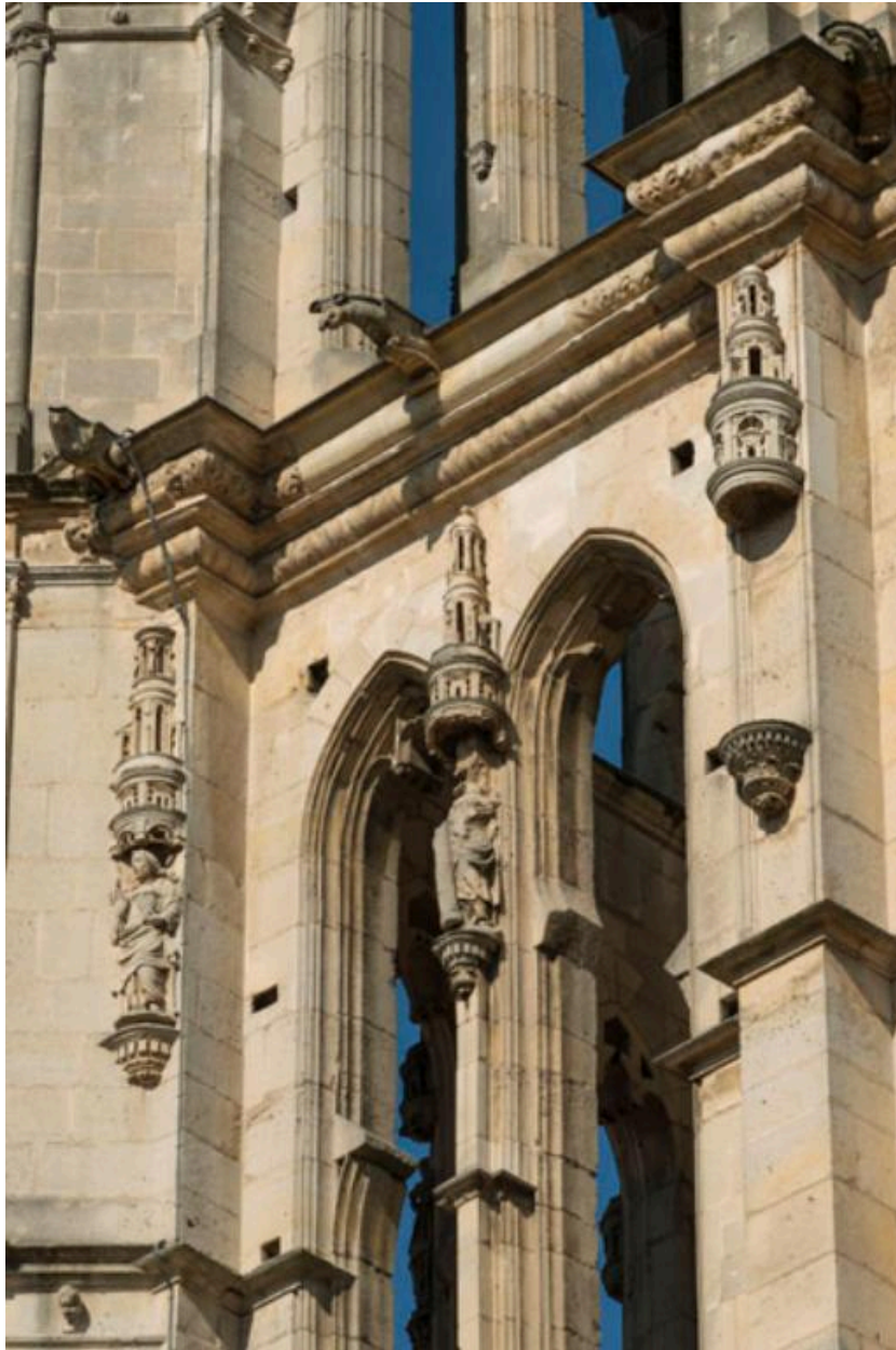
Détail des sculptures du deuxième étage. Elles sont manquantes, restaurées ou incomplètes.
