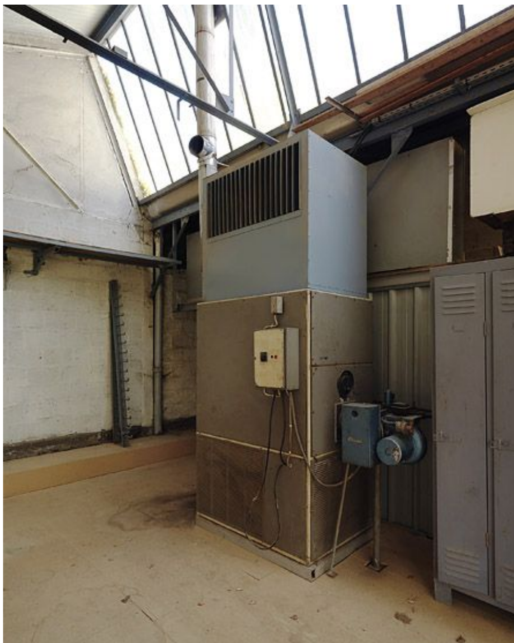
Atelier de fabrication, appareil de chauffage a air.
