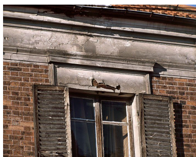
Détail de la mise en oeuvre des décors d'enduit d'une maison, 33 rue du Val de Beauté. IVR11_20059400169XA
