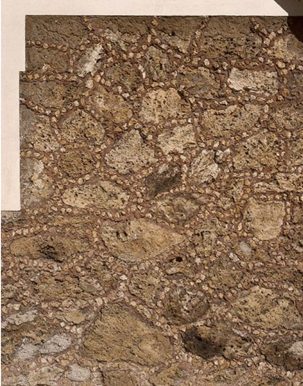
Détail de la mise en oeuvre de la meulière rocaillées en soubassement d'une maison, 8 rue des Défenseurs de Verdun.
