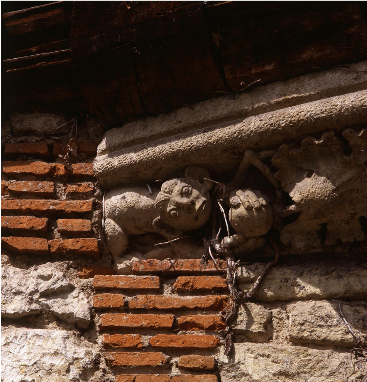
Détail de la frise sculptée de motifs animaliers ornant la corniche située en dessous de l'étage en léger surplomb, à droite du corps du bâtiment principal.
