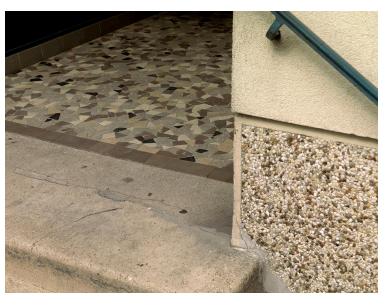
Cité du Foyer des Invalides et des Anciens Combattants. Détail du décor (pavement et soubassement). IVR11_20109300156NUC4A
