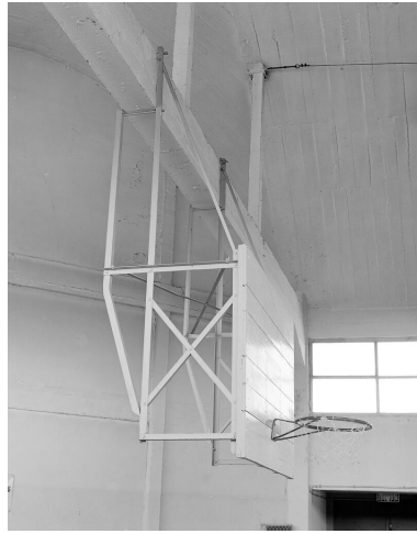
Détail d'un panier de basketball du gymnase. Stade Jack-Baudequin Phot. Décamps Christian IVR11_19869400594X
