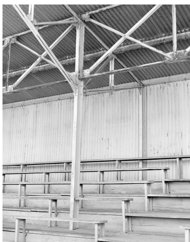
Détail des gradins en bois et de la charpente métallique des tribunes. Stade Jack-Baudequin Phot. Décamps Christian IVR11_19869400590X
