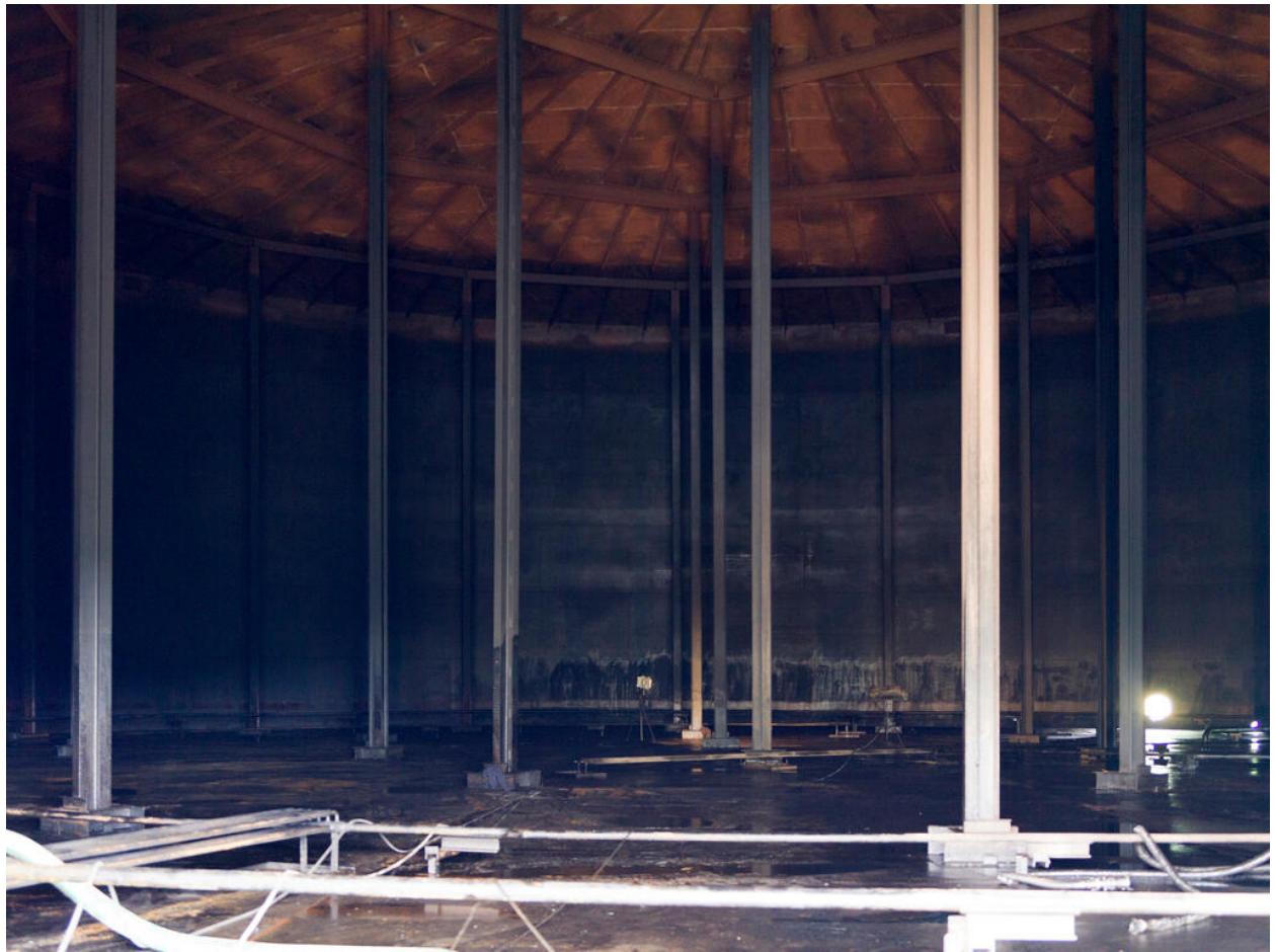
Zone 320, Mouvement de produits. Bac "sur béquilles", qui permettent de tenir le toit flottant quand le bac est vide, en cours de nettoyage.
