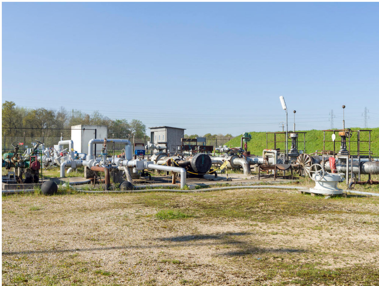
Arrivée du pipe (Unité 560). Réceptacle d'arrivée des racleurs de nettoyage.
