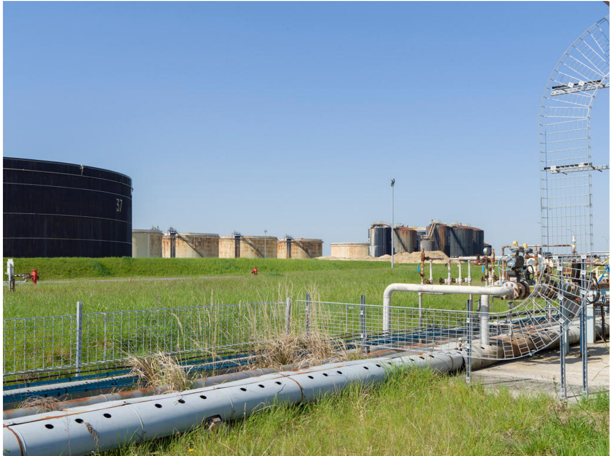
Zone 320, Mouvement de produits. Vue sur les bacs de bitume, à droite. Au premier plan, pipeway et chemin de câbles.
