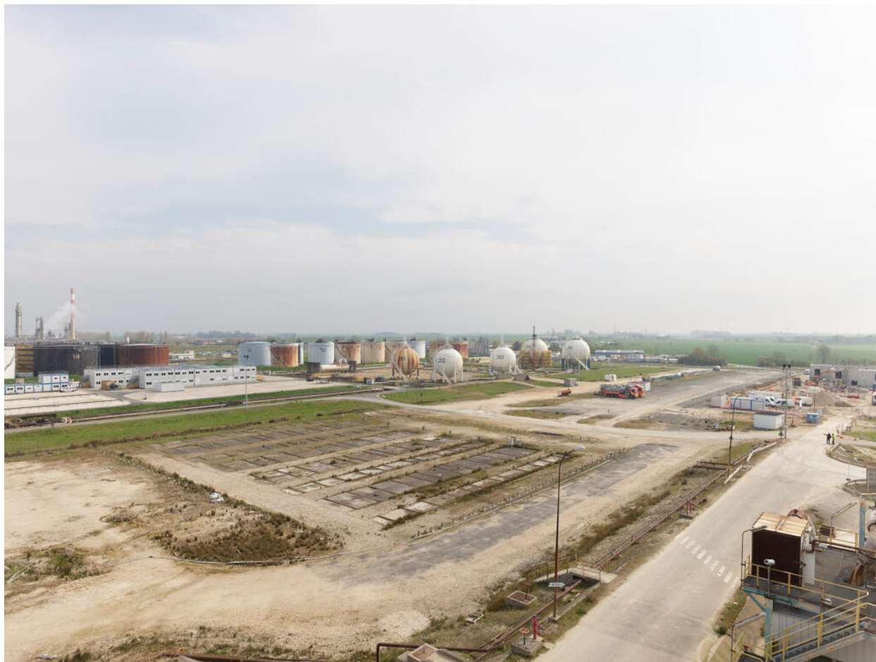
Vue de la construction du projet pyrolyse, au fond à droite, depuis le troisième étage du FCC.
