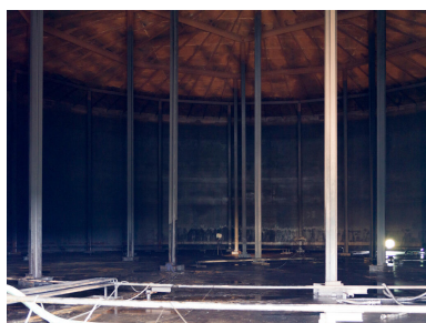
Zone 320, Mouvement de produits. Bac "sur béquilles", qui permettent de tenir le toit flottant quand le bac est vide, en cours de nettoyage.
