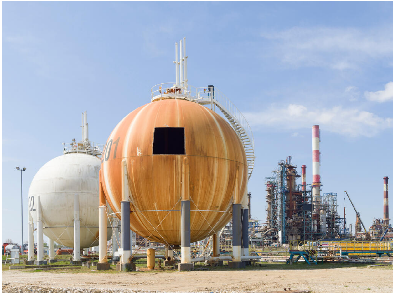
Zone 320, Mouvement de produits. Vue sur la sphère de stockage de gaz D 201 depuis le sommet de la sphère D 202. Une première "fenêtre" a été ouverte au chalumeau, en vue de son démantèlement.
