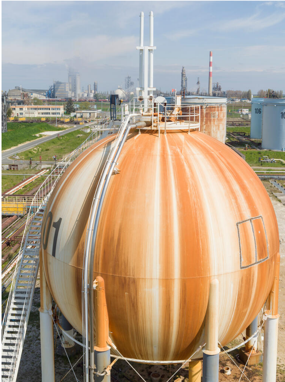
Zone 320, Mouvement de produits. Vue sur la sphère de stockage de gaz D 201 depuis le sommet de la sphère D 202. Une première "fenêtre" a été ouverte au chalumeau, en vue de son démantèlement.
