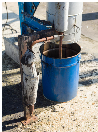
Zone bitume (Unité 570). Quais de chargement bitume. Bras motorisé chargement bitume. Phot. Stéphane Asseline, Phot. Stéphane Asseline IVR11_20237700334NUC4A
