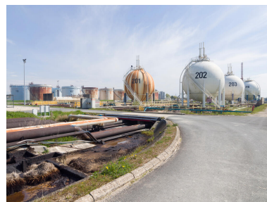
Zone 320, Mouvement de produits. Vue sur la zone des sphères de stockage de gaz. Phot. Stéphane Asseline, Phot. Stéphane Asseline IVR11_20237700315NUC4A
