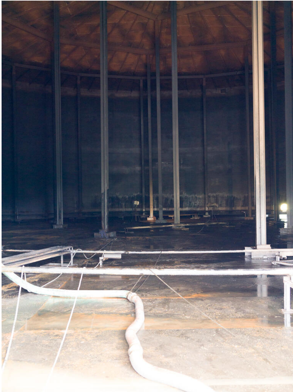
Zone 320, Mouvement de produits. Bac "sur béquilles", qui permettent de tenir le toit flottant quand le bac est vide, en cours de nettoyage.
