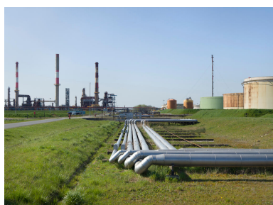
À droite, Unités Ouest (trois cheminées). Au premier plan, un pipeway (lyre de dilatation).
