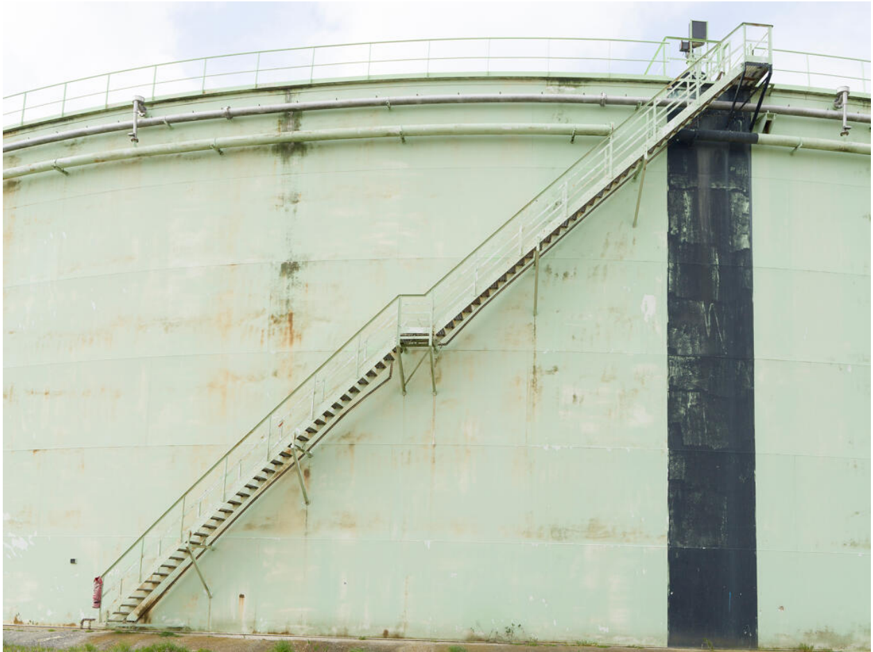
Zone 320, Mouvement de produits. Escalier menant sur le toit du bac D 79.
