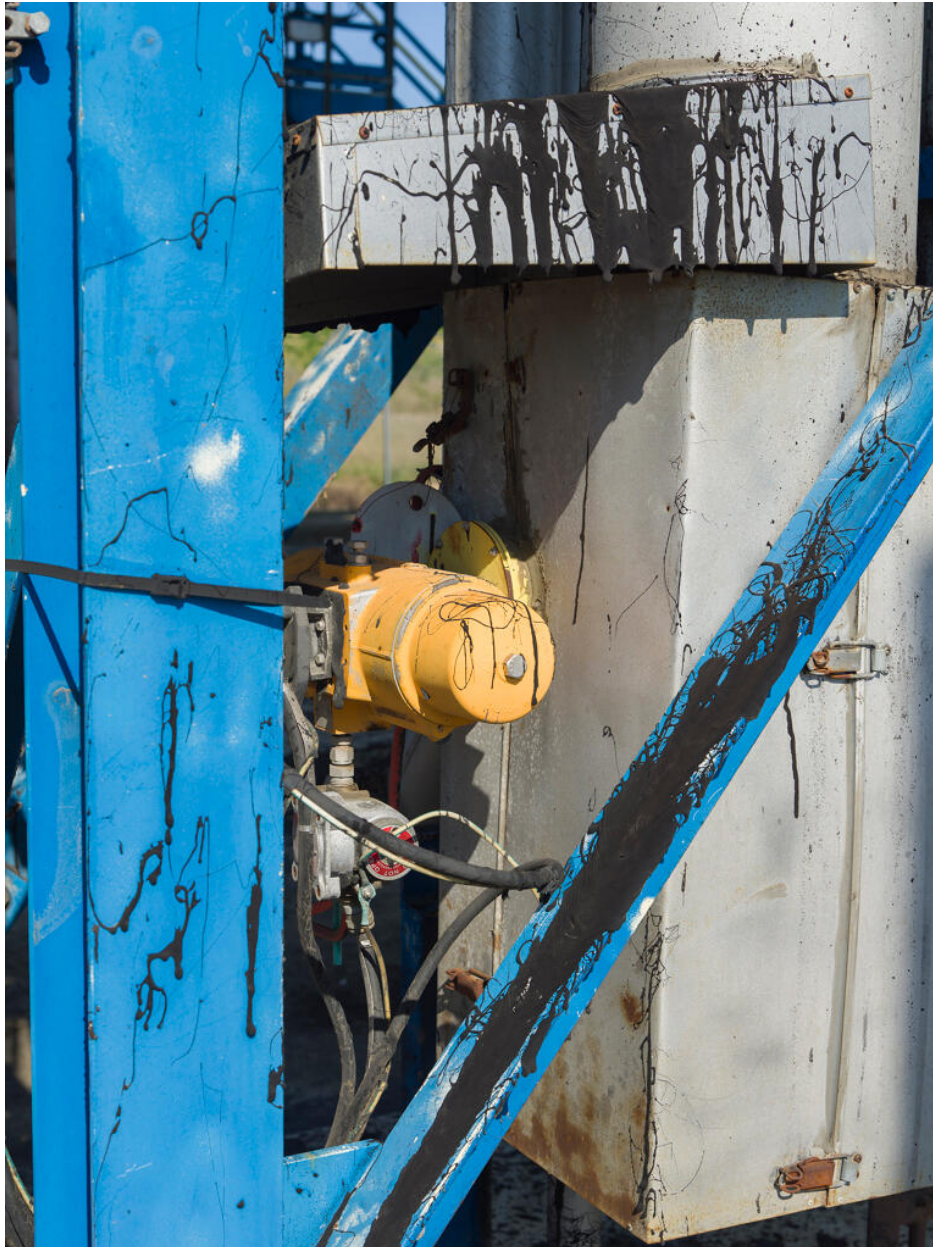
Zone bitume (Unité 570). Quais de chargement bitume. Vanne automatique pour prise d'échantillon bitume.
