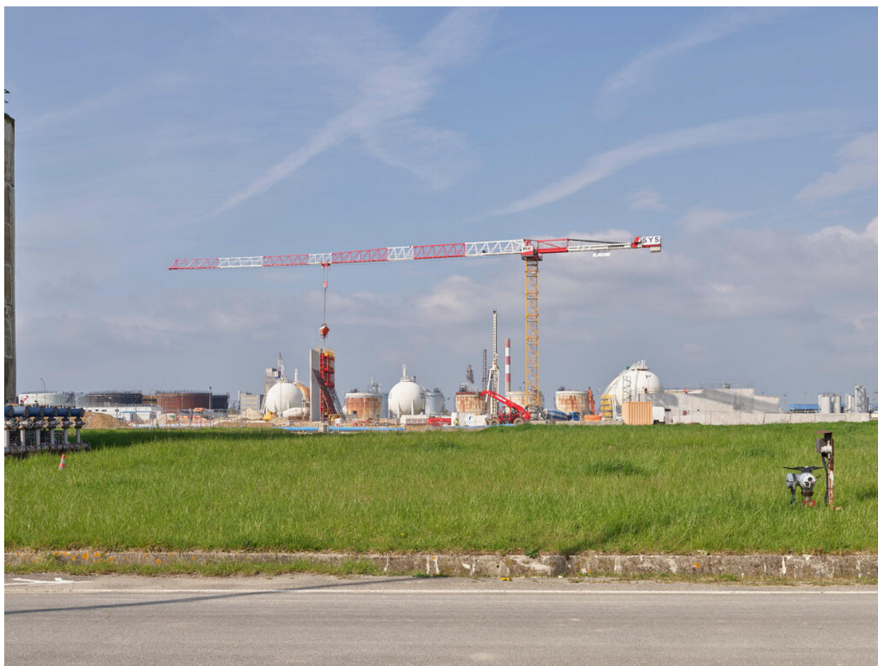
Vue générale de la zone du projet pyrolyse en chantier, depuis la zone du traitement des eaux.
