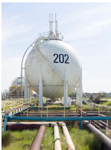
Zone 320, Mouvement de produits. Vue sur la sphère de stockage de gaz D 202. Phot. Stéphane Asseline, Phot. Stéphane Asseline IVR11_20237700317NUC4A
