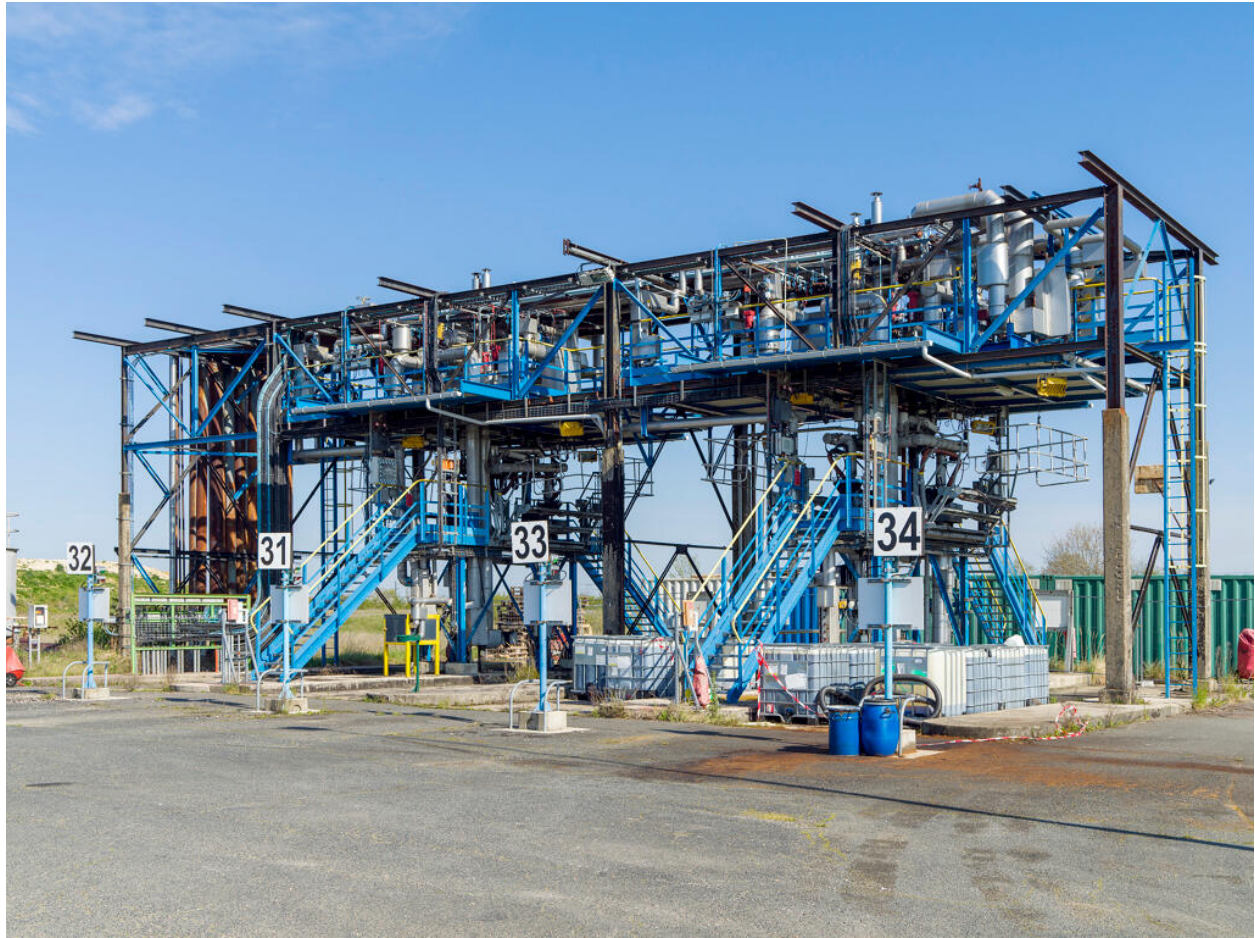
Zone bitume (Unité 570). Quais de chargement bitume.
