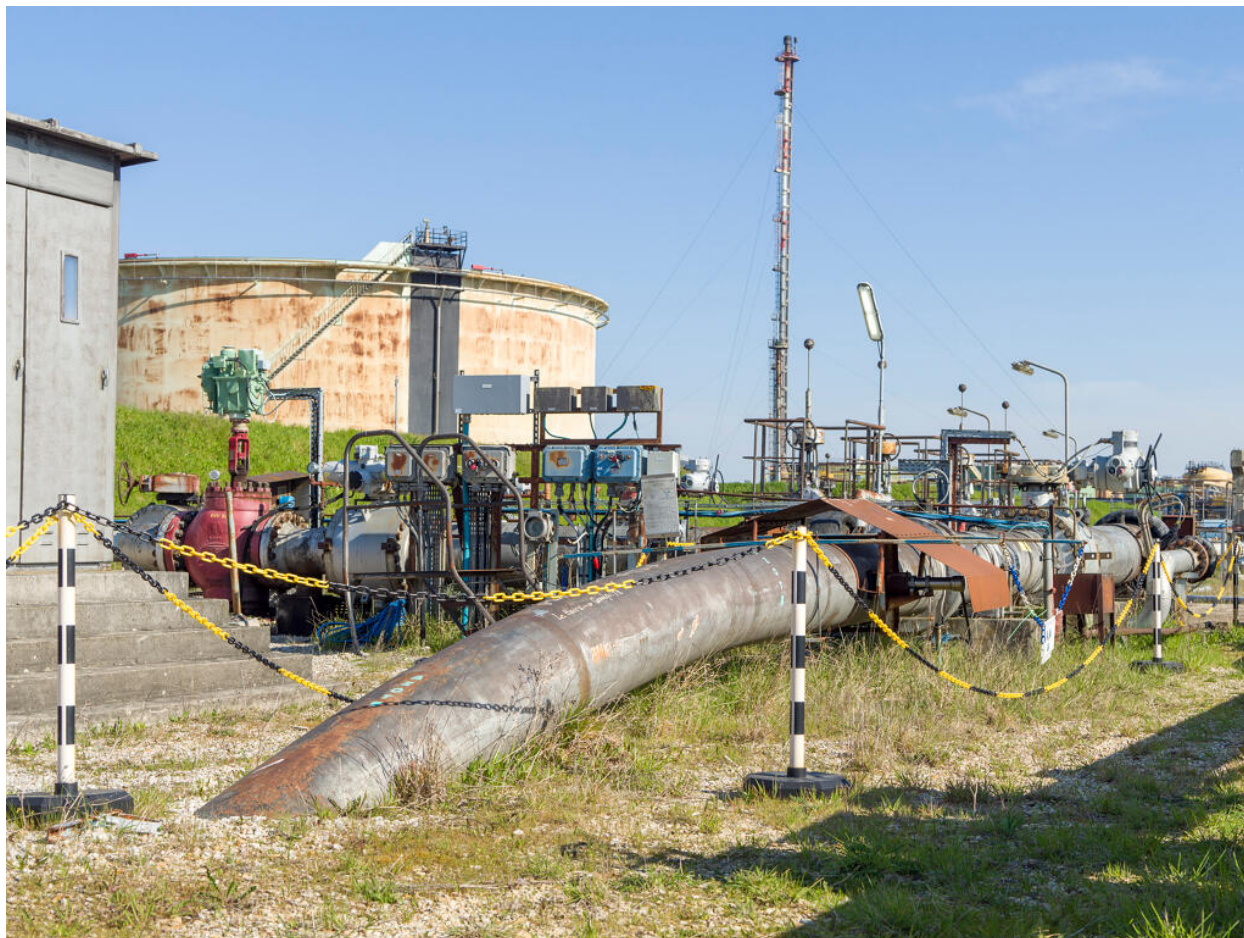
Arrivée du pipe (Unité 560). Arrivée du pipeline d'Île-de-France sur le site de Grandpuits. Fin d'exploitation en 2021.
