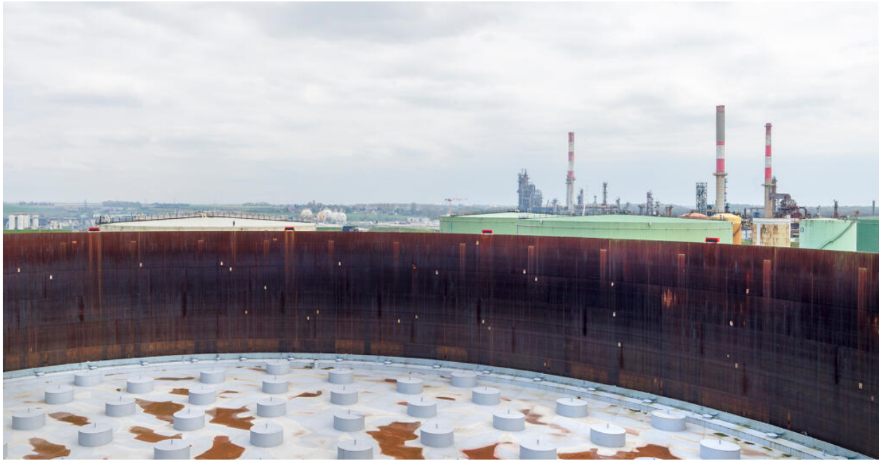
Zone 320, Mouvement de produits. Au premier plan, toit flottant du bac D 75. Au fond à droite, les unités de production.
