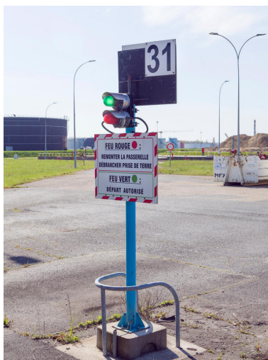
Zone bitume (Unité 570). Signalétique de mise à la terre des véhicules pendant leur chargement. Phot. Stéphane Asseline, Phot. Stéphane Asseline IVR11_20237700336NUC4A
