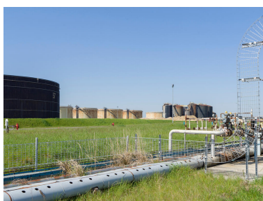
Zone 320, Mouvement de produits. Vue sur les bacs de bitume, à droite. Au premier plan, pipeway et chemin de câbles.
