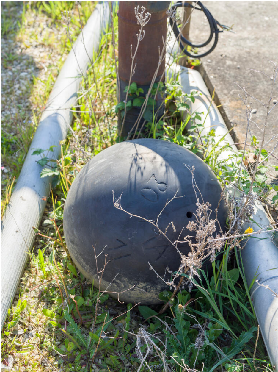
Arrivée du pipe (Unité 560). Sphères de protection de racleurs instrumentés.
