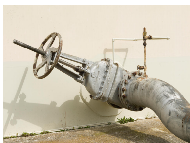
Zone 320, Mouvement de produits. Vanne de "pied de bac " sur le bac D 75. Cette vanne, de 18 pouces (environ 45 cm), sert d'entrée et de sortie pour le fluide contenu dans le bac. Au-dessus de la vanne, une soupape de sécurité.
