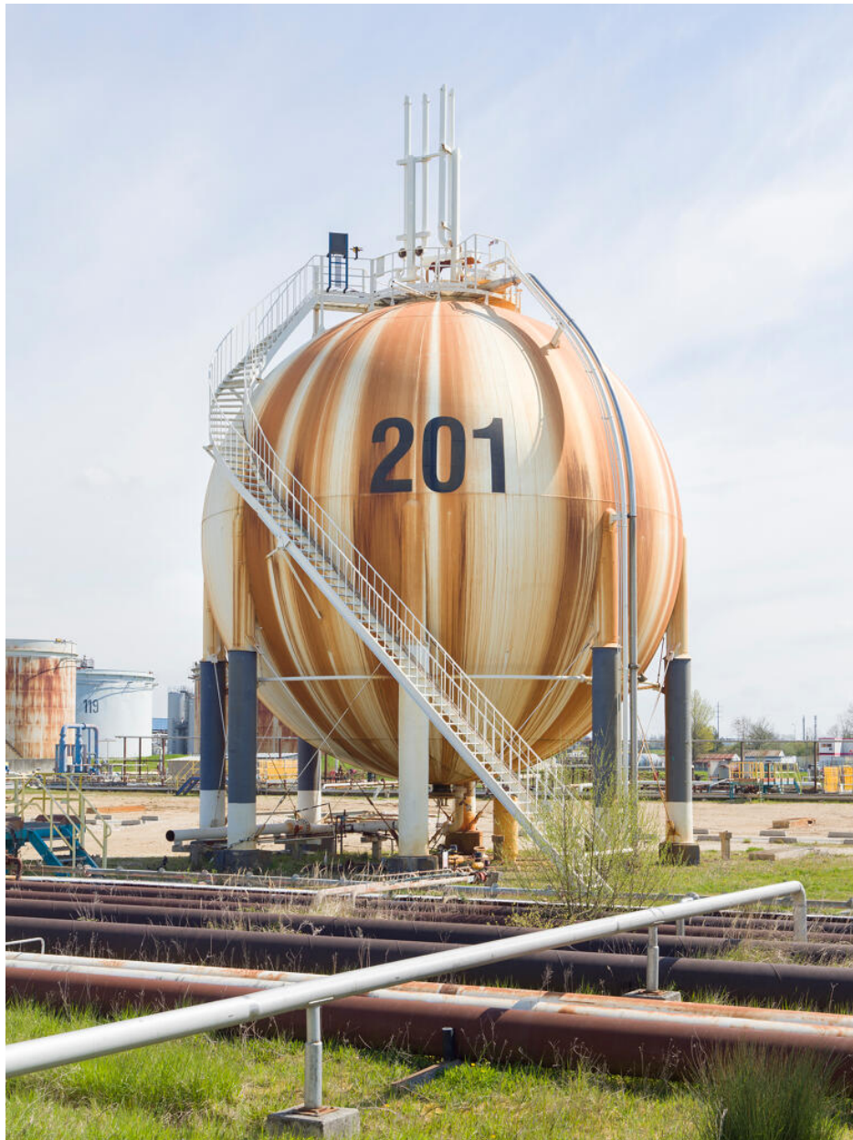
Zone 320, Mouvement de produits. Vue sur la sphère de stockage de gaz D 201. Cette sphère ne sera pas conservée.
