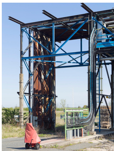
Zone bitume (Unité 570). Quais de chargement bitume. Ligne d'arrivée bitume. Prise d'échantillon bitume. Égouttures du bras de chargement bitume (envoi à la destruction, déchets pétroliers). Phot. Stéphane Asseline, Phot. Stéphane Asseline IVR11_20237700332NUC4A
