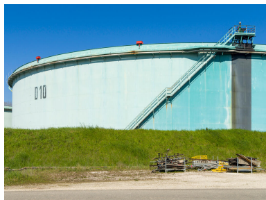
Zone 320, Mouvement de produits. Vue sur le bac de pétrole brut D 10, un des plus gros bacs de stockage (60 000 m 3 )
