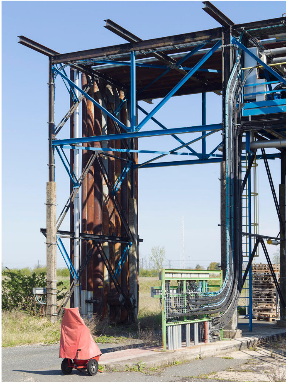
Zone bitume (Unité 570). Quais de chargement bitume. Ligne d'arrivée bitume. Prise d'échantillon bitume. Égouttures du bras de chargement bitume (envoi à la destruction, déchets pétroliers).
