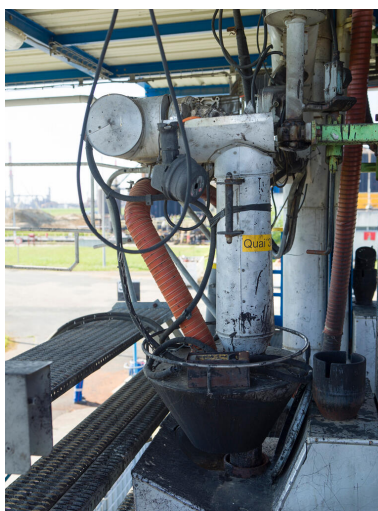
Zone bitume (Unité 570). Quais de chargement bitume. Bras motorisé chargement bitume. Phot. Stéphane Asseline, Phot. Stéphane Asseline IVR11_20237700333NUC4A
