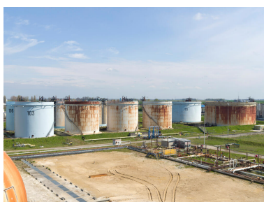
Zone 320, Mouvement de produits. Vue sur les bacs de stockage depuis une sphère D 202 (stockage de GPL).
