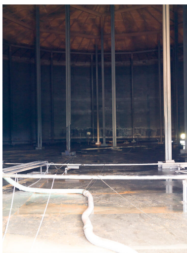
Zone 320, Mouvement de produits. Bac "sur béquilles", qui permettent de tenir le toit flottant quand le bac est vide, en cours de nettoyage.
