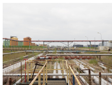
À l'ouest des Unités Ouest. Au premier plan, pipeway destiné à la distribution de différentes qualités de GPL vers le stockage. Au fond, ligne de torches (pour combustion des gaz résiduels) sur structure métallique.
