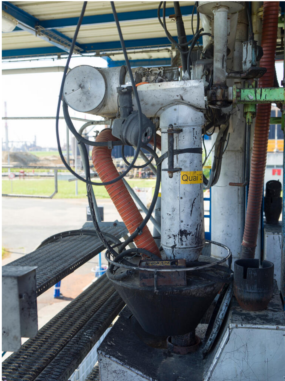
Zone bitume (Unité 570). Quais de chargement bitume. Bras motorisé chargement bitume.
