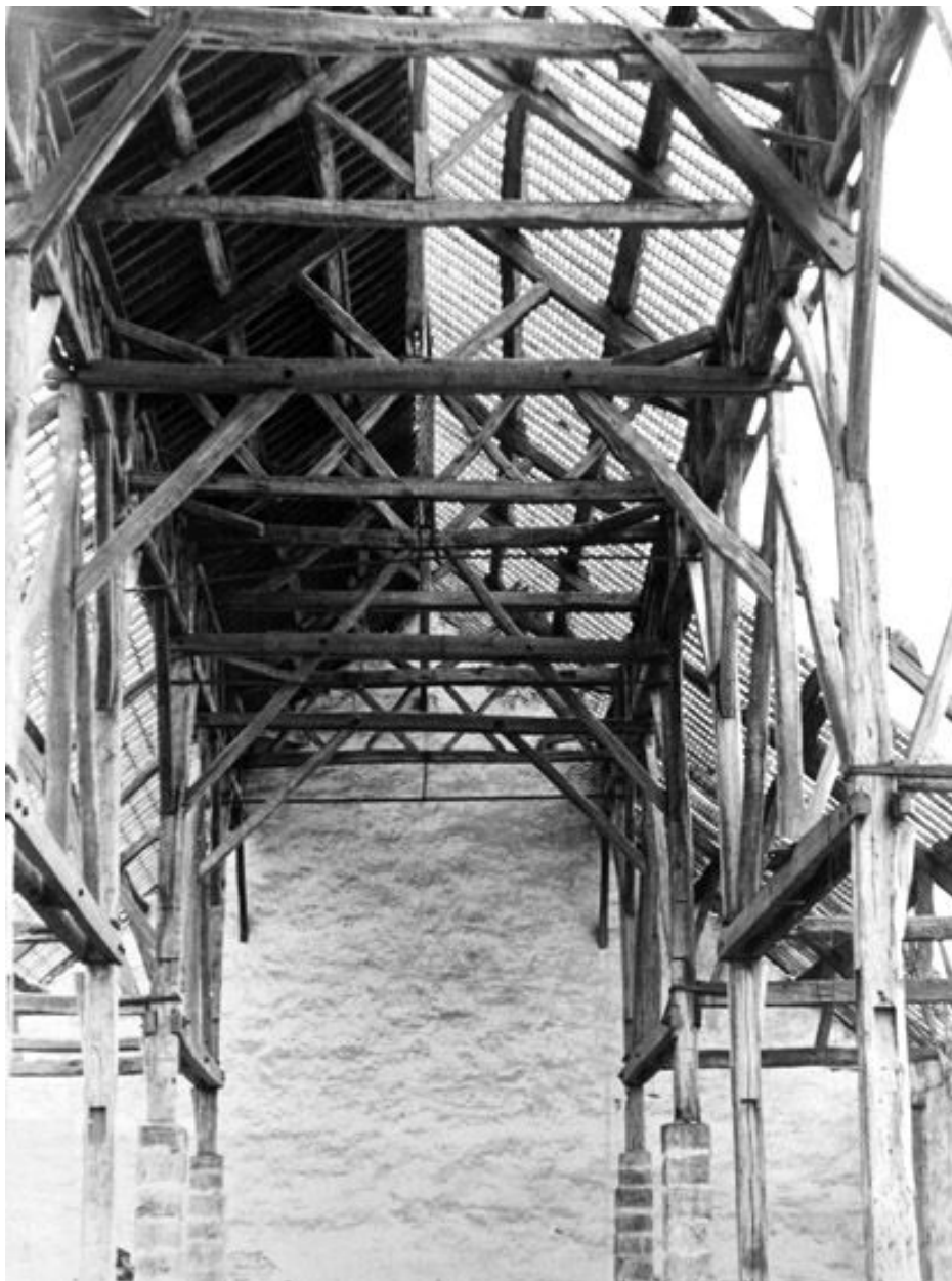
La manutention militaire en cours de démolition : vue de la charpente. Photographie. (Musée municipal de Melun)
