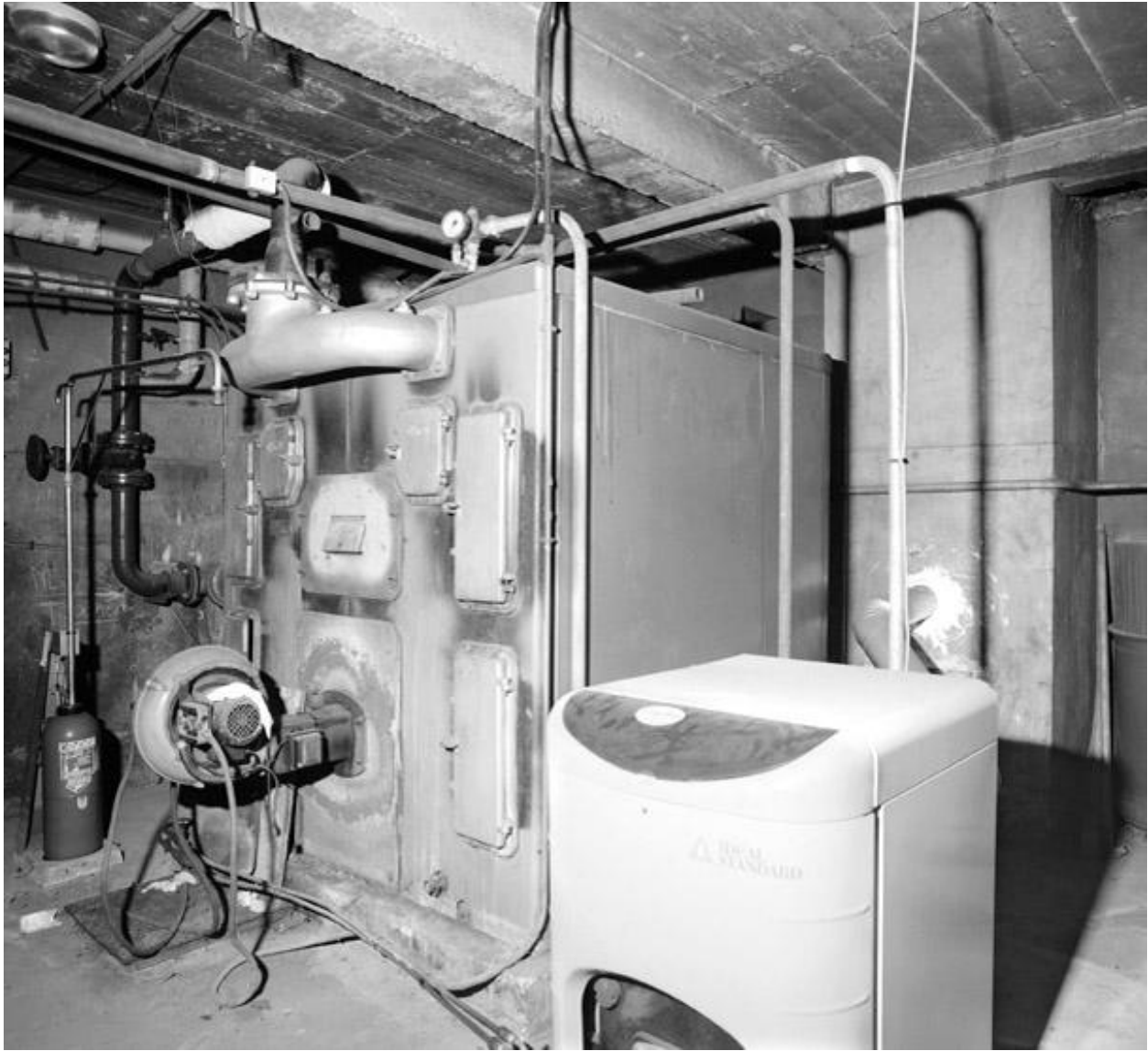
Intérieur de la chaufferie.
