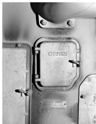
Marque du fabricant et plaque signalétique, sur la paroi frontale de la chaudière. IVR11_20059300086X
